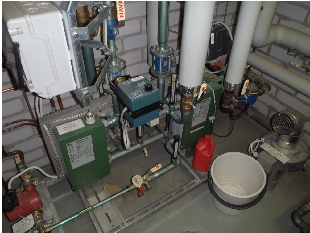
LVI- kuva 1. Yleiskuva lämmönjakohuoneesta.
