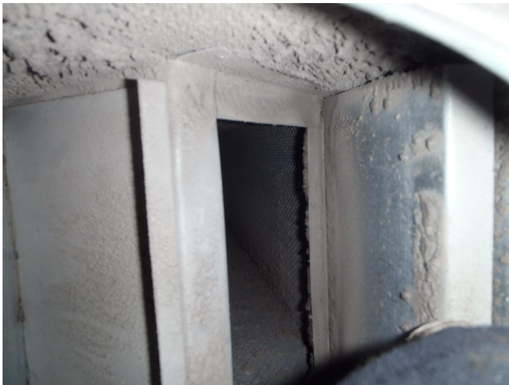
LVI- kuva 11. Yleiskuva poistoilmakanavasta.
