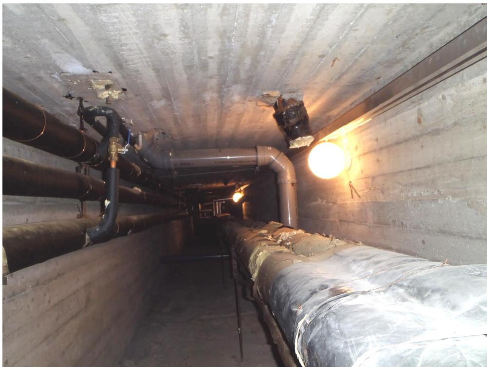
LVI-kuva 4. Yleiskuva päiväkodin putkikuilusta.
