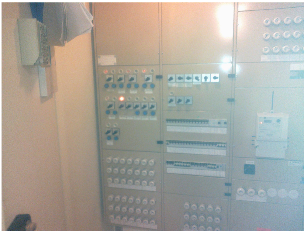
S- kuva 1. Pääkeskuksen huolto olisi suositeltavaa suorittaa tarkastelujakson aikana.
