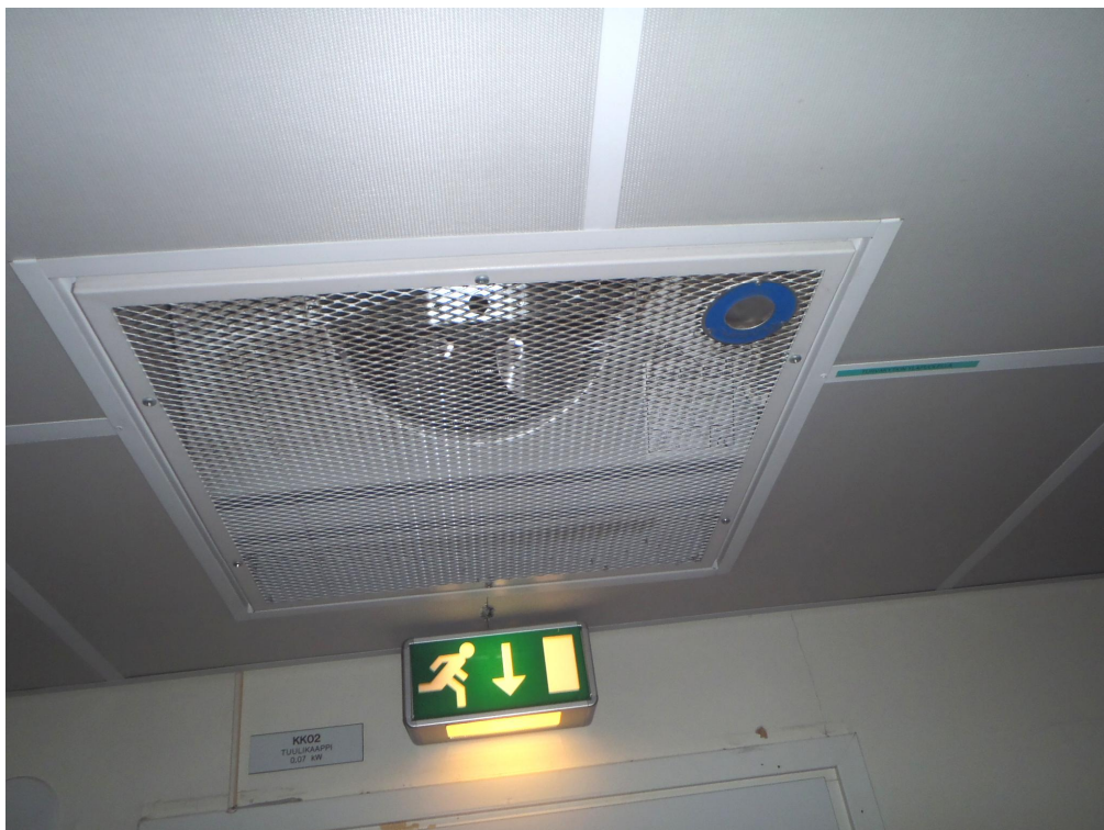
LVI- kuva 2. Yleiskuva tuulikaapin kiertoilmakoneesta.
