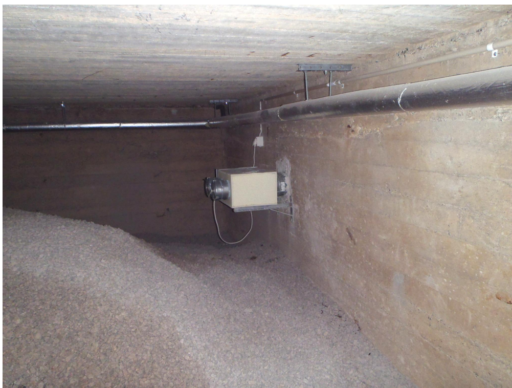
LVI- kuva 8. Yleiskuva päiväkodin alustatilan ilmanvaihdosta.
