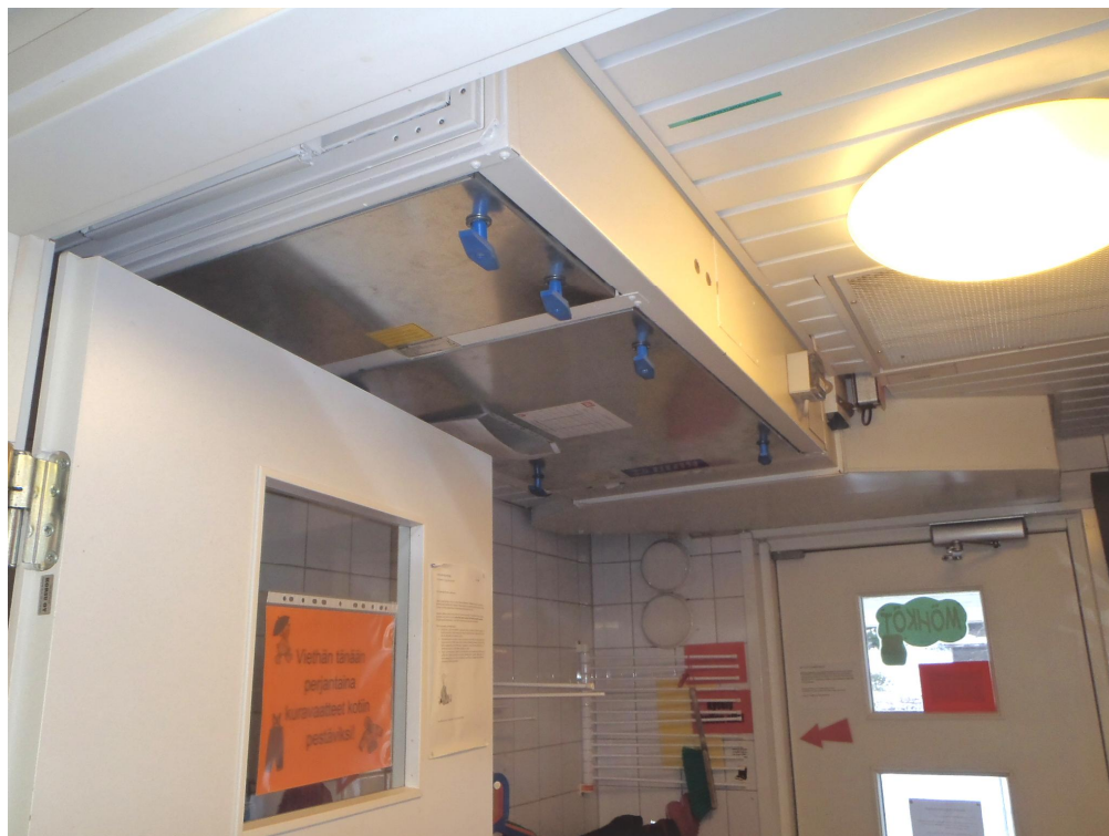
LVI- kuva 9. Yleiskuva päiväkodin tuloilmakoneesta.
