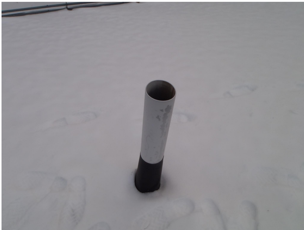
LVI- kuva 7. Viemäreiden tuuletusputket ovat pääosin eristämättä vesikatolla.
