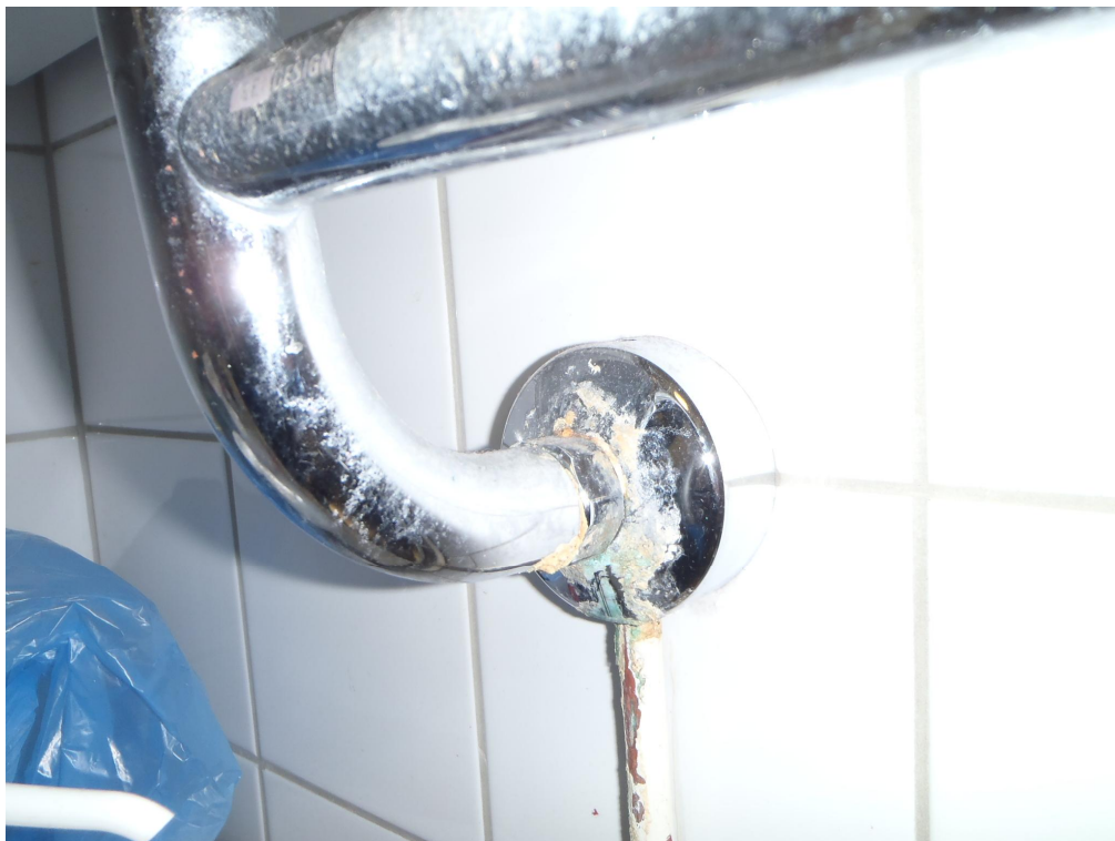
LVI- kuva 6. Siivouskomeron ns. räppipatterissa on vanhoja vuotojälkiä.
