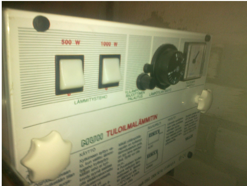
S- kuva 2. Laitteistojen sähköistys on tyydyttävässä kunnossa.
