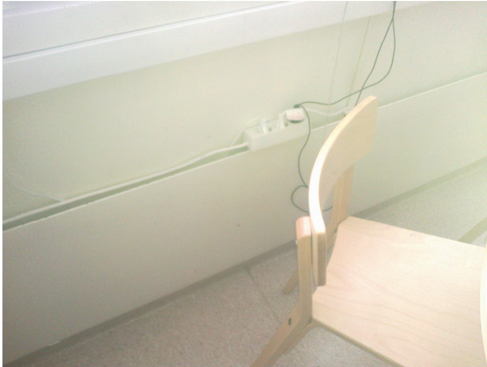
S- kuva 4. Jatkopistorasioiden sijoittamista pattereiden päälle tulisi välttää (ylikuumentuminen).
