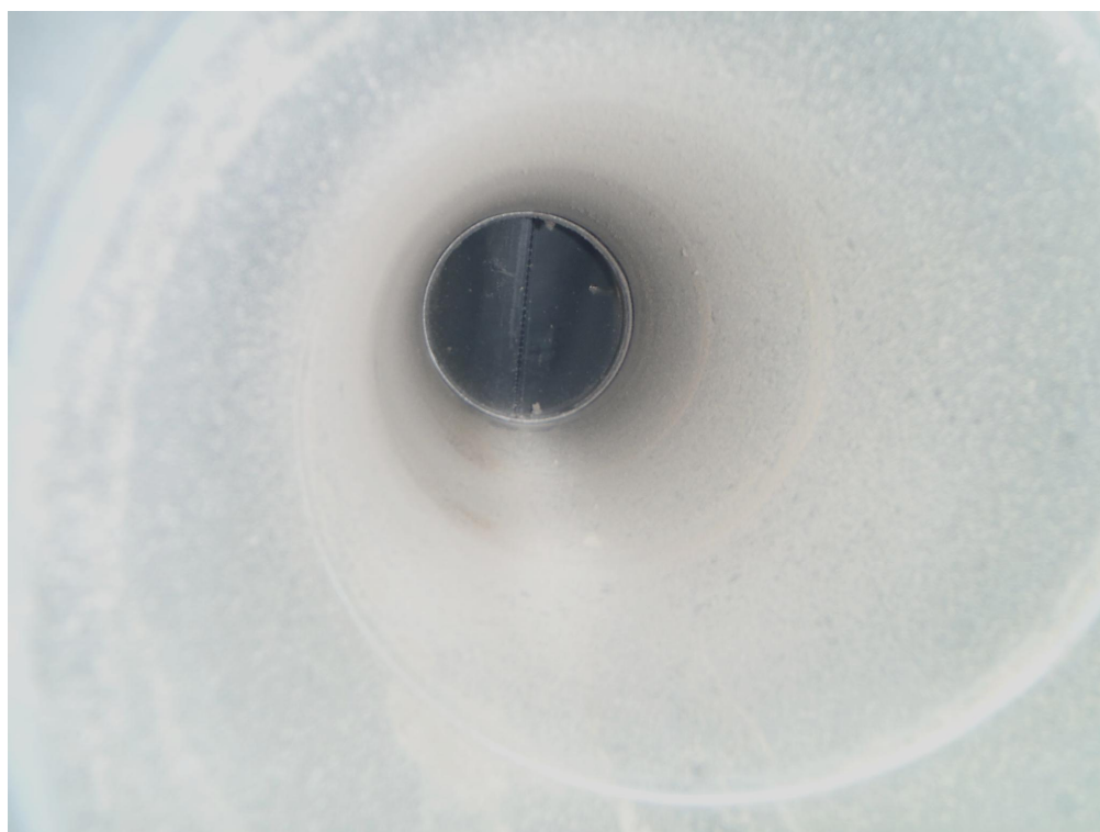
LVI- kuva 10. Yleiskuva WC:n poistoilmakanavasta.
