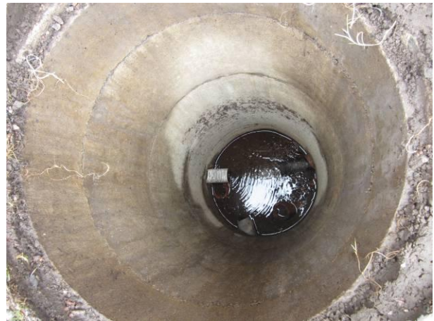
Kuva 2 Salaojan tarkastuskaivo/ perusvesikaivo.
