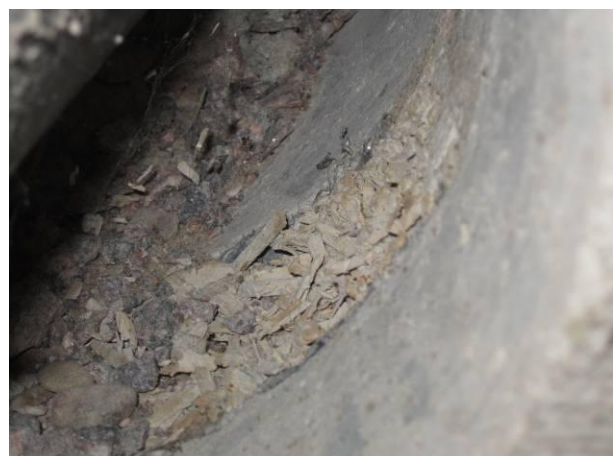
Kuva 22 Perusmuurin läpi tehtyä putkiläpivientiä ei ole tiivistetty. Perusmuurissa on Toja-levystä tehty sokkelihalkaisu.
