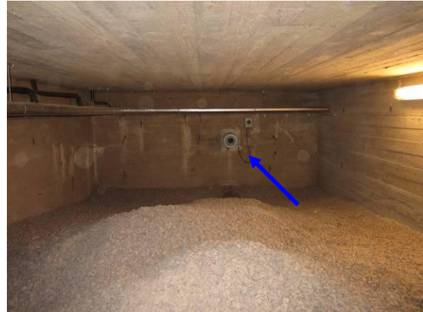
Kuva 4 Poistopuhallin rakennuksen leikkihihapäädystä Monitoimitila 04 alla.
