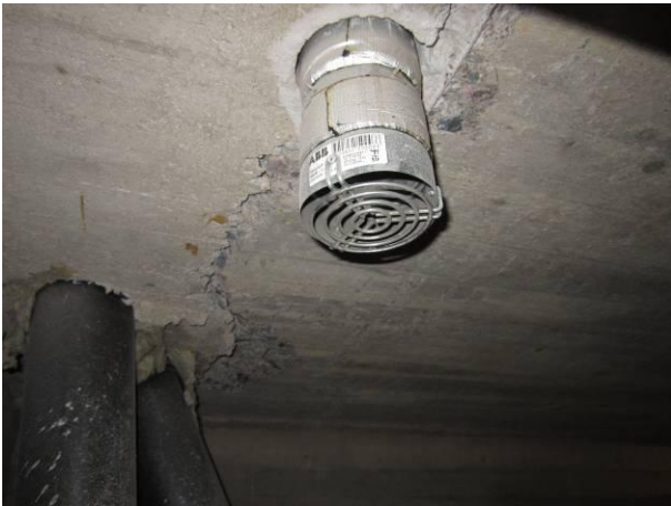
Kuva 5 Teknisestä tilasta lähtevästä putkesta puhalsi lämmintä ilmaa alustatilaan.
