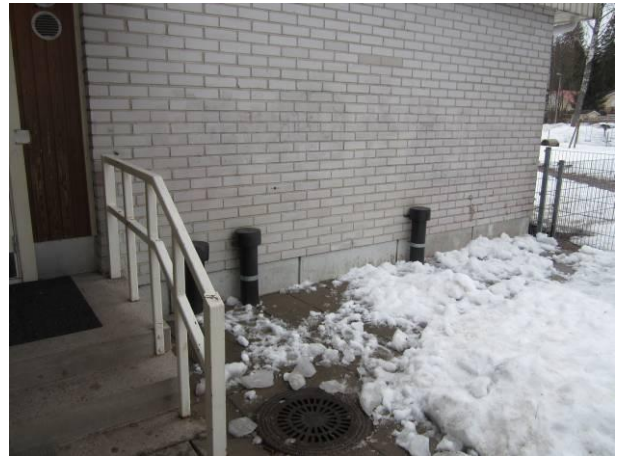
Kuva 6 Leikkihihapäädyn monitoimitilan 04 kohdalla olevat alustatilan ilmanvaihtoputket
