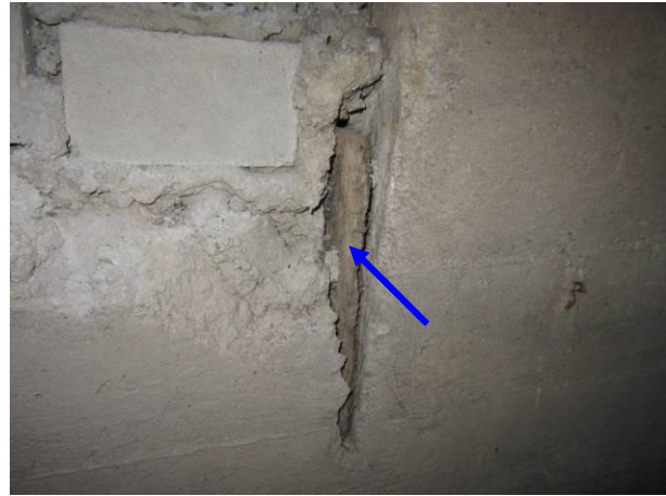
Kuva 14 Perusmuurin paikkauskohtaan jäänyt puu-/ levy pala.
