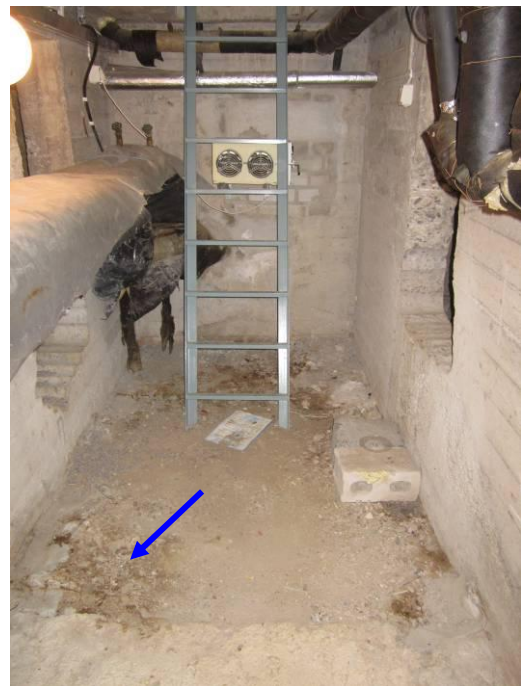
Kuva 12 Putkitunneli varaston 22 alla, josta on kulkuluukku. Molemmilta sivuilta on kulkuaukot sivuonteloihin, mikrobikasvua.
