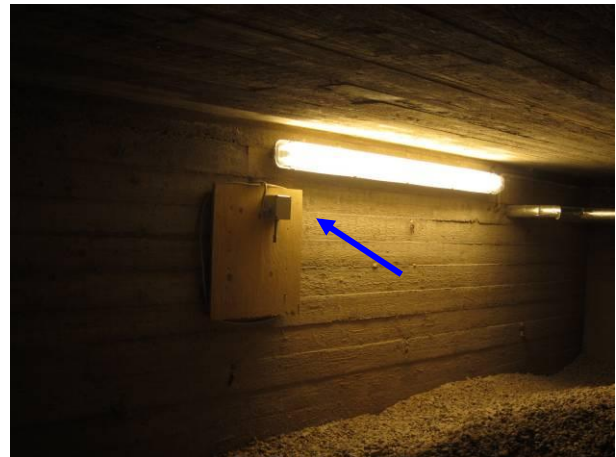
Kuva 20 Ontelotilaa 01 alla, seinällä on mittausanturi, joka liittyyneen ilmanvaihtoon.
