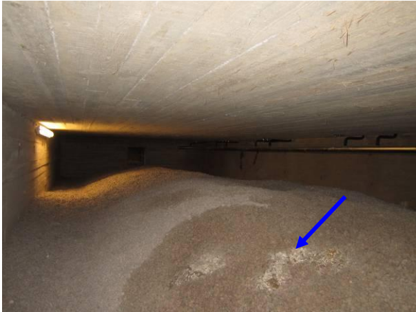
Kuva 17 Ontelotilaa tilojen 14 ja 24 alla, mikrobikasvustoa ja kosteuden aiheuttamaa tummumaa sepelissä.
