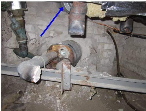
Kuva 11 Putkikanaali jatkuu talon ulkopuolelle, putkien alta pilkottaa poistopuhallin. Vanhoja putkiasennuksia.
