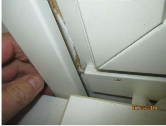
8. karmivälissä uretaania, ei muuta tiivistystä
