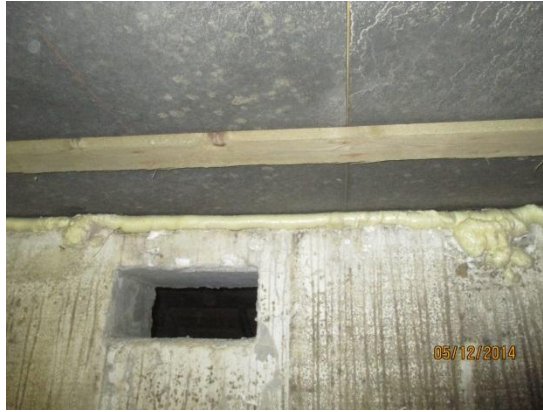
14. välituella levysaumojen tiivistys ok, mutta levyjen välisauma on auki
