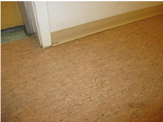
3. väliseinän liittymässä muovilista
