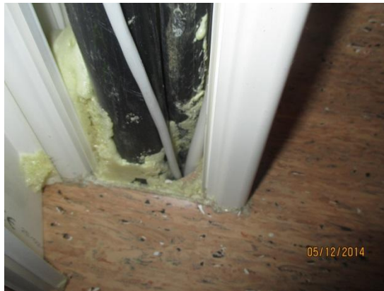
4. sähkökeskuksen kaapeli läpivienti
