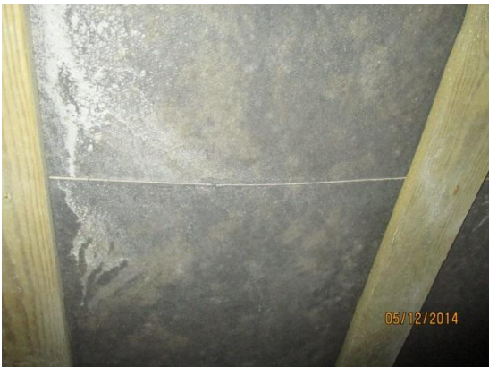
11. bituliittilevyn alapinnan värjäytymä
