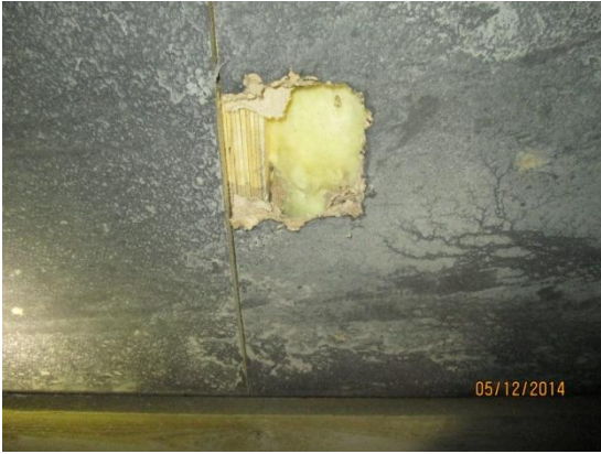
19. värjäytymäkohdalla villan väri on terve, levypalan yläpinta on terveen värinen
