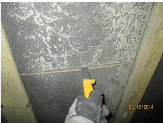
17. levyjen välisen sauman takana kertopuu, levyssä on värjäytymää ja/ tai pölyä
