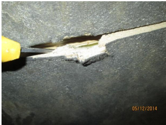
12. levysauma tiivistämättä ja irti kertopuupalkin pinnasta
