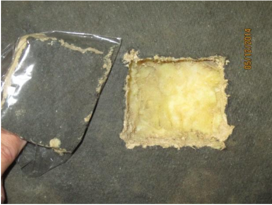
13. otettiin levystä näyte, levym yläpinta on normaalin terveen värinen. Eriste vaikutti olevan terveen värinen ja muuten ok.
