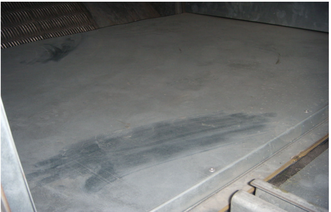
KUVA 10. Yleiskuva tuloilmakoneen kammioista.
