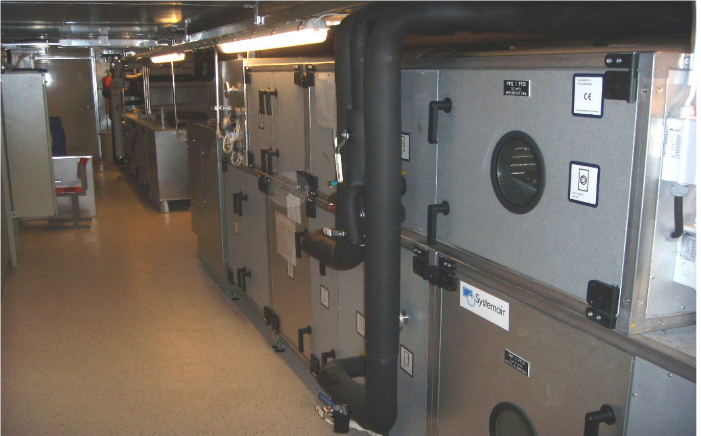
KUVA 1. Yleiskuva IV- konehuoneesta.
