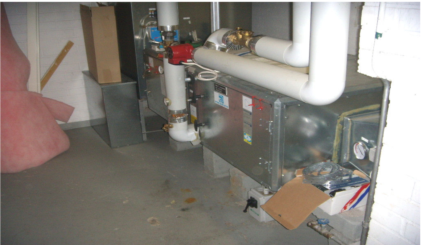
KUVA 2. Yleiskuva IV- konehuoneesta.
