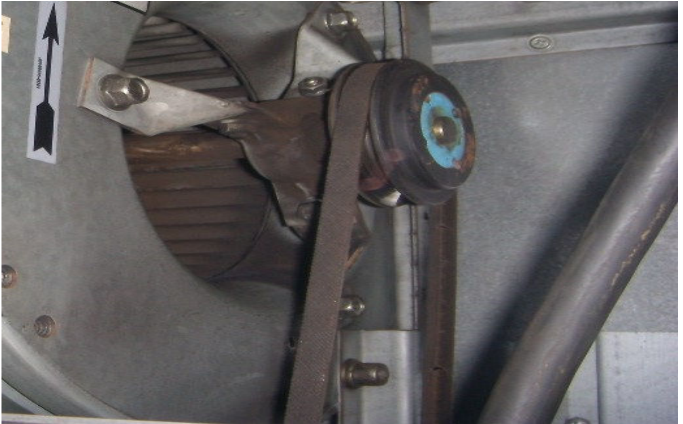
KUVA 5. Tuloilmapuhaltimen hihna on melkein poikki.
