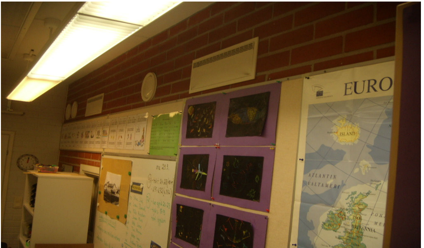
KUVA 24. Luokkahuoneiden valaisimia on osin asennettu heittokuvioiden eteen.
