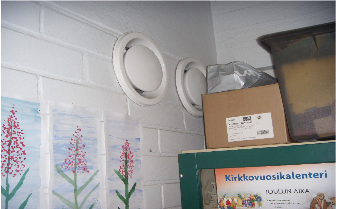
KUVA 27. Poistoilmaventtiilien edessä on tavaraa, jotka estävät ilman liikkumisen.
