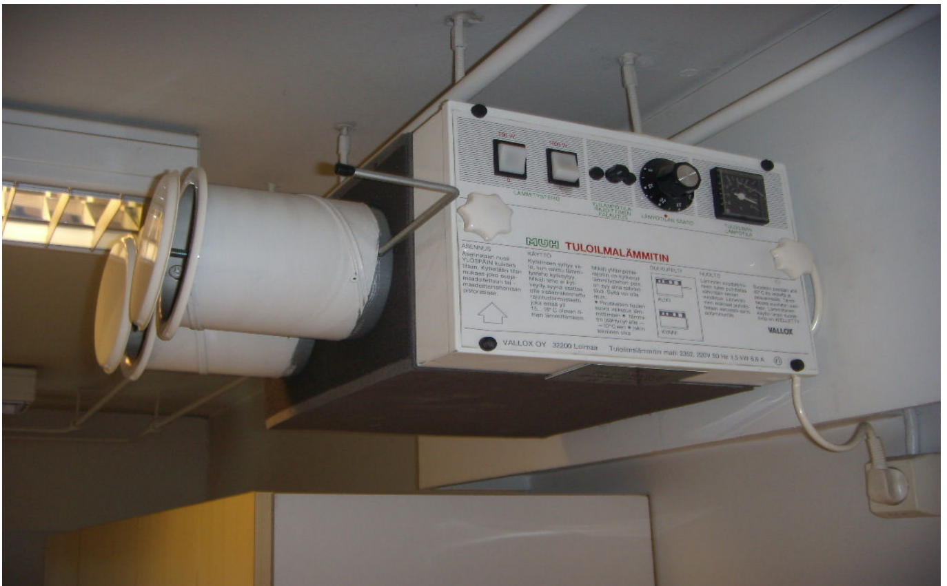
KUVA 18. Yleiskuva hammashoitolan tuloilmalämmittimestä.
