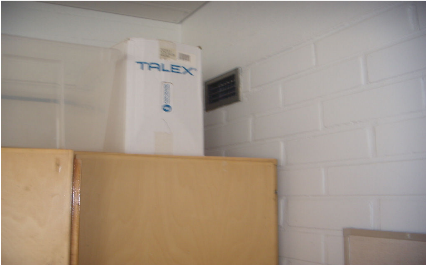
KUVA 25. Kaappien päällä on tavaraa, jotka estävät ilman liikkumisen.
