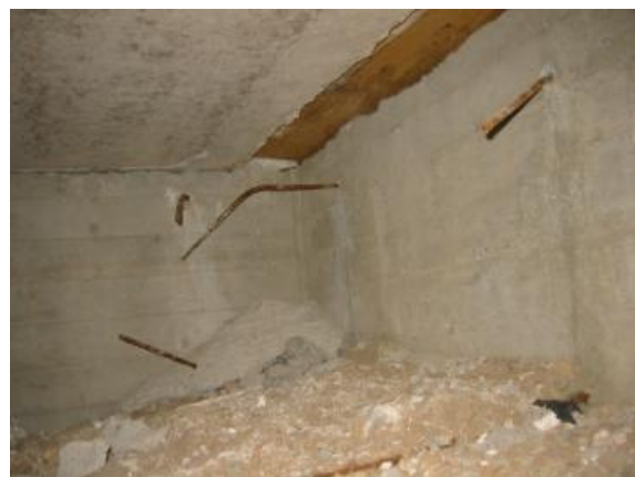
Kuva 20 Eteläpäädyssä oleva purkamaton vane-rimuotti. Maassa on mikrobikasvustoa. Muottiraudat sojottavat vaarallisesti
