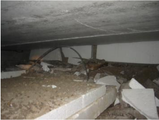
Kuva 17 Pohjaviemärin kannakkeita on irti.
