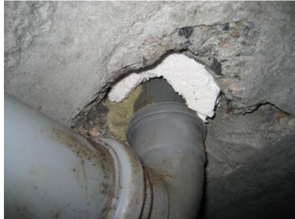
Kuva 6 Ontelolaatan kohdalla läpiviennit ovat tiivistämättä.
