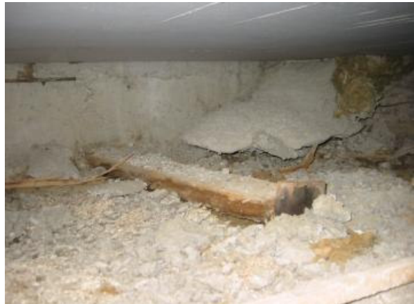
Kuva 26 Pohjoisosan perusmuurin alla oleva purkamaton solkipuu, joka on laho..
