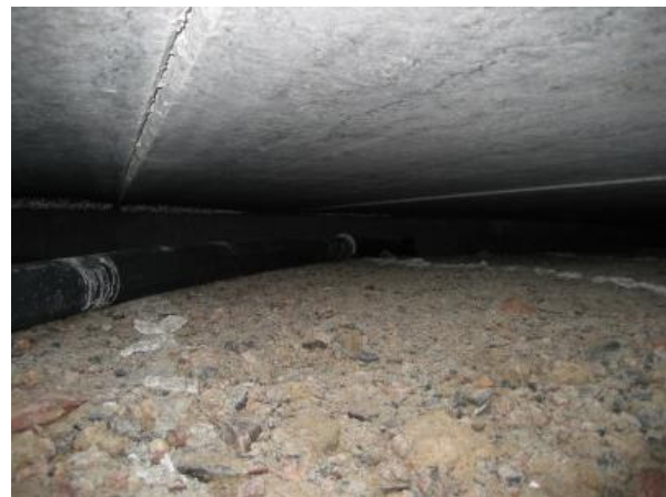
Kuva 4 Pohjoissivulta tuleva sadevesiviemäri on köyry ylöspäin n. 10 cm. Ontelolaatan alla on tilaa n. 30 cm.
