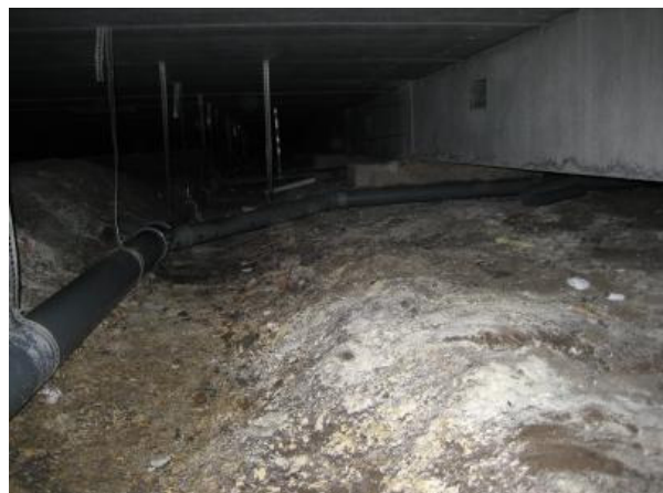
Kuva 10 Etelälokkossa kulkee pohjaviemäri, jonka vieressä on vaaleaa kasvustoa.
