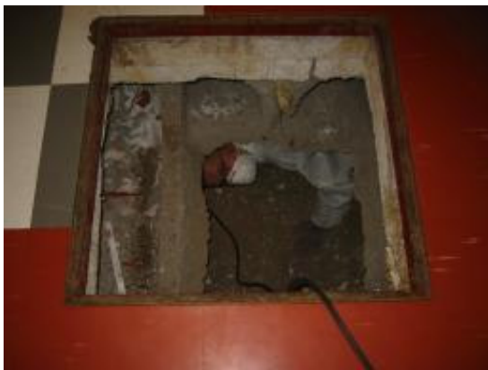
Kuva 15 Kulkutie ryömintätilaan on ahdas. Kuilun reunoja ei ole viimeistely. Luukku ei ole tiivis.
