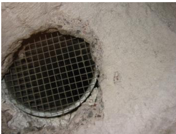
Kuva 27 Ryömintätilan ilmanpoisto on järjestetty koneellisesti.
