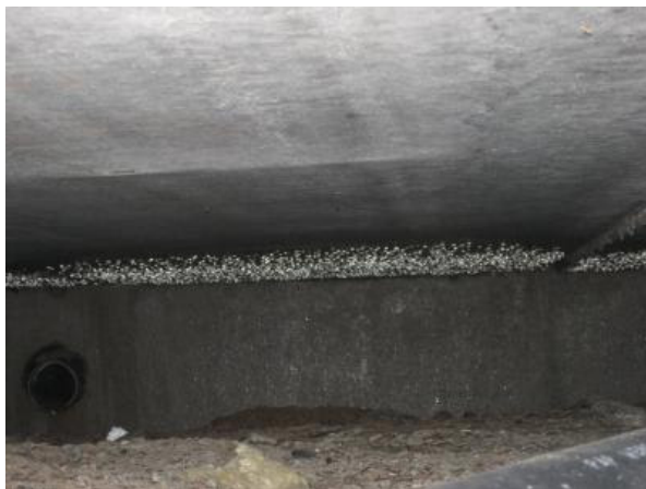
Kuva 3 Pohjoislohkon pohjoissivun ulkoseinän vieressä tuuletusputkien kosteustiivistyy ontelolaatan ja sokkelin pintaan.
