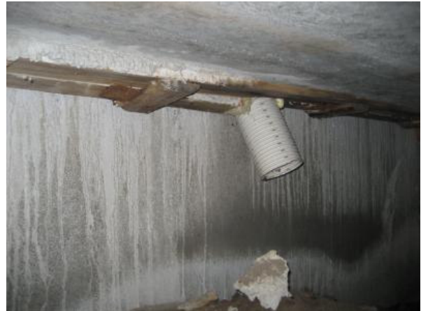
Kuva 8 Päädyissä oleva muottilaudoitus on purkamatta. Eteläisivulla sekä itä- ja länsipäädyssä tuuletus on järjestetty salaojaputkella.
