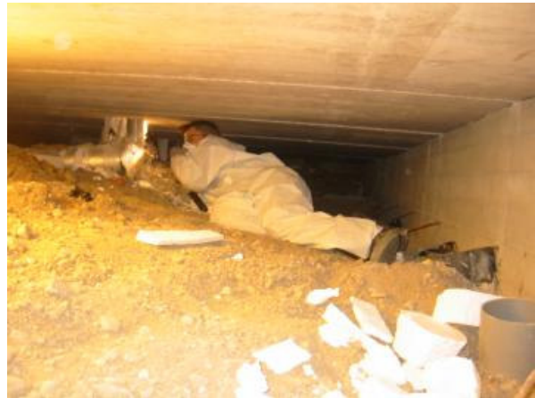
Kuva 24 Viemärien läpiviennit vaikuttivat savukokeessa tiiviiltä. Pohjaviemärit ovat keskiosalla soran ja eristeiden alla.
