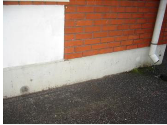
Kuva 30 Ryömintätilan tuuletusputki on aivan maanrajassa. Kattosadevesien poistossa on puutteita.
