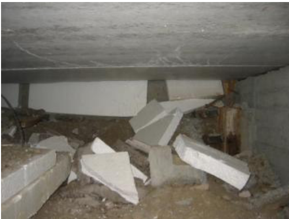
Kuva 19 Pohjoisosan perällä on purkamattomia lahoja muottilaudoituksia.
