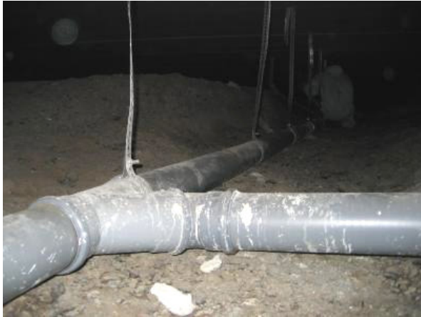
Kuva 11 Etelälohkon pohjaviemäriin ja sivuhaaran liitoksessa on tapahtunut notkahdus, johon jätettä voi kertyä.
