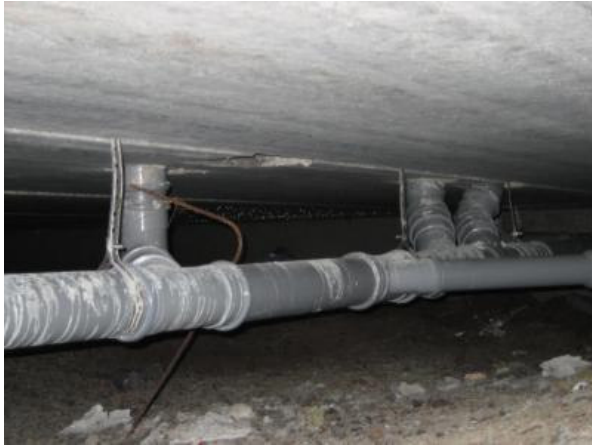
Kuva 5 Viemärit ovat eristämättä. Niiden kannatus on tehty katosta teräsranoin.
