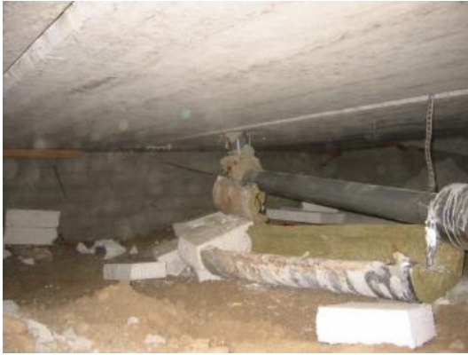
Kuva 29 Tilassa on erilaista rakennusjätettä. Viemärien eristeet ovat paikoin irti.
