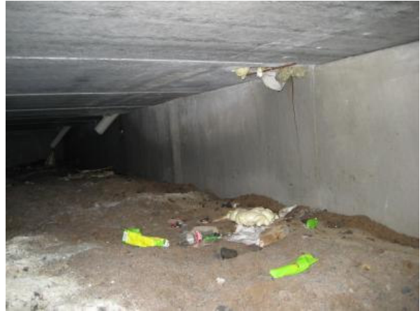
Kuva 12 Etelälohkon eteläseinän sokkeli on kostea, samoin maanpinta. Tuuletusputkista on tiputettu roskaa.
