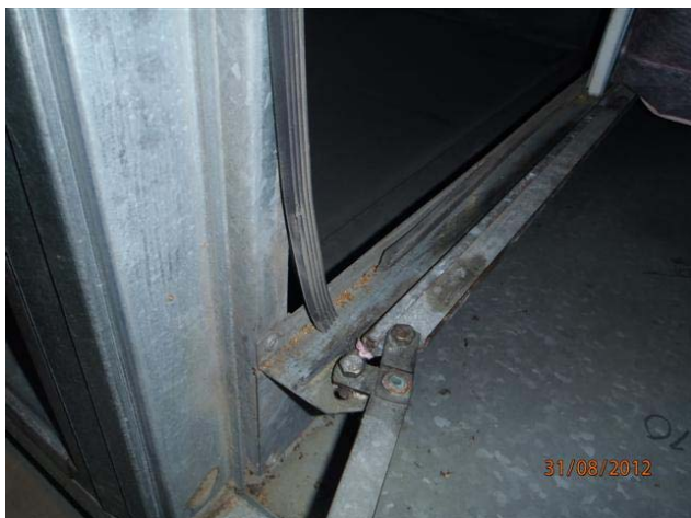
kuva 9 Suodatinkehikoista on irronnut tiivisteitä.
