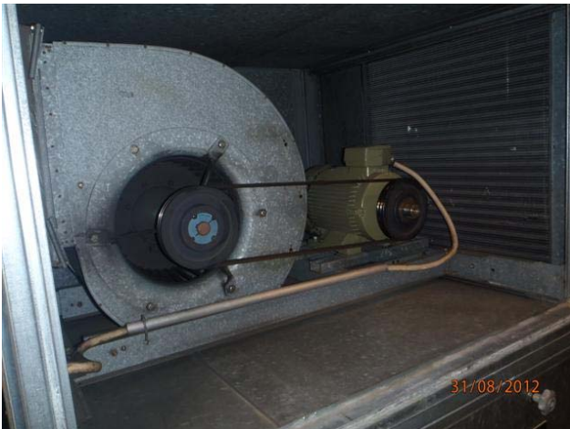
kuva 1 Tuloilmakoneen TK2 puhallin ja kammiot ovat puhtaat.
