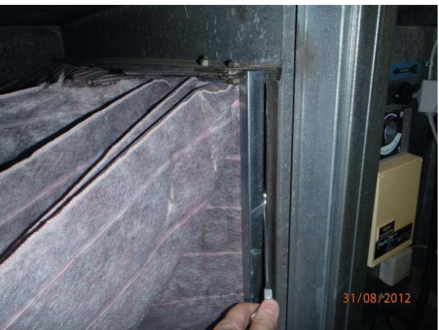
kuva 10 Suodattimien välistä poisjäynyt tiiviste jättää raon suodattimen reunan ja kehikon väliin.
