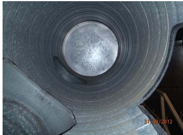
kuva 2 Tuloilmakoneen TK1 runkokanava on puhdas.
