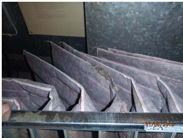
kuva 6 Tulokoneen TK2 suodatin on repeytynyt.
