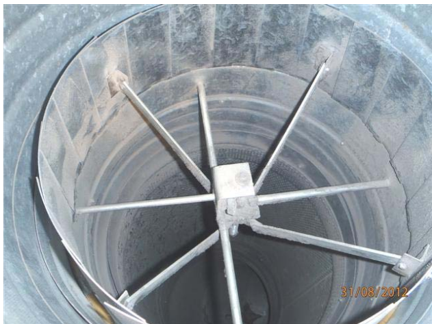
kuva 5 Poistokoneen PK2.1 likainen säätöpelti ja kanava.
