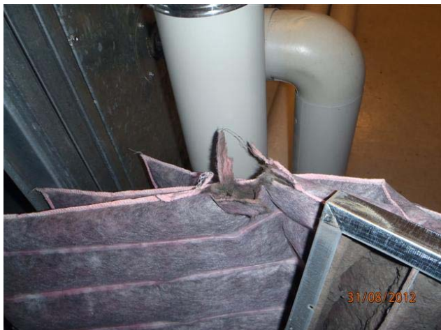
kuva 7 Myös tulokoneen TK3 suodatin on repeytynyt.
