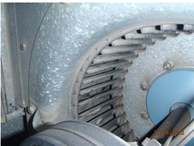
kuva 3 Poistokoneen PK3.1 puhallinosa on likainen.
