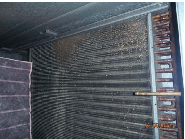
kuva 8 Tulokoneen TK3 lämmityspatteri on likaantunut ohivirtauksien takia.
