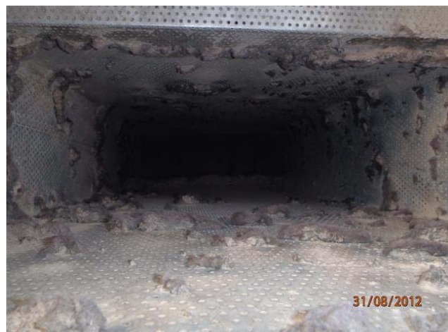
kuva 4 Poistokoneen PK3.1 ulospuhalluskanava on erittäin likainen.
