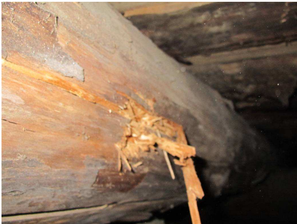
Kuva 4. Rakenteissa havaittiin pehmenemistä pistopiikillä tehdyssä tarkastelussa
