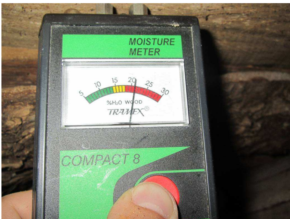
Kuva 5. Rakenteellinen kosteus mahdollistaa alapohjarakenteiden lahovaurioitumisen
