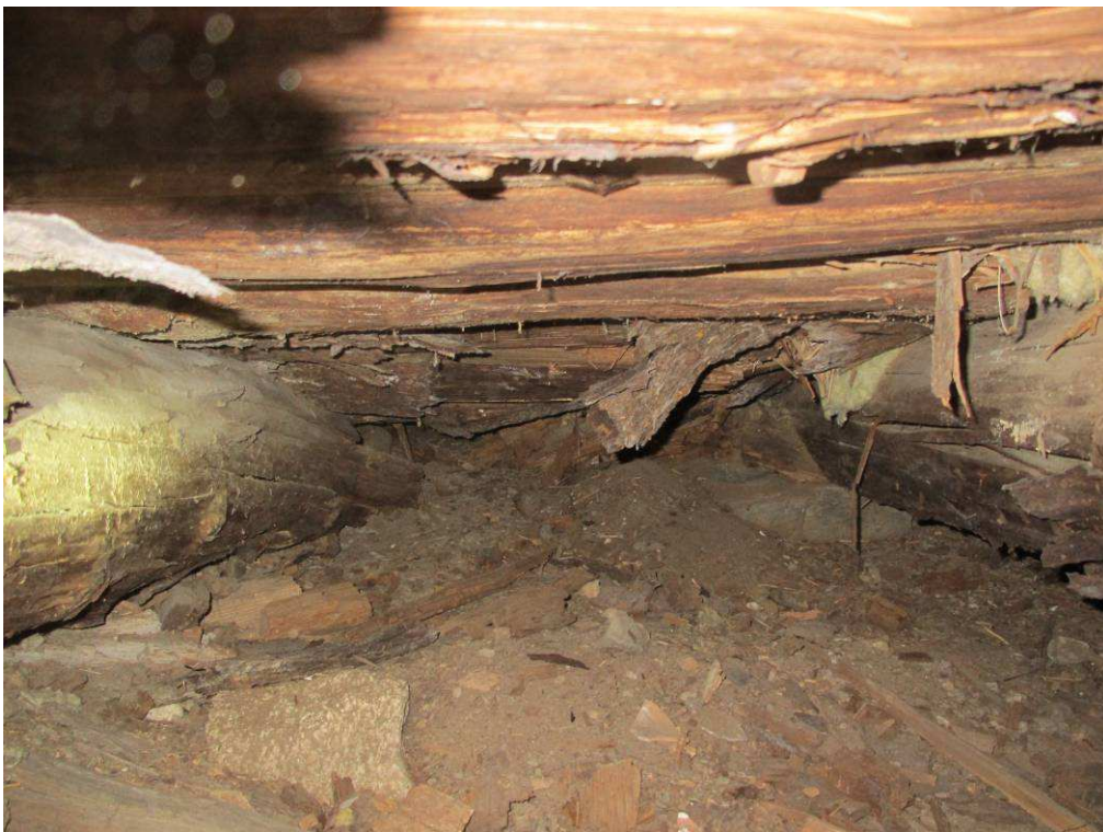
Kuva 3. Pääsisäänkäynnin pääty on maata vasten ja rakenteet ovat lahoja
