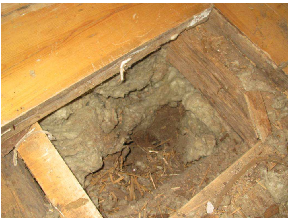
Kuva 7. Rakenneavauskohta 2, rakenteesta tuli voimakas mikrobiperäinen haju
