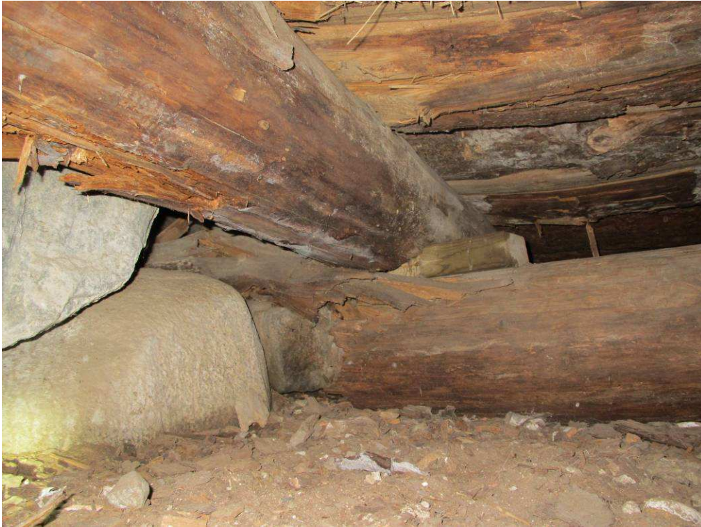
Kuva 2. Alapohjan primäärikannattaja on katkennut sisäänkäynnin päädyssä, rakenteissa on laajasti lahovaurioita
