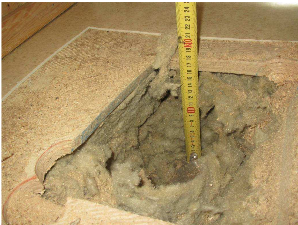
Kuva 6. Kuvaa rakenneavauskohdasta 1, rakenteesta tuli voimakas mikrobiperäinen haju
