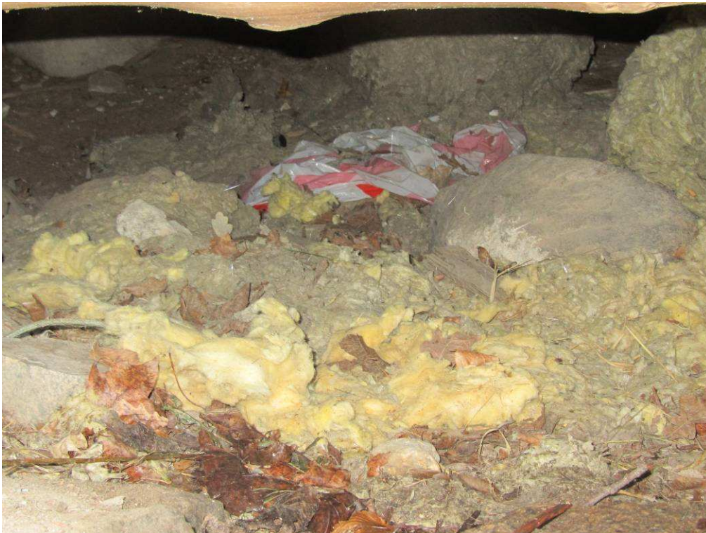
Kuva 1. Ryömintätilassa on runsaasti villaa ja muuta rakennusjätettä
