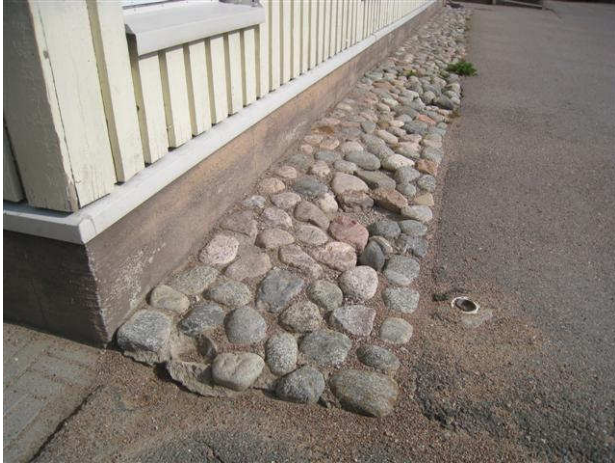
Kuva 13 Kaakkoissivulla on sokkeli vierellä kenttäkiveys, sokkeli on kulunut.
