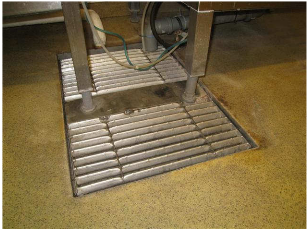
Kuva 46 Keittiön lattiakaivo ja kulunutta lattiapintaa.
