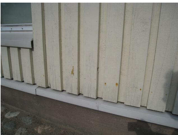
Kuva 17 Kaakkoissivulla alaosalla halkeilleita lautoja ja ruosteisia naulauksia.
