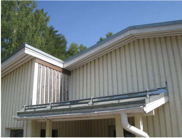
Kuva 19 Lounaispäädyn katos, jonka yläpuolella on laudoitusta uusittu, mutta ei ole maalattu. Räystäs on lyhyt.
