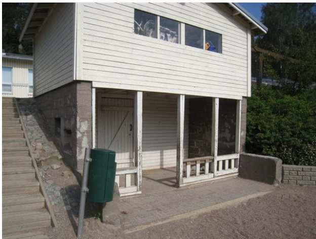
Kuva 3 Ulkopinnoiltaan huonokuntoinen 2-kerroksinen leikkivälivarasto.
