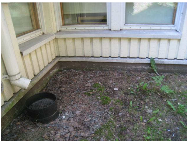
Kuva 11 Yhteishalli 16 sisäkulman rännikaivo voi vuotaa yli, maanpinnat ovat melko ylhäällä.
