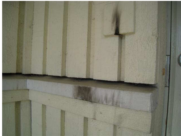
Kuva 21 Lounaispäädyn katoksen savujälkiä ilkeivallan jäljiltä
