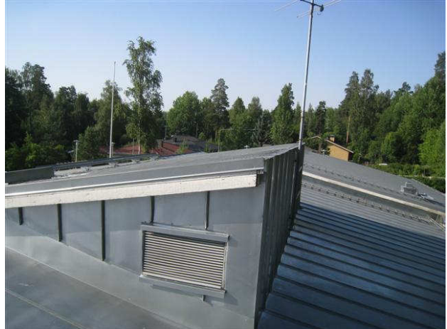
Kuva 32 IV-konehuoneen yläpohjan tuuletusvälistä ei ole tuuletusreittä.
