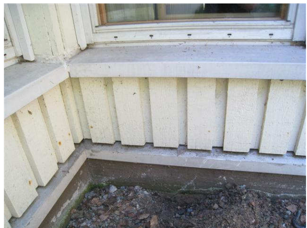
Kuva 12 Perusmuurissa ei havaittu kosteussuojaa koekaiivukohdassa.
