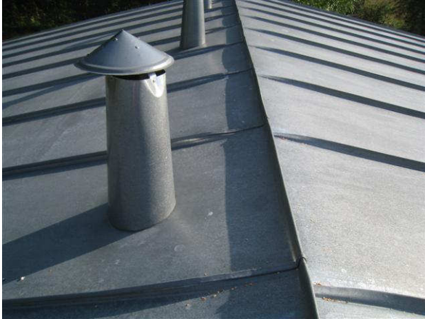
Kuva 31 Yläpohjan tuuletusvälin tuuletusratkaisu, suojahattu on hieman vinossa.
