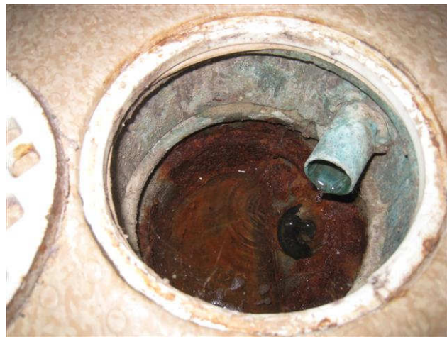
Kuva 40 Suihkutilan lattiakaivo on ruostunut.
