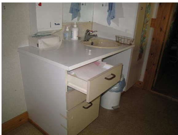
Kuva 53 Ryhmähuoneen, tila 5, alkuperäisiä kalusteita, jotka ovat kuluneet.
