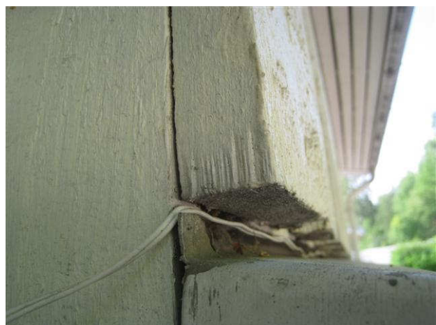
Kuva 18 Ulkoverhouslautojen alapäissä ei ole viistettä ja päitä ei ole maalattu.
