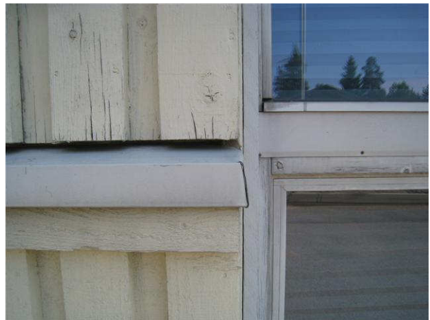
Kuva 16 Ulkoverous on kärsinyt säärasitusta ja halkeillut kosteudenvaihtelussa.
