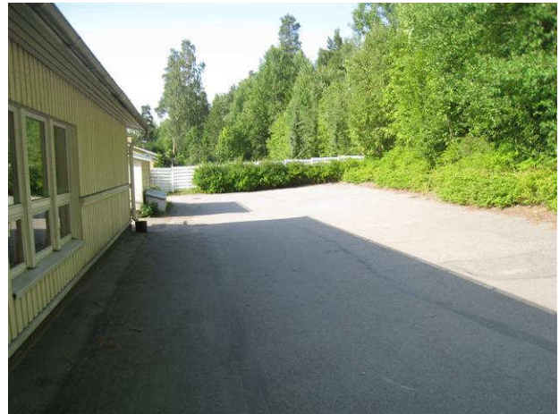
Kuva 8 Yläpihalla huoltopiha viettää kohti rakennusta, mutta on vastakallistukset.
