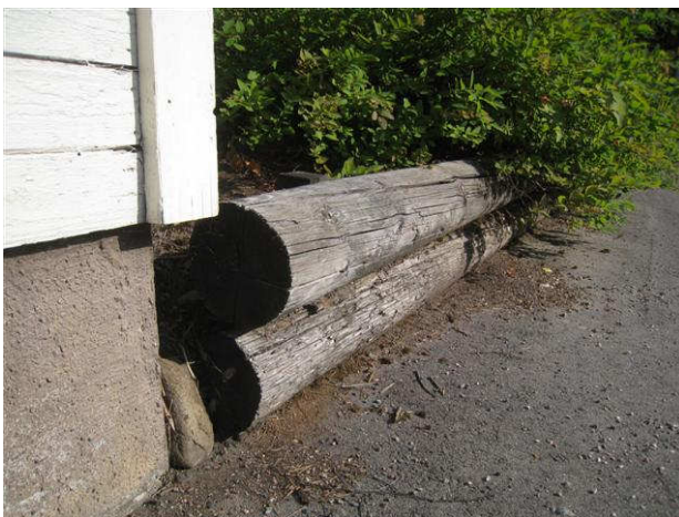
Kuva 5 Yläpihan huoltopihan tukimuurin pylväävät ovat kallellaan ja kuluneita.
