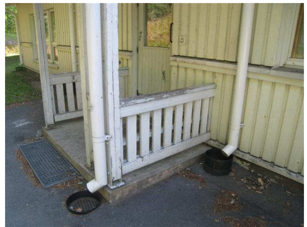
Kuva 22 Keittiön sisäänkäynnin katos on huonokuntoinen.
