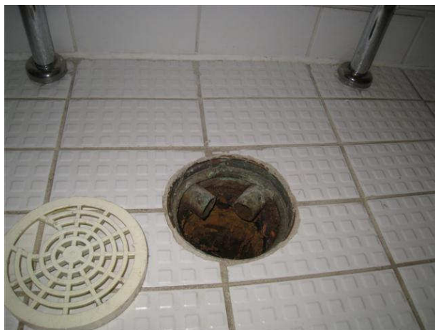
Kuva 41 Laatoitetun wc-pesutilan ruosteinen lattiakaivo.
