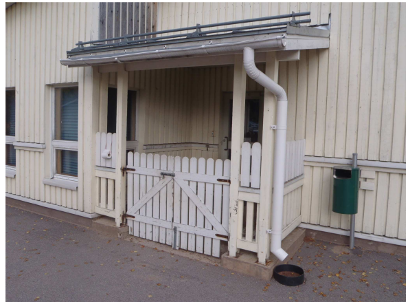
Sisäänkäyntikatosten kohdilla sadevesikourut ovat taipuneet ja osin vesi vuotaa niistä yli.
