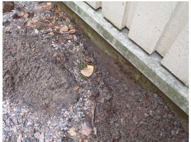
Maa-aines länsisivulla on soraa, sokkelissa ei havaittu vesieristettä.
