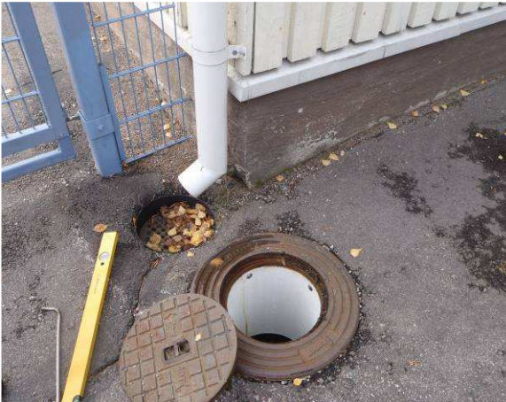
Koillisnurkalla oleva salaojakaivo.
