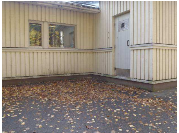
Rakennuksen vierustalla on havaittavissa kosteuden aiheuttamaa likaantumista.
