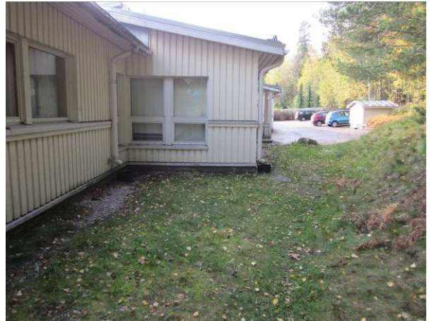
Maanpinta on noin 1 metrin matkalla seinästä vaakatasossa. Pintavesien ohjausta tulisi parantaa.
