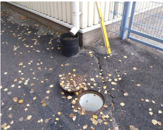
Salaojakaivo ja rännikaivo talon etelä / länsi nurkalla.
