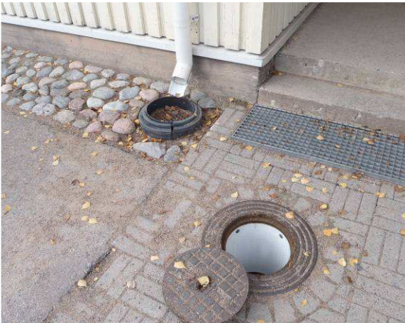
Rännikaivo ja salaojan tarkastuskaivo.
