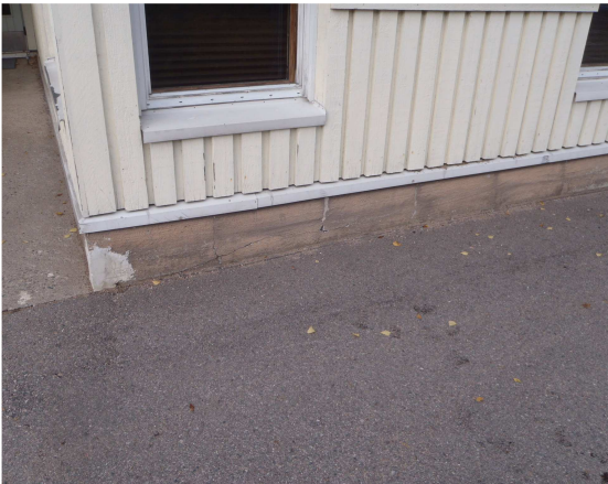
Sokkelipinnoitteessa on havaittavissa halkeilua. Puu-ulkoverhouksen maalipinta on jo kulunut.
