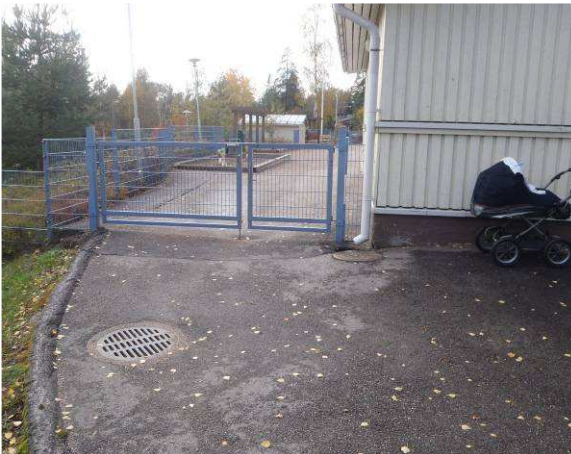
Itäisivusta, josta pintavedet ohjautuvat osin päädyn sadevesikaivoon.
