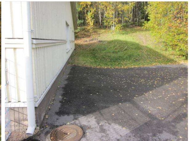
Rakennuksen vierustalla asfaltti kaataa noin 200mm 2 m matkalla. Maanpinnassa on taite, joka ohjaa veden pois rakennuksen vierustalta.
