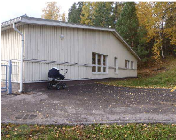
Kuvaa pohjoisen puoleiselta sivulta. Rinne kallistuu kohti rakennusta.
