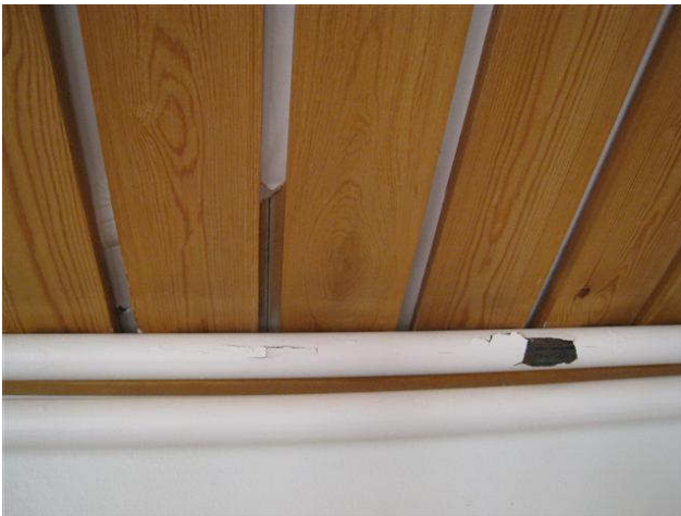
Kuva 29 Vuotovaurio maalipinnassa liikuntasalitan 38 ulkoseinällä.
