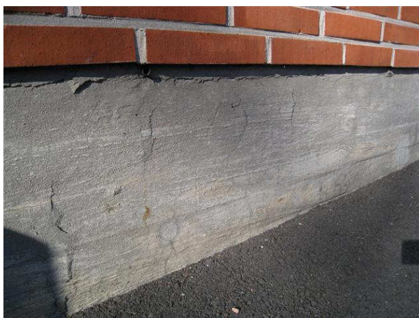
Kuva 3 Tiilipinnan ja sokkelin rajalla on halkeilua ja sokkelin pinta on halkeillut, osas teräksiä on lähellä pintaa. Muurauksen taakse ilmarakoon on vain pienet tuuletusputket.
