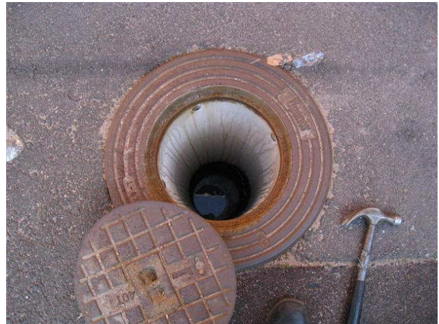
Kuva 2 Tarkastetuissa salaojakaivoissa vesipinta oli reilusti lattiapintaa alempana, mutta se oli juoksupinnan tasossa.
