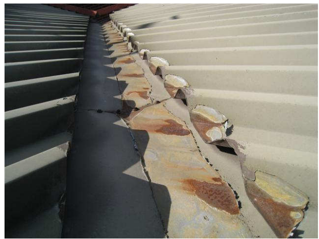
Kuva 12 Jiiripellit ovat ruosteessa ja pinnoite irtoaa. Saumassa on ruuviläpivientejä.
