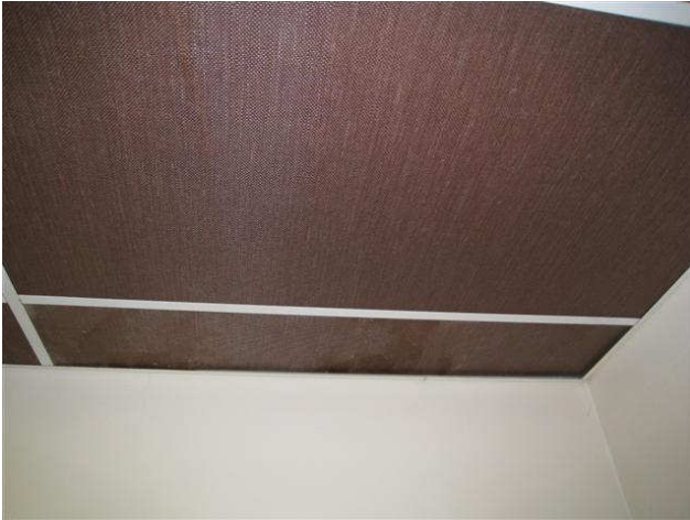
Kuva 23 Vuotojälkiä alakattolevyissä henkilökunnan sos.tilan 08 tilan katossa, ks. kuva 24.
