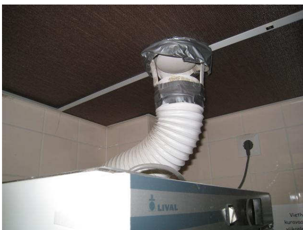
Kuva 39 Kuivauskaapin ilma on johdettu poistokanavaan.
