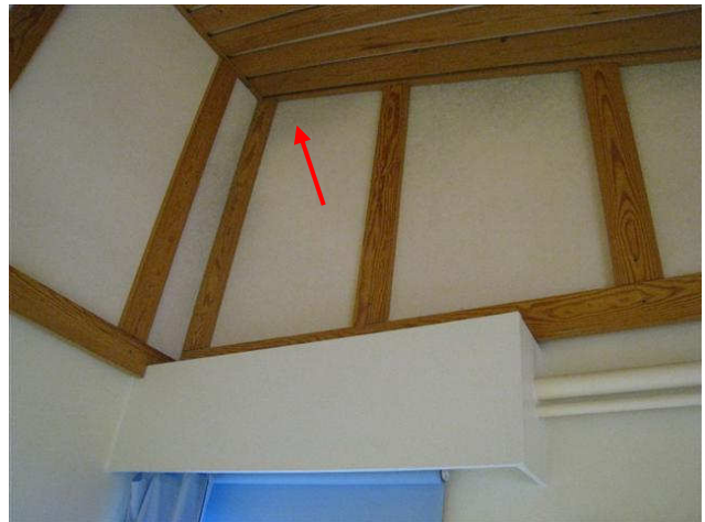
Kuva 30 Korkeiden tilojen seinien akustiikkalevyissä on pölyn aiheuttamia tummumia.
