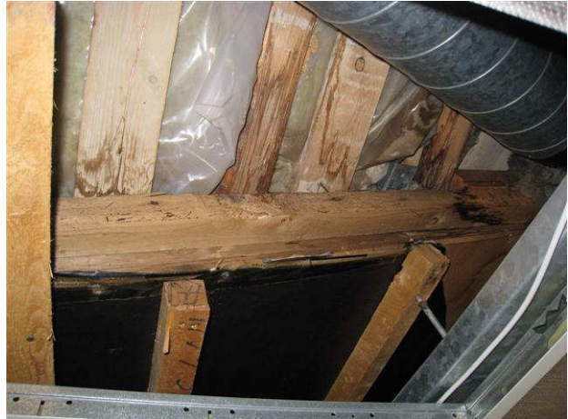
Kuva 18 Alakaton vuotojälkikohdalla oli yläpohjan höyrystulun päällä ja puutavarassa vesijälkiä. Liittymät eivät ole tiiviit.
