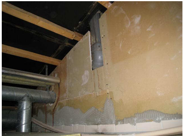
Kuva 20 Viemärin tuuletusputken läpivientikohdalla on valumajälkiä seinällä. Seinän yläosalla on laastin alla kosteussuojakäsitteily märkätilojen kohdalla.
