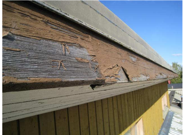
Kuva 6 IV-konehuoneen vesikaton yläräystään otsalauta on huonossa kunnossa ja räystääspellitys on puutteellinen.
