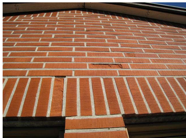
Kuva 4 Eteläpäädyssä joitain tiiliä on pakkasrautunut ja lohjennut.
