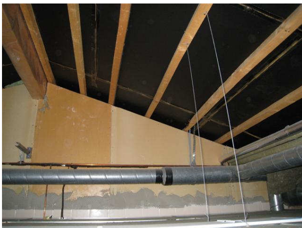
Kuva 19 Alakattojen yläpuolella on yläpohjan alapinnassa huok. kuitulevyt, joiden saumat on teipattu, teippauksia on yleisesti irti.
