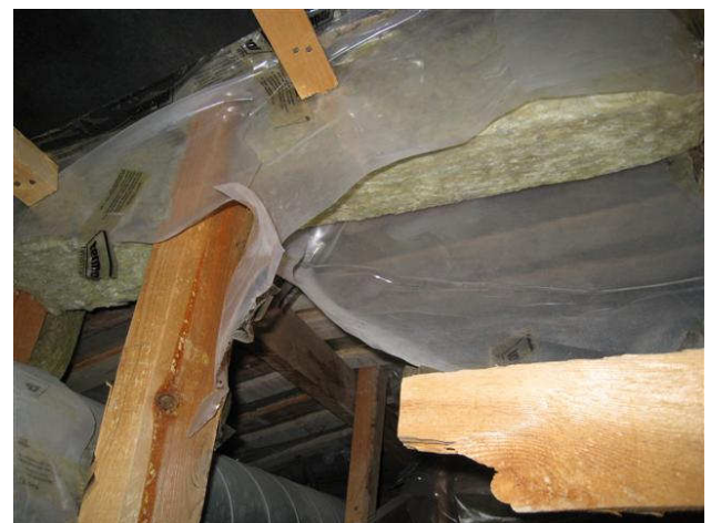
Kuva 26 Epätiivitä höyrysulun liittymiä ja vuotojälkiä.
