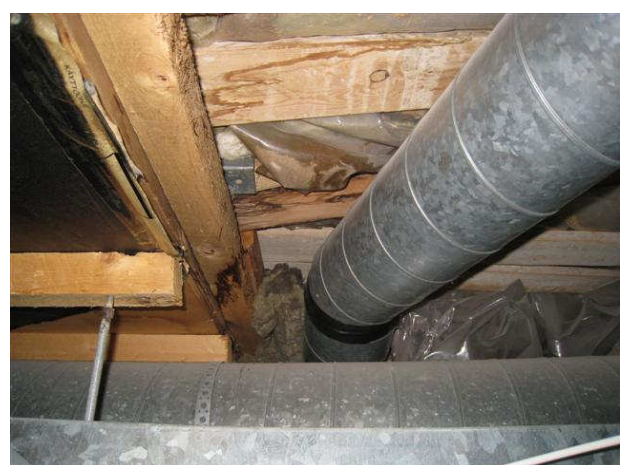
Kuva 22 Epätiivis höyrystulun ja kattolevyn liittymä sekä vuotojälkiä.
