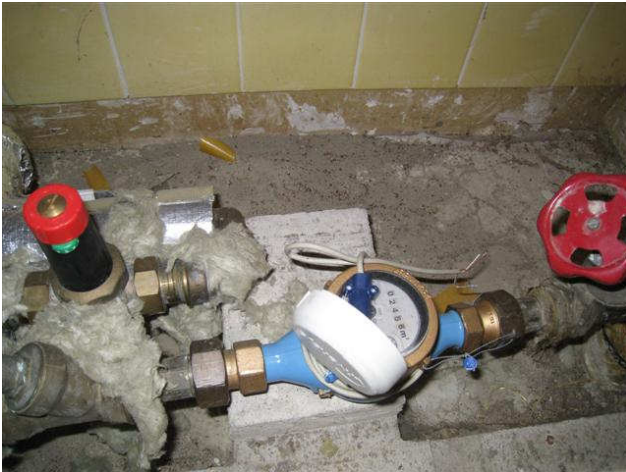
Kuva 41 Vesimittaritila varastossa 21. Vesieristys vaikutti puutteelliselta.
