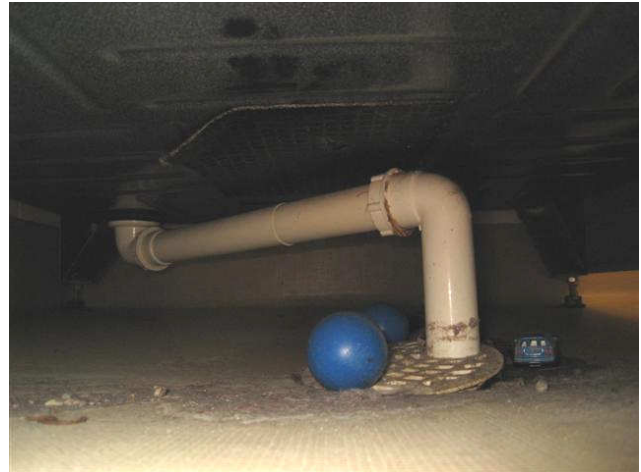
Kuva 42 Suihkualtaiden alla olevia kaivoja on vaikea puhdistaa.
