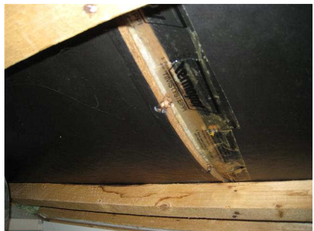
Kuva 28 Pullahtanut kattolevy, teippaus on irti, vuotojälkiä ruoderimassa.
