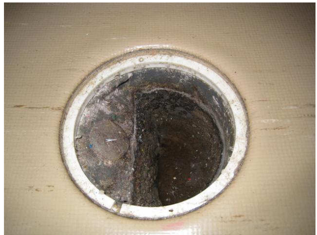
Kuva 32 Lattiakaivon liittymä vaikutti tiiviiltä, mutta matto on hieman irti reunoilta.
