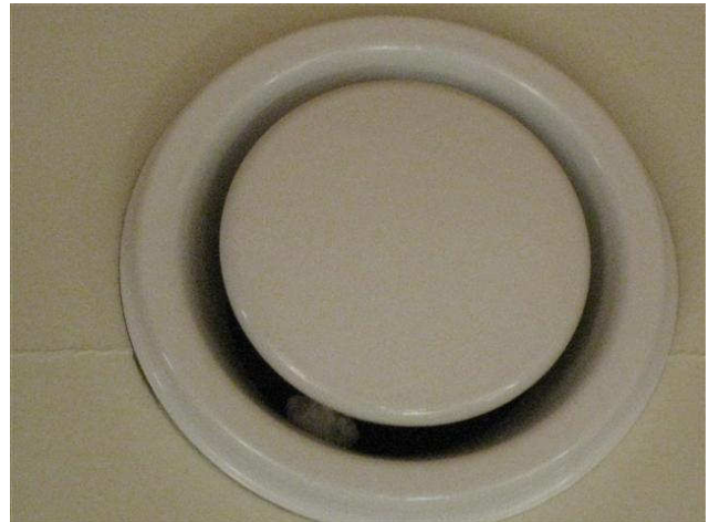
Kuva 38 Poistokanavassa on likaa..
