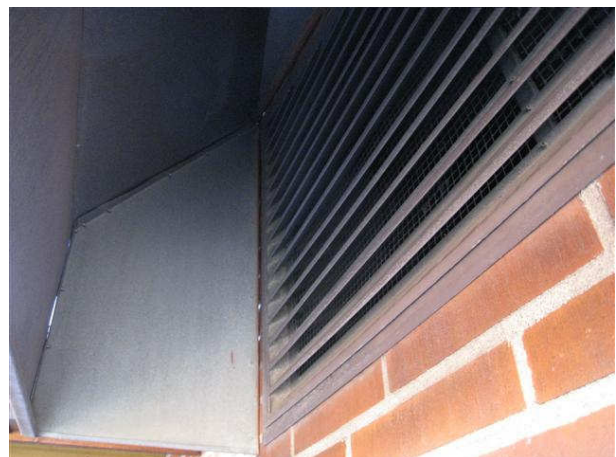
Kuva 40 Ilmasäleikön päälle on lisätty suojahuuva tk/me 13 kulmalla. Tästä tuli ilmavirta.
