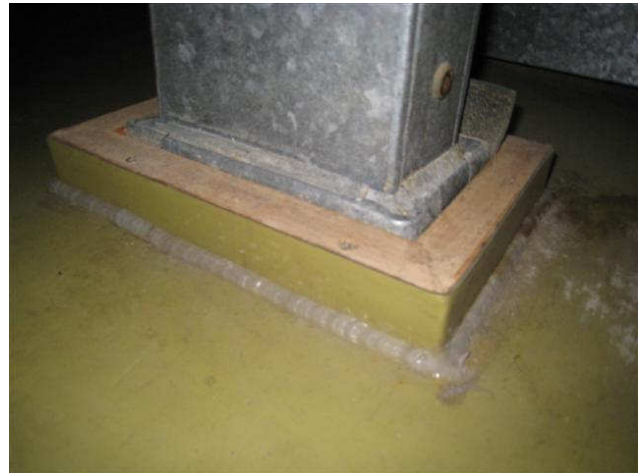
Kuva 36 IV-kojeiden jalkojen alla olevien korkeapalojen reunat on tiivistetty silikonilla.
