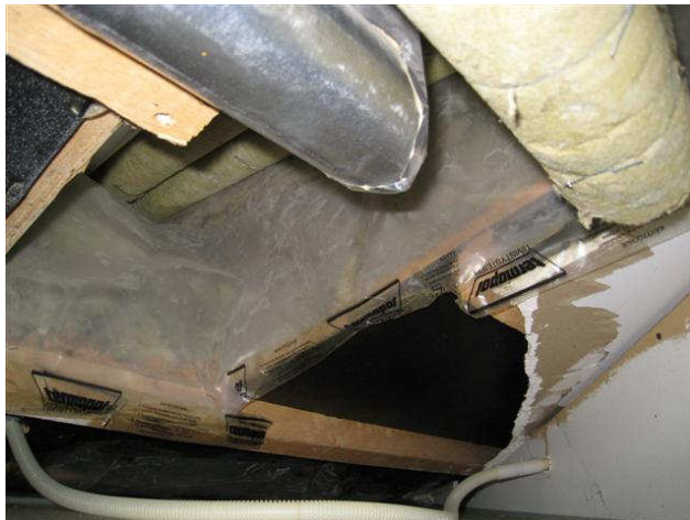
Kuva 25 Yläpohjan porrastuskohdassa on useita epätiiviyiskohtia ja mahdollisesti eristysvikoja.
