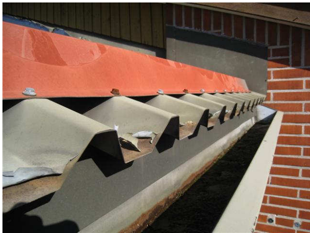
Kuva 13 Peltien alapäistä irtoaa pinnoite ja on ruostetta. Katepellin alta on peltilista ränniin, joka on osin ruosteessa ja kaato riittämätön, ränneissä on roinaa.
