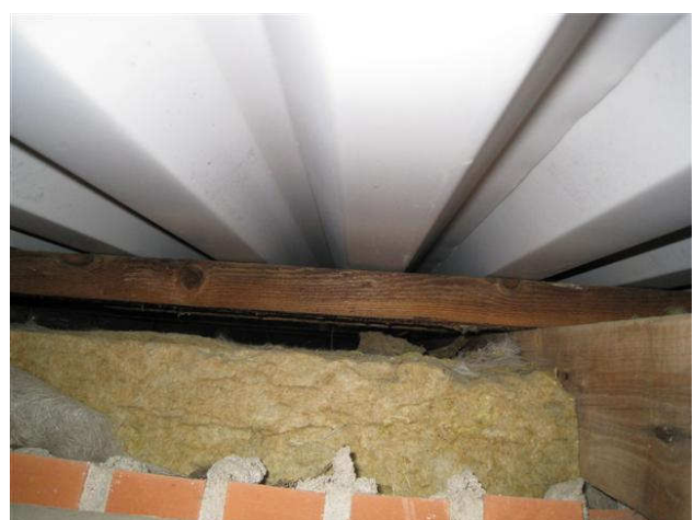
Kuva 16 Aluskate ei ulotu kuin ulkoseinän eristestilan päälle.
