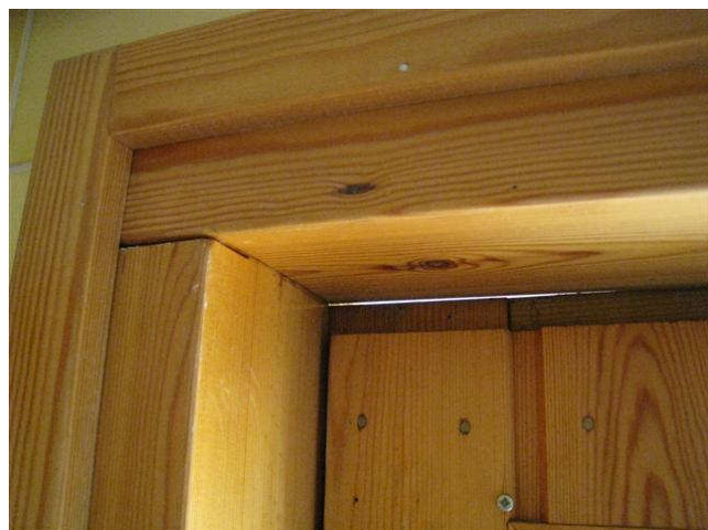
Kuva 10 Selvä ilmavuotoreitti ulko-oven yläreunassa, kun ovi on kiinni.
