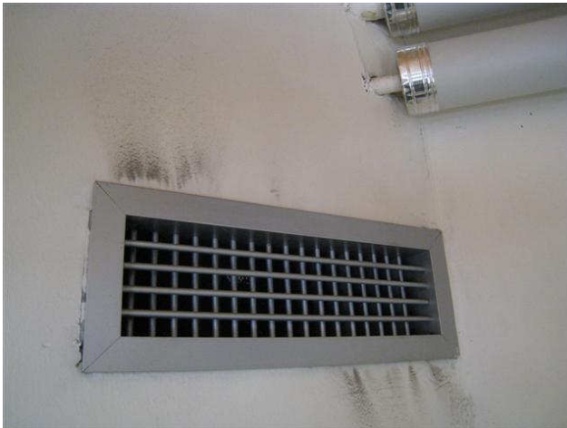
Kuva 37 Tuloilmakanavan liittymä vuotaa.
