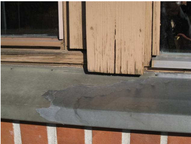
Kuva 7 Huonokuntoisia ikkunoiden alaosia, vesipeltien kallistus on pieni.
