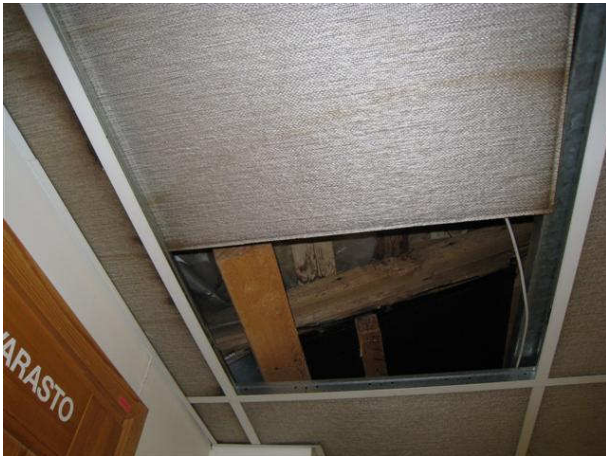
Kuva 17 Tummia vesijälkiä käytävä 40 alakattossa, ks. kuva 18.
