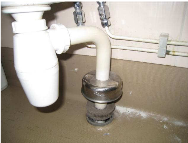
Kuva 31 Viemärin ja vesilukon välissä on kuminen läpivientikappale. Viemärin läpivienti on tiivis, muttei täytä nyky-määräyksiä. Matoissa on juurinosto.
