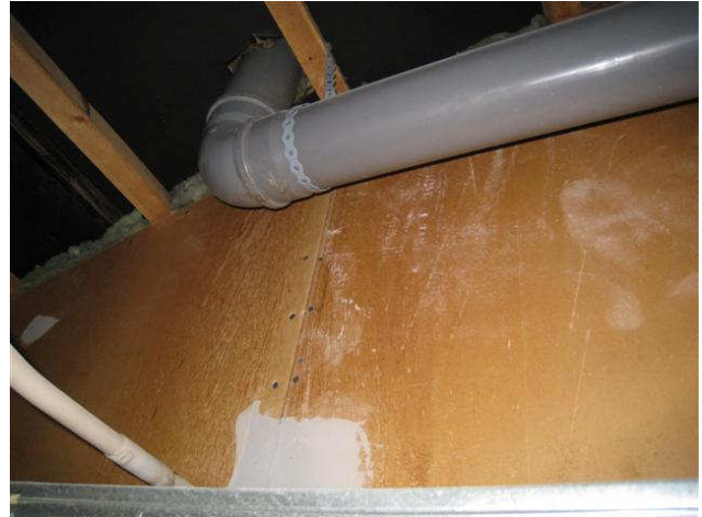
Kuva 24 Alakaton vuotojälkikohdalla on tuuletusviemärin läpivienti ja vuotojälkiä seinässä ja sen alla alakatossa.
