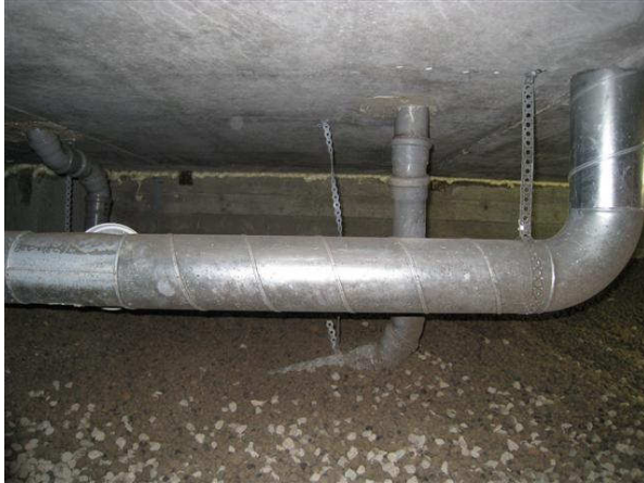
Kuva 3 Alustatiloissa oleva IV-kanava on ripustettu siten, että se on paikoin kulkuesteenä.
