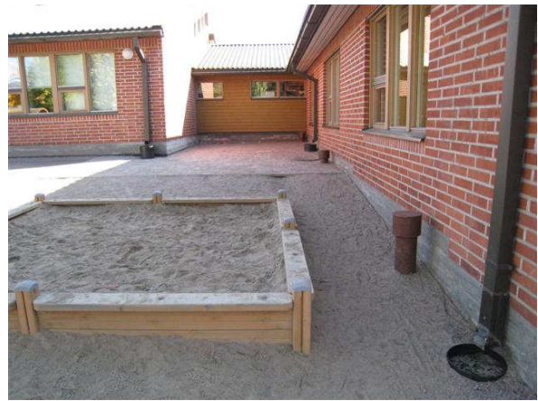
Kuva 16 Rakennuksen vierellä on alustatilaan johtavia korvausilmaputkia tilojen 34, 35 ja 36 kohdalla. Rännivedet on johdettu kaivoihin.
