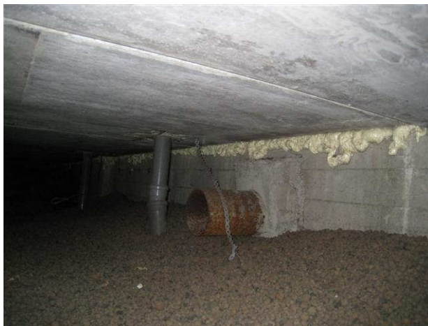
Kuva 7 Ontelolaattojen reunaliittymät on tiivistetty PU -vaahdolla. Ulkoseinillä on alkuperäiset korvausilmaputket. Pohjaviemärien kannakoinnit ovat löysiä.
