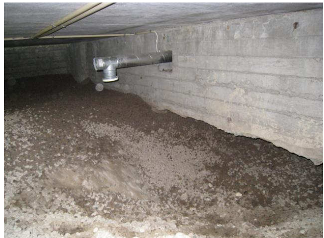
Kuva 2 Tyypillistä alustatila tilojen 28 ja 39 alle. Pohjalla on sekalainen kerros sepeliä ja kevytsoraa, jonka pinta on paikoin kostea. Palkki on aikanaan valettu epäta-saisen maan varaan.
