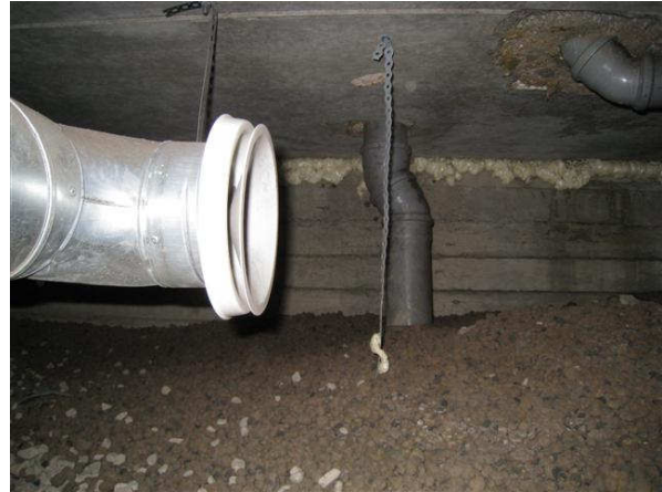
Kuva 4 Tuloilmakanavan venttiili, josta tuli hyvin ilmaa. Viemäriäpiviennit on tiivistetty valaen, pohjaviemärit ovat sorassa.
