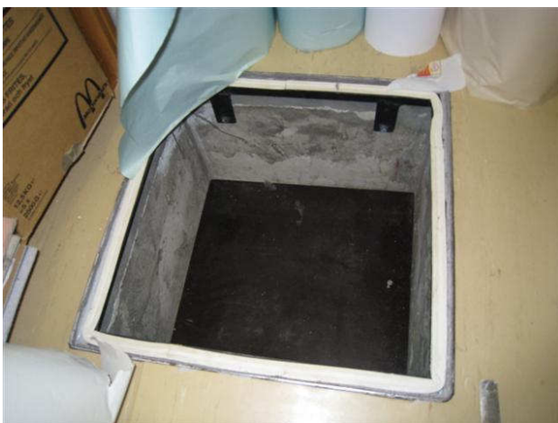
Kuva 1 Varastotilassa 30 oleva miesluukku. Kantana on irtonainen teräslevy, reunoilla on tiiviste. Pohjaluukku on fil-mivaneria. Tiukkahkon luukun nostoon on varattu vain ruuvi.
