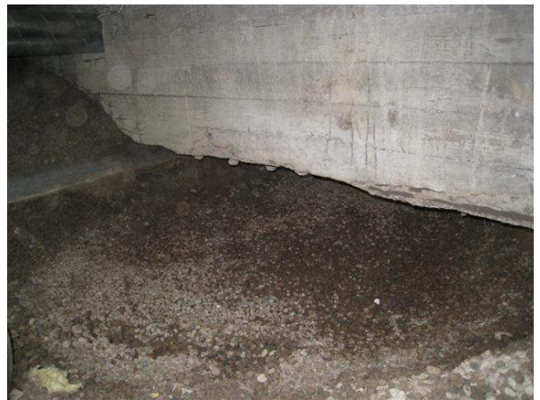
Kuva 12 Perustuspalkkien ali on tehty syvät kaivannot, jotka ovat pohjaltaan kosteat.
