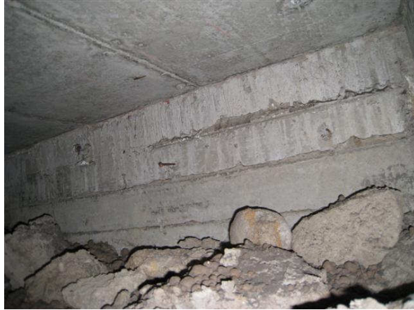
Kuva 15 Tilan 49 alla olevaa betonijätettä ja isoja kiviä.
