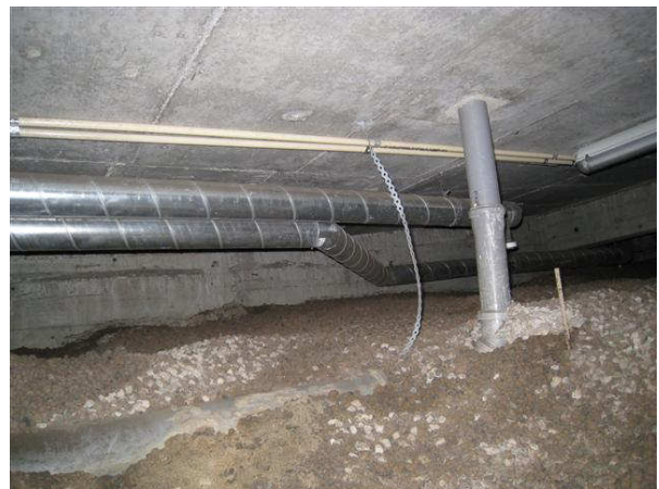
Kuva 14 Yleiskuva tilojen 49 ja 50 alle. Sepelin alla on muovikalvoa ja sen alla kostea hienojakoista hiekkamaata.
