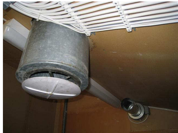
Kuva 6 Ilmanvaihtokonehuoneessa on ilmanotto ja puhallin alustatilan tulokanavaan. Ilmanvaihtokonehuoneen painesuhteet olivat sekalaiset.
