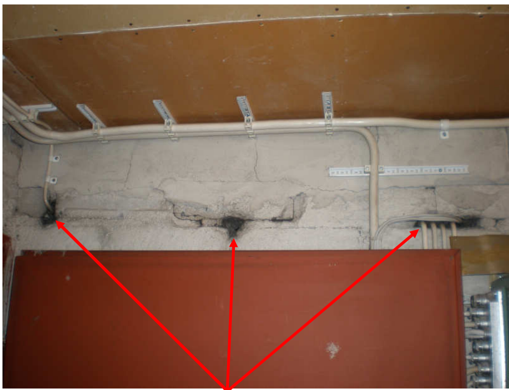
KUVA 5. PK1 Konehuoneeseen johtavia sähkötyö muutostöiden johdotuksien läpivientejä ei ole tiivistetty. (konehuone on suunniteltu ääni ja paloeristetyksi)
