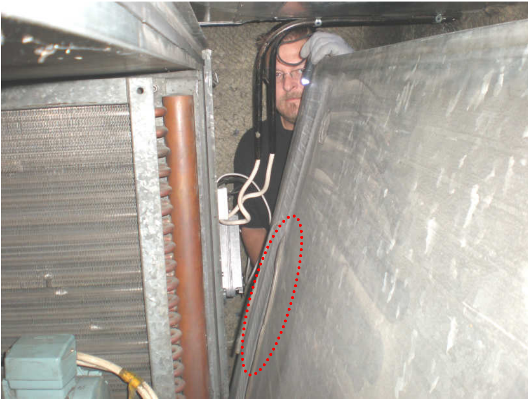
KUVA 2. Paine-ero letkuja on vaikea pujottaa oikeille paikoille, koska letkut sijaitsevat kiinni huoltoluukussa.
