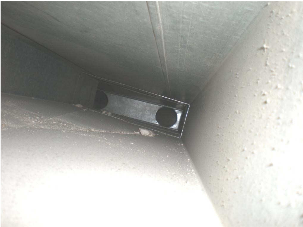
KUVA 14. Kellarin kerhuhuoneeseen johtavassa poistoilmakanavassa on pohjalla hieman kiveä ja rakenneainetta.
