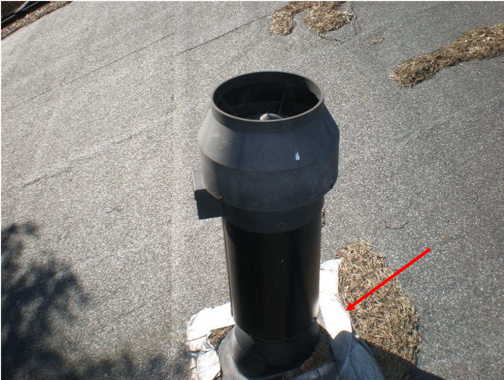
KUVA 17. Katolla sijaitseva Reksovent ilmanvaihtokoneen jäteilmaputken läpivientä on korjailtu iv-teipillä.
