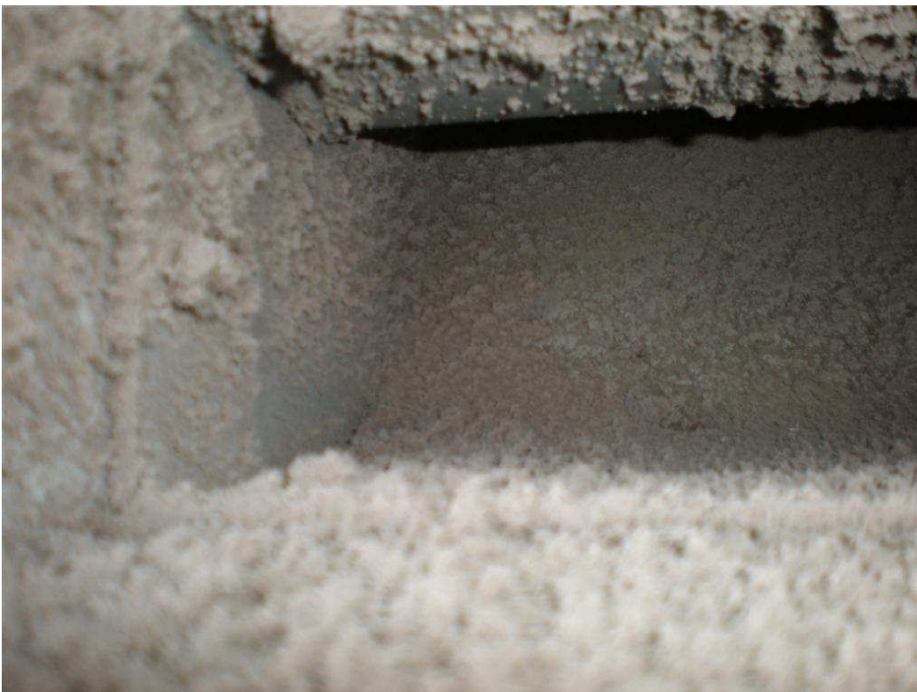
KUVA 16. Baaritilaa palvelevan liesikuvun poistoilmakanava on puhdistuksen tarpeessa.
