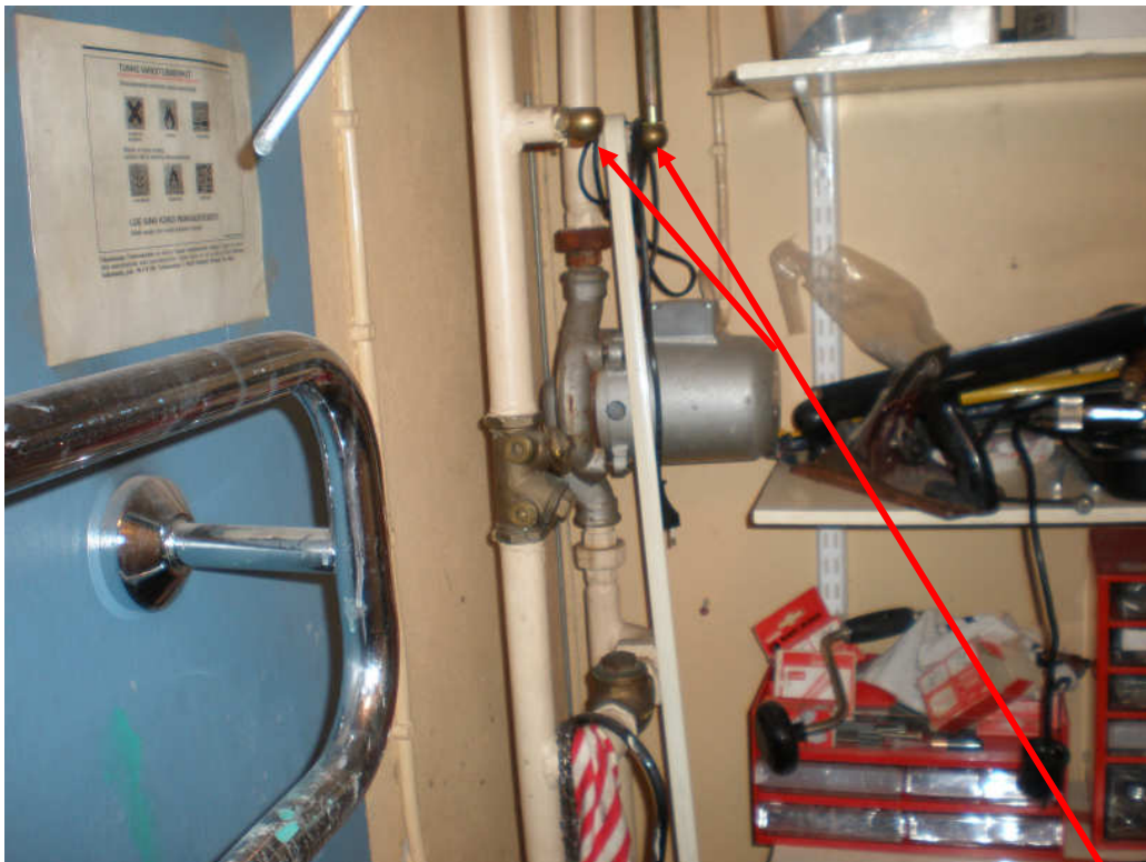
KUVA 7. TK2 lämmityspatterin menovesi / paluuvesi elohopeamittareista toinen puuttui asettimestaan ja toinen oli rikki
