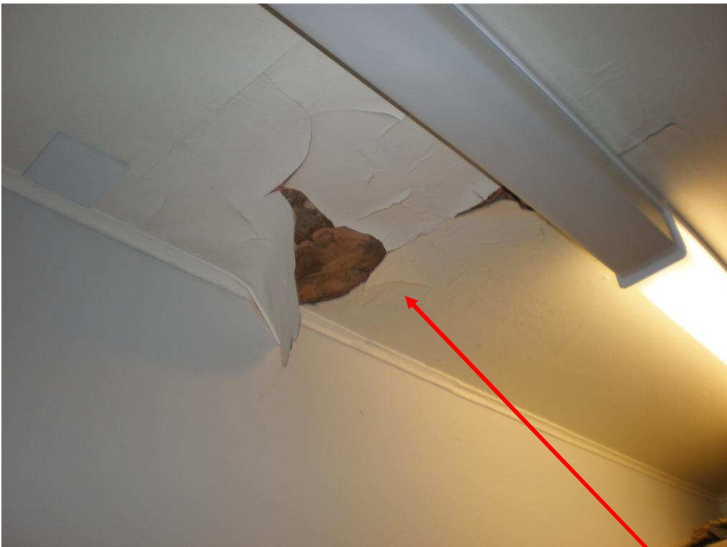
KUVA 7. Vesi on tullut ensimmäisen kerroksen huone no:108 katosta läpi.
