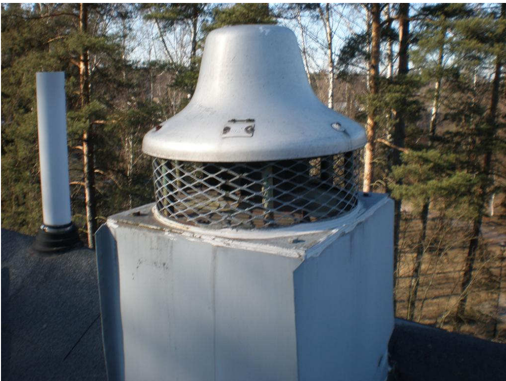
KUVA 10. Numeroimaton huippuimuri, turvakytkin puuttuu.
