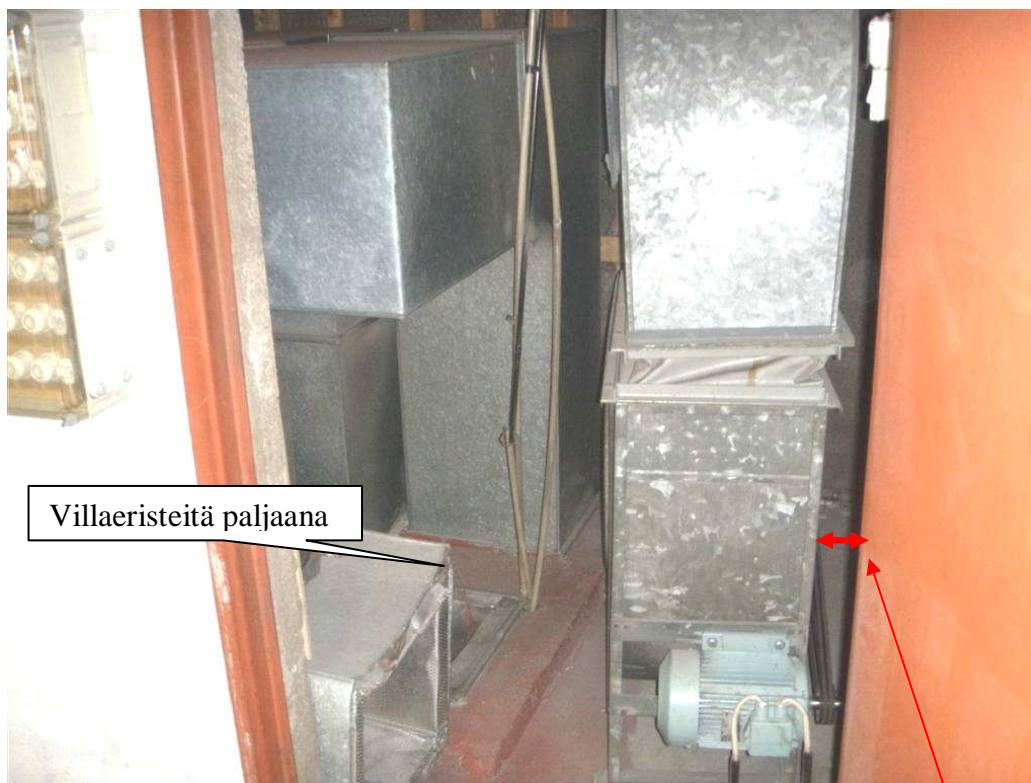
KUVA 4. PK1 konehuoneen huoltotilat ovat huonot, hihnoja / hihnapyöriä vaihdettaessa tai puhaltimen siipiä puhdistaessa.
