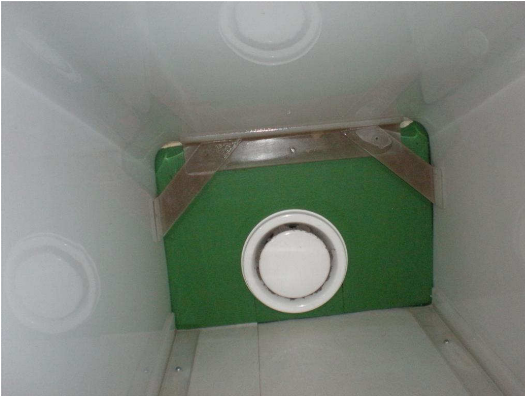
KUVA 15. Baaritilaa palvelevan liesikuvun venttiili on puhdistuksen tarpeessa.
