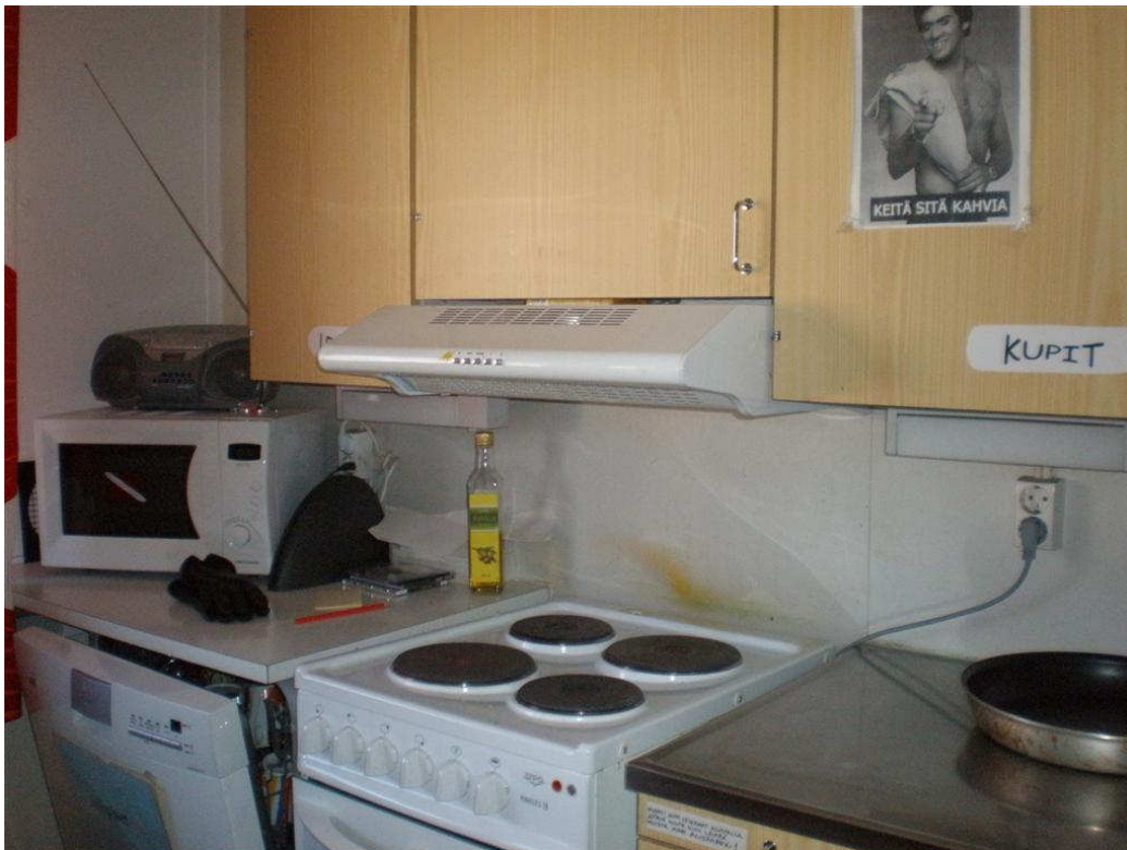
KUVA 11. Aktiivihiihdepuodattimella varustettu liesituuletin ei vedä.
