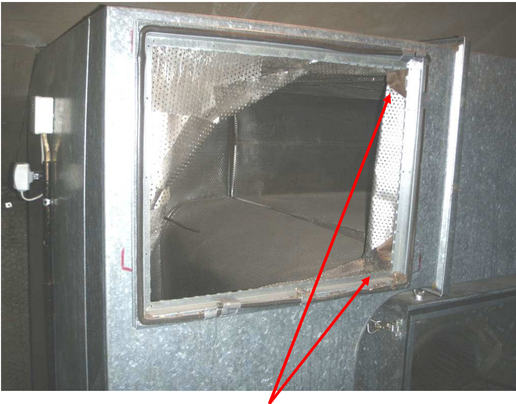
KUVA 3. PK1 poistoilmakoneelle tulevassa vaakakanavassa hieman paljaita villapintoja. ( poistoilma ei mene kiertoön)
