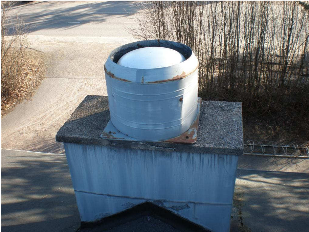
KUVA 6. PF2. Huippumuri, turvakytkin puuttuu.
