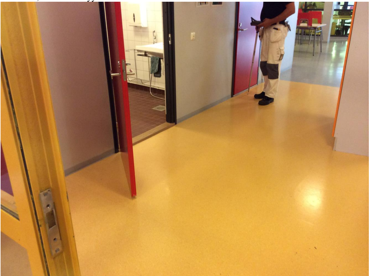
- koulun käytävää, lattioiden vaurioalueet kartoitettiin pintakosteusmittauksin
