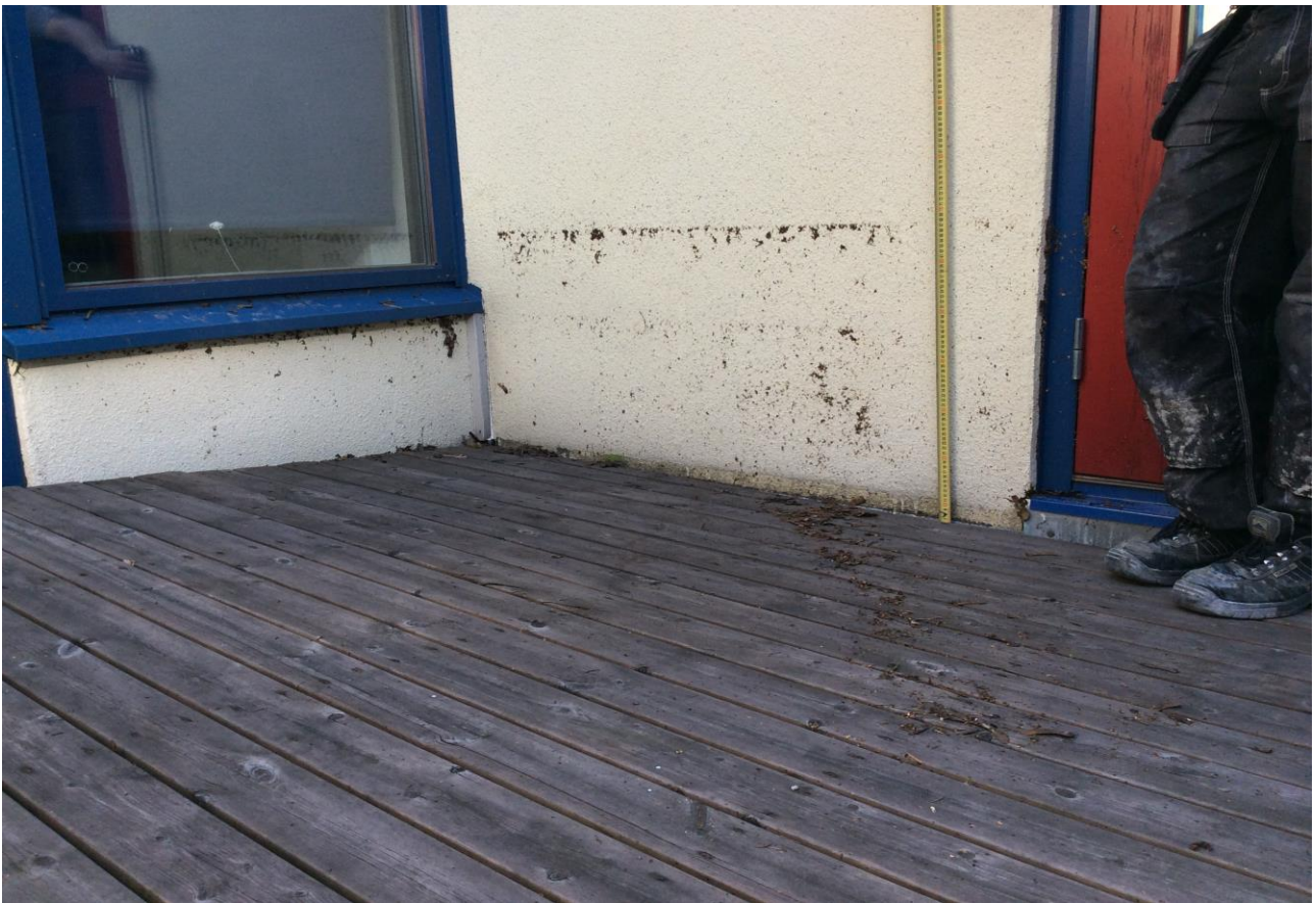
- atrium 1, seinässä näkyy selvästi kuinka korkealle vesi nousi
