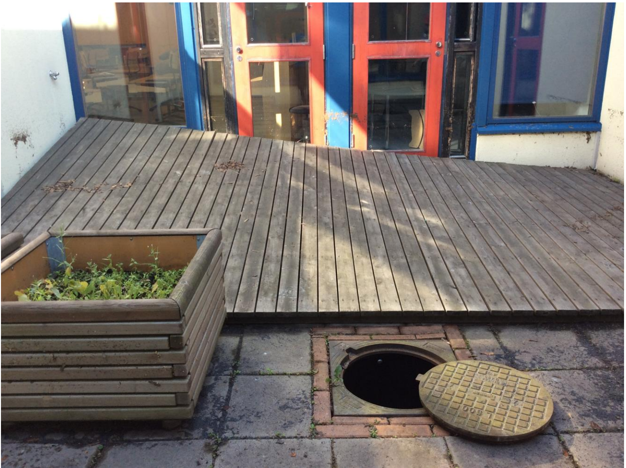
- atrium 1, kaivon kansi ja terassilaudoitus noussut veden voimasta
