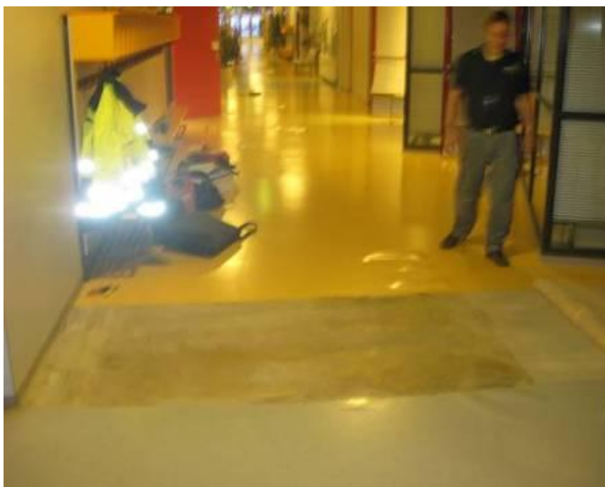
Kuva 8. Hiekkaharjun koulun pääkäytävän avatun mattovuodan alta näkyvä tumma betonilattian osuus on uutta viemäriinjan yläpuolista lattiarakennetta, jossa betonilaatta on valettu suoraan täyttöaineksen päälle (suodatinkangas välissä).
