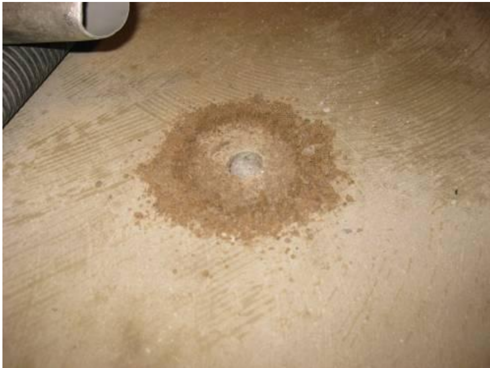
Kuva 15. Hiekkaharjun koulu, uuden viemäriinjan uuden alapohjarakenteen täyttöaines sisältää runsaasti hienoainesta. Kuva on otettu rakennetarkastelukohdasta B alapohjan läpiporauksen jälkeen.
