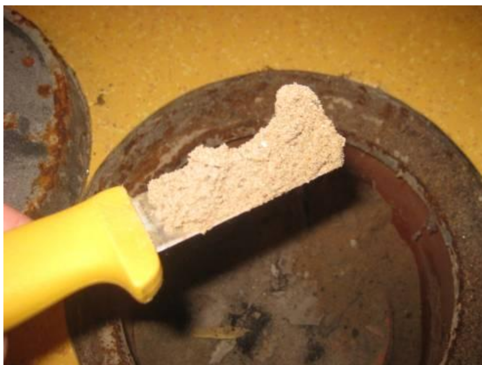
Kuva 17. Hiekkaharjun koulu, pääkäytävän 1100 viemärin tarkastusluukun kohta. Alapohjan täyttöaines sisältää hienoainesta.
