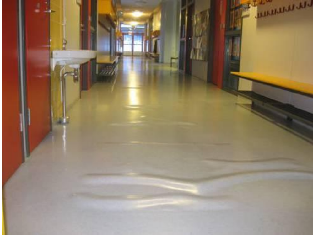
Kuva 5. Hiekkaharjun koulun sivukäytävän C mattokupruja (peruskorjauksessa asennettu kumimatto).
