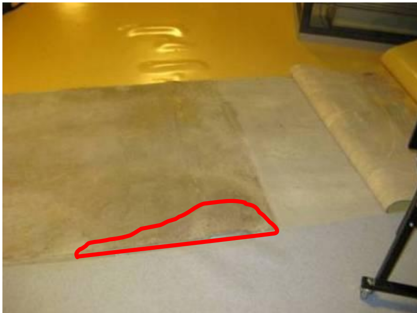
Kuva 7. Hiekkaharjun koulun pääkäytävän avatun kumimattovuodan kohta. Mattojen saumakohta on ollut auki. Vettä ja likaa on päässyt mattojen saumakohdasta mattojen alle (rajattu kuvaan punaisella viivalla). Kuvassa tummana näkyvä suorareunainen betonilattiaosuus on kohdasta tehtyjen läpiporausten perusteella uutta viemäriinjan yläpuolista lattiarakennetta, jossa betonilaatta on valettu suoraan täyttöaineksen päälle (suodatinkangas välissä). Tummunut alue vaaleni maton aukioloaikana, joka osoittaa maton alapuoleisen kosteuden olleen hyvin korkea.
