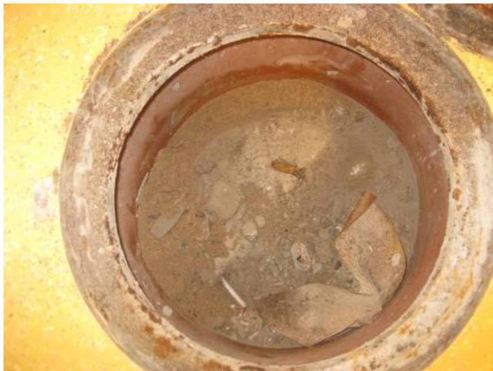
Kuva 16. Hiekkaharjun koulu, pääkäytävän 1100 viemärin tarkastusluukun kohta. Alapohjan täyttöaines sisältää hienoainesta.
