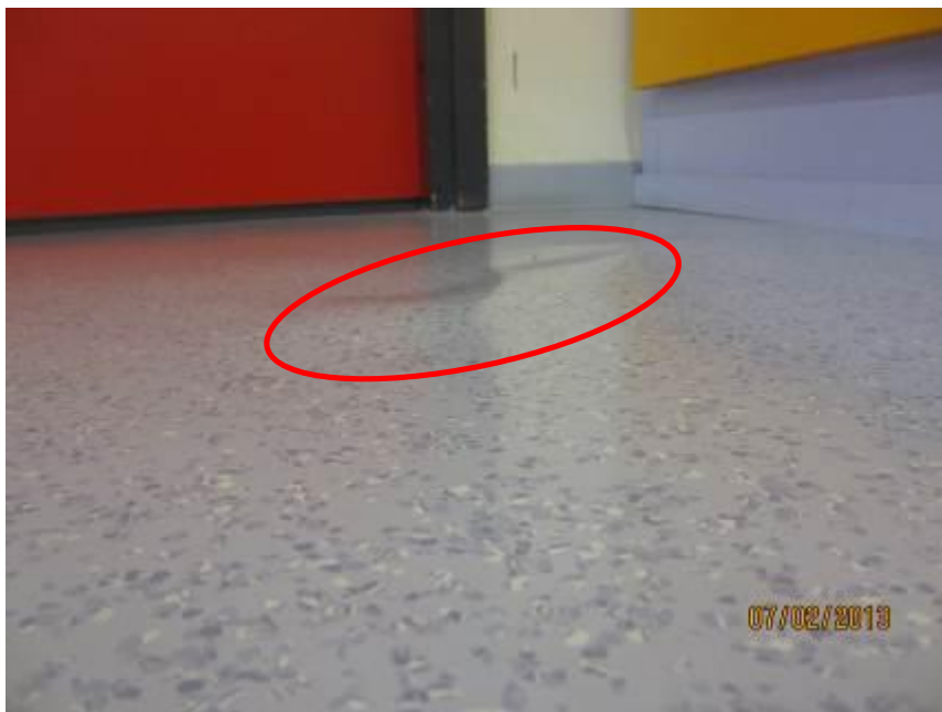
Kuva 2. Hiekkaharjun koulu, luokan 1224 lattiapäällysteen kupruilukohta on ympyröity kuvaan.
