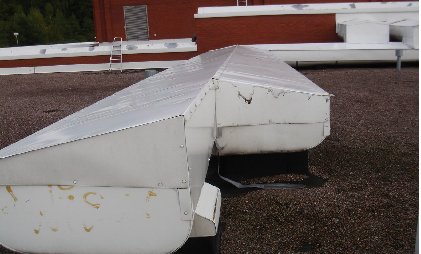
KUVA 25. Yleiskuva vesikatolla olevista ilmastointikanavista.
