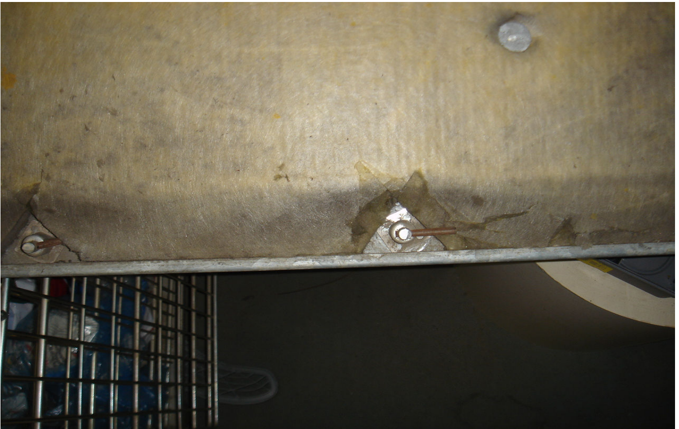
KUVA 16. Tuloilmakoneen kammiot on eristetty mineraalivillalla, joka on paikoin rikki.
