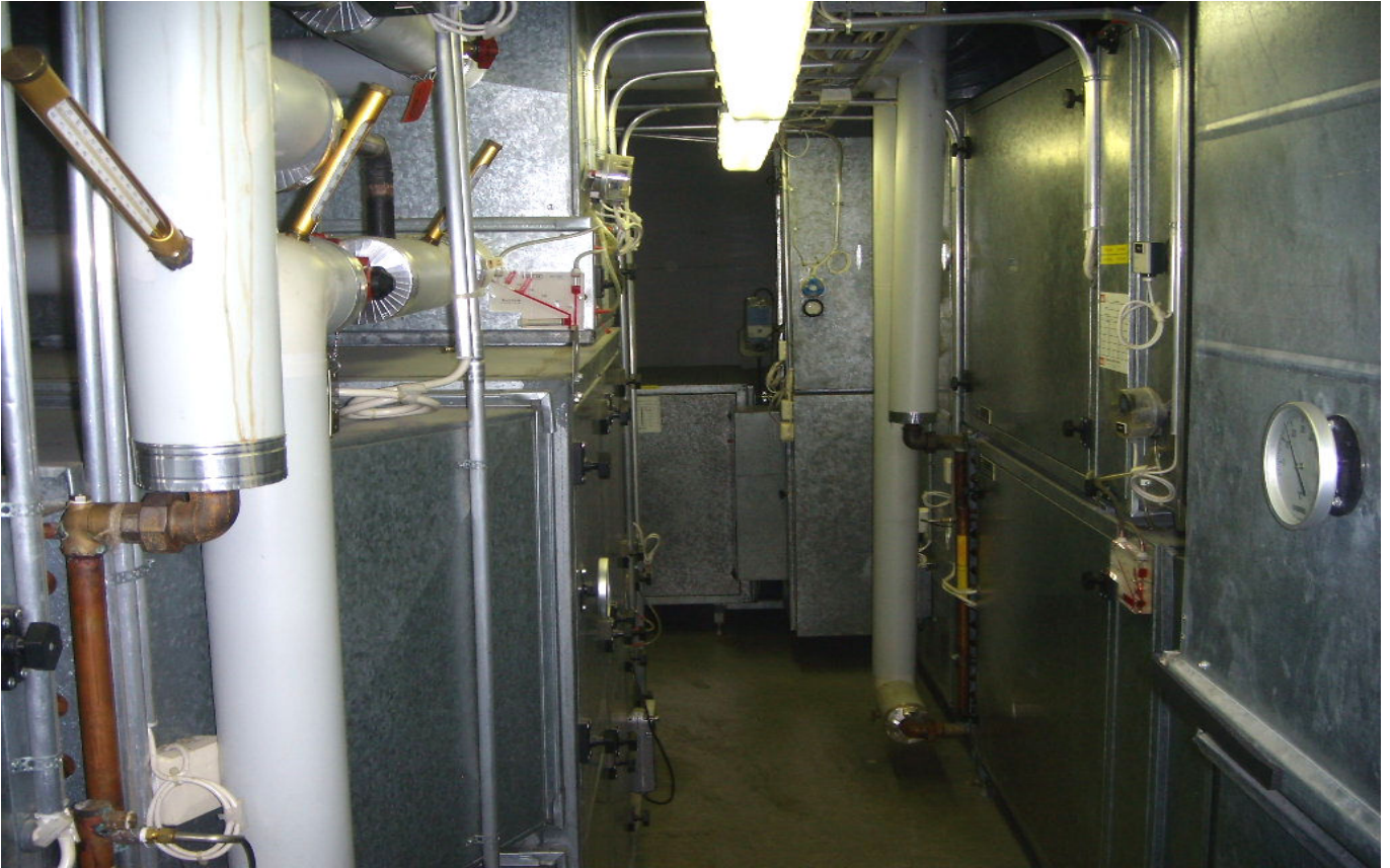
KUVA 1. Yleiskuva IV- konehuoneesta.
