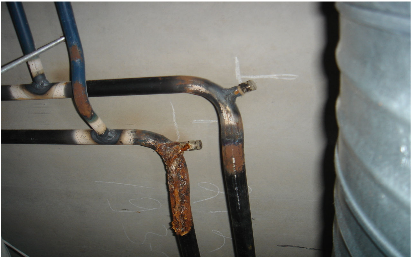
KUVA 28. Uuden puolen lämpöjohtoverkoston ilmanpoistiventtiili vuotaa.
