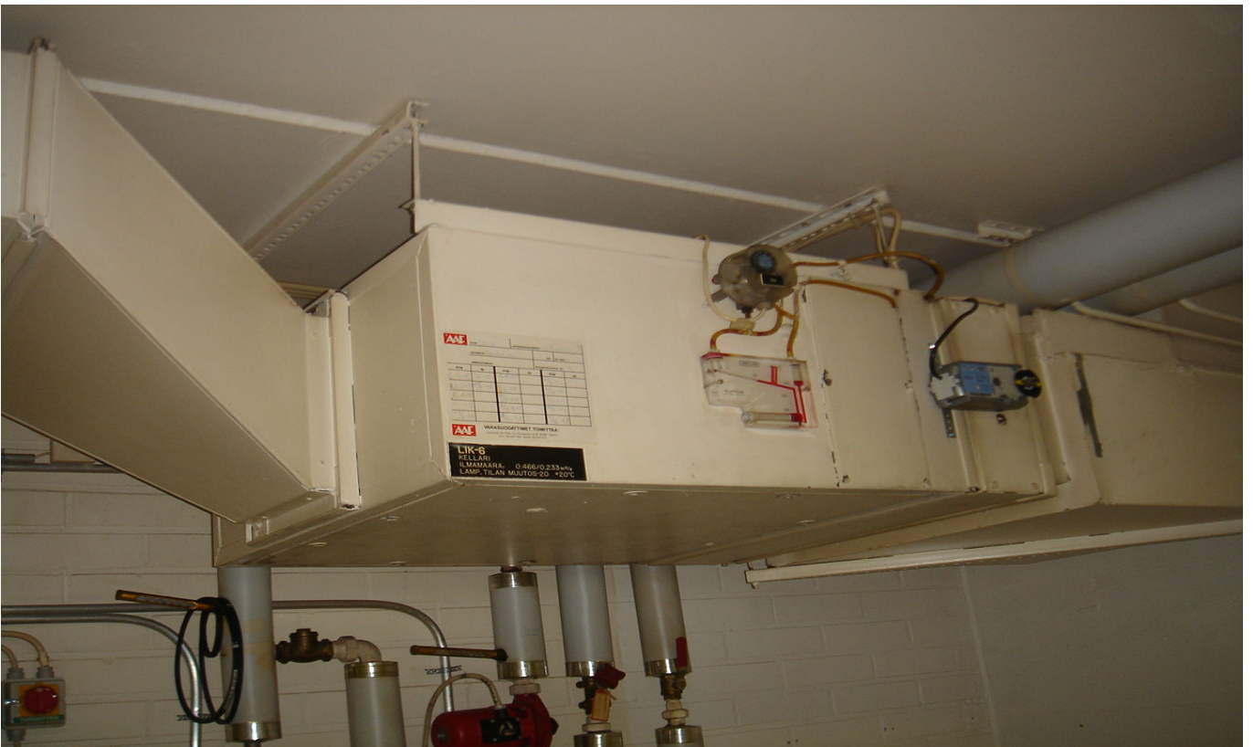
KUVA 2. Yleiskuva kellarin tuloilmakoneesta.
