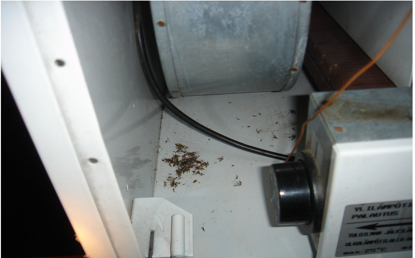
KUVA 19. Yleiskuva tuloilmakoneen kammiosta.
