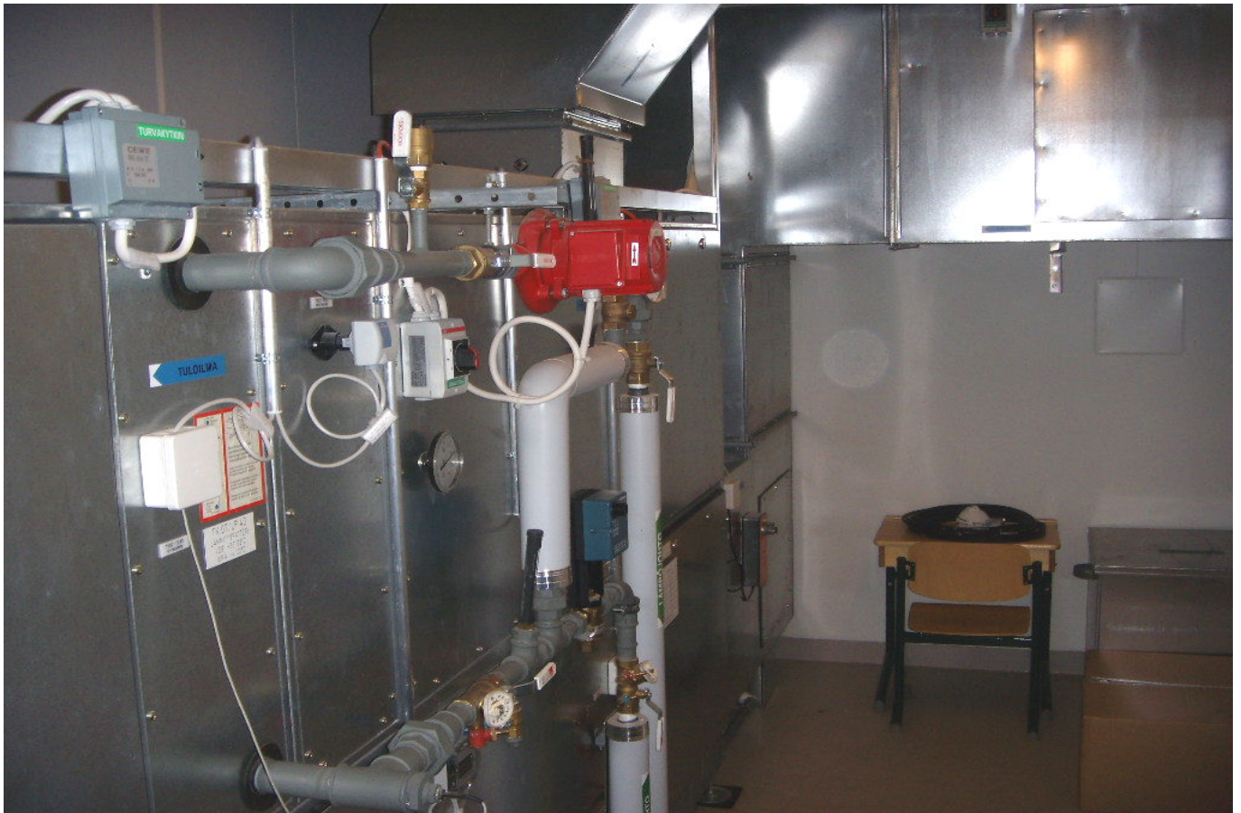
KUVA 3. Yleiskuva uuden puolen IV- konehuoneesta.
