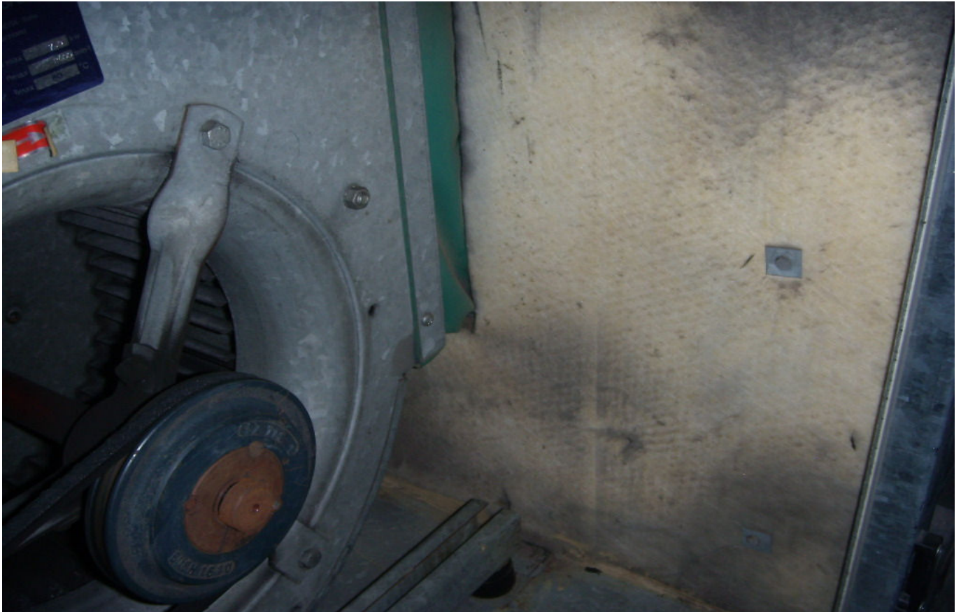
KUVA 7. Tuloilmakoneen kammiot on eristetty mineraalivillalla.
