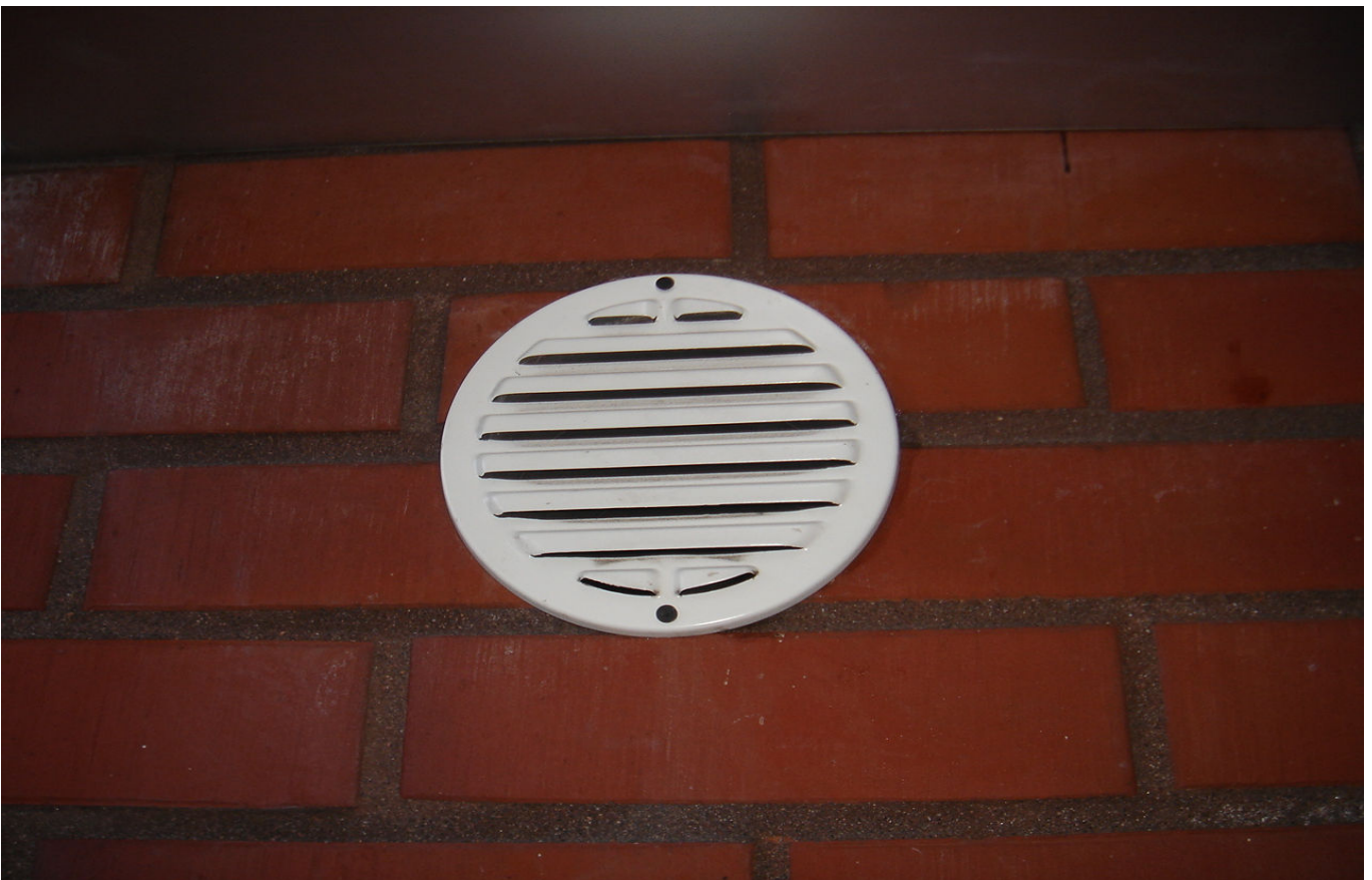
KUVA 18. Yleiskuva starttiluokan tuloilmakoneen ulkoilmasäleiköstä.
