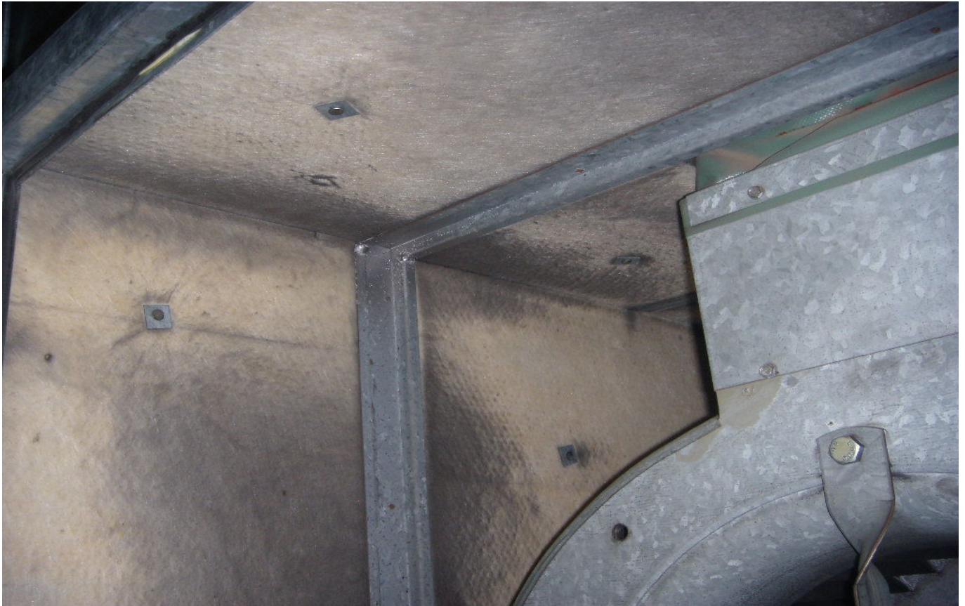
KUVA 5. Tuloilmakoneen kammiot on eristetty mineraalivillalla.
