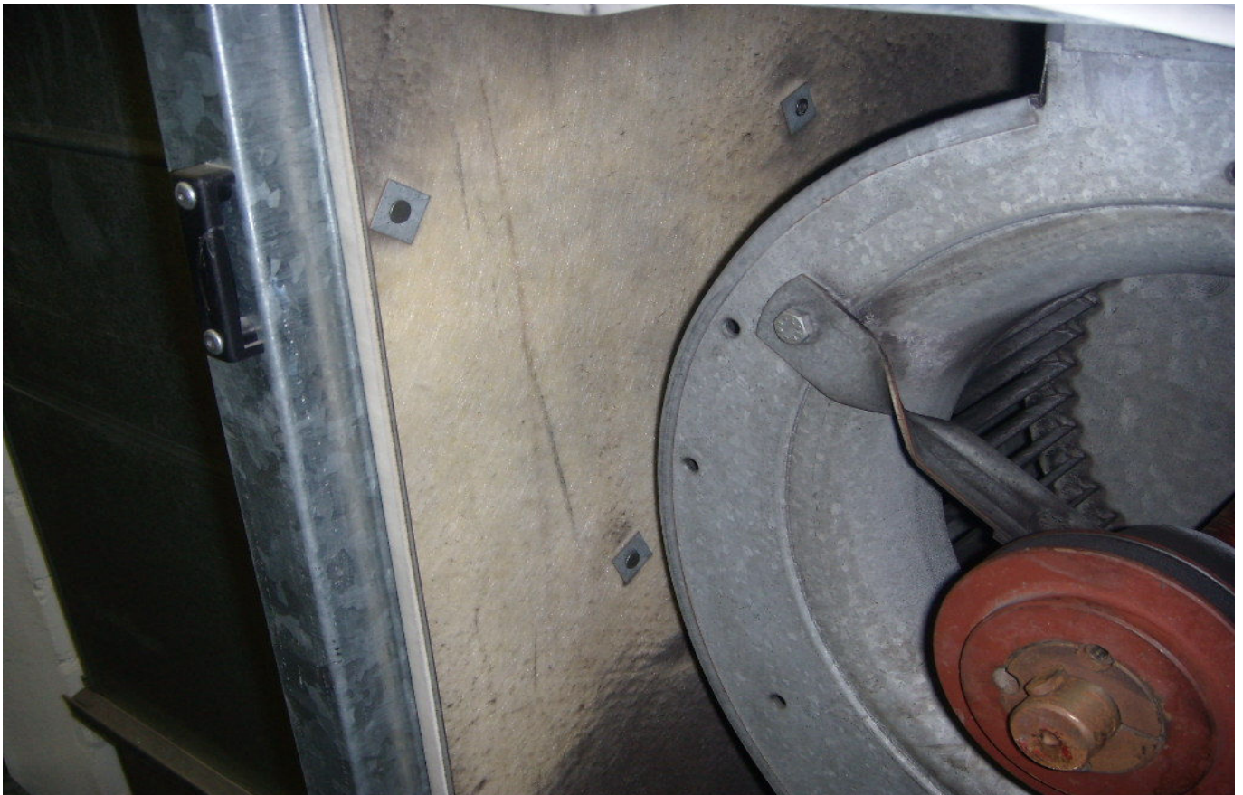
KUVA 14. Tuloilmakoneen kammiot on eristetty mineraalivillalla.
