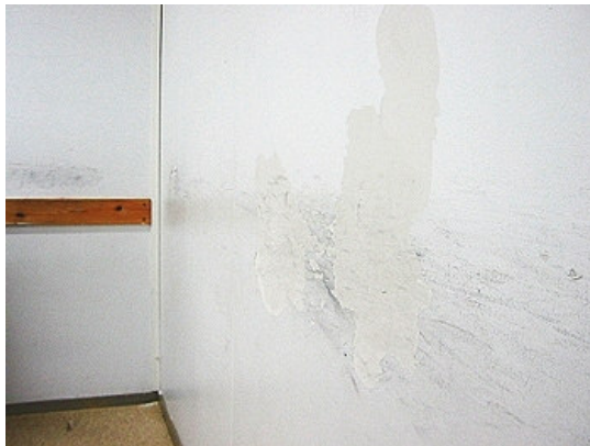
Kuva 3 Sisäseinissä pintamaali irtoili alustastaan.
