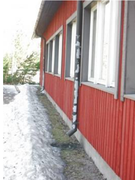
Kuva 6 Takasivun syöksytorvista tuleva vesi tulisi johtaa kauemmaksi rakennuksesta.
