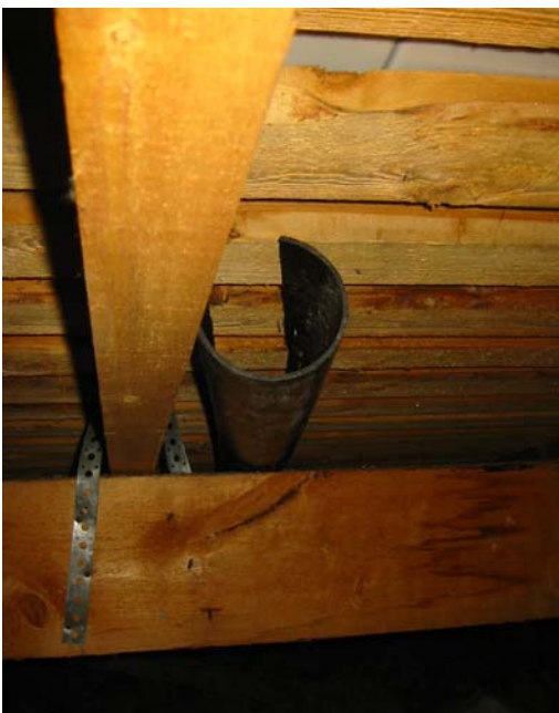
Kuva 19. Kuvan 18 yläpuolella vuotavan hakasauman kohdalla asennettu viemäriputki johtamaan vuotovesi ulkoseinän ulkopuolelle.
