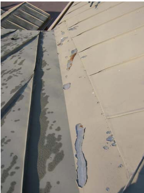
Kuva 11. Sisäjiirin pinnoite – ja korroosioaurioita.
