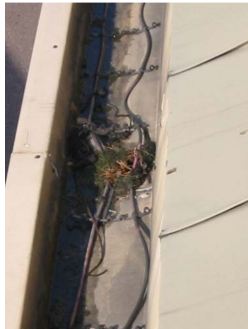
Kuva 12. Lämmityskaapelit ovat irronneet kiinnityksistään ja tukkineet roskien kanssa syöksytorven.
