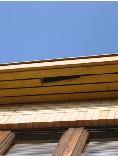
Kuva 23. Räystäslaudoitus vaurioitunut ilmeisesti vuotavan räystäskourun takia.
