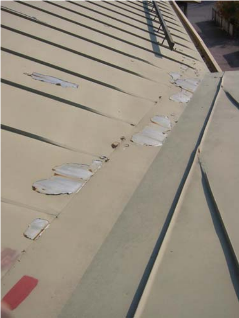
Kuva 21. Sisäjiirin pinnoite – ja korroosiovaurioita.
