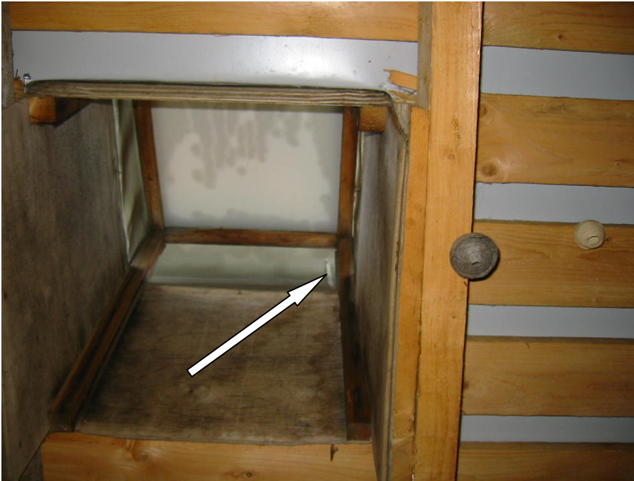
Kuva 3. Yläpohjan tuuletuslaatikon hyönteisverkossa on reikä, vieressä ampiaisesiä.
