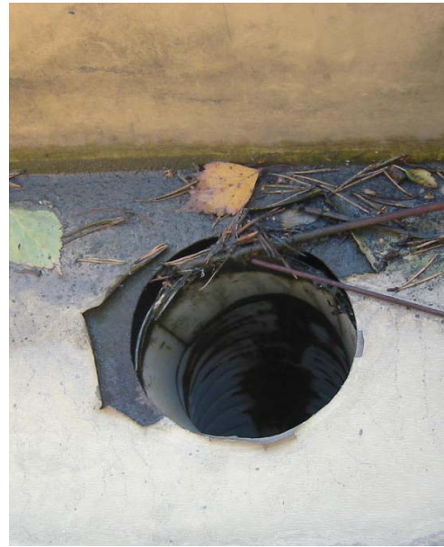
Kuva 10. Räystäskourun ja syöksytorven liitos on toteutettu ilman peltiäilytystä ja liitos vuotaa alla oleviin räystäsrakenteisiin (ks. kuva 13).
