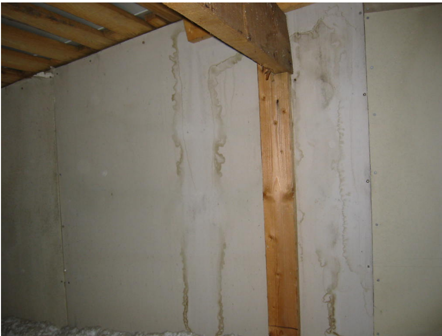
Kuva 4. Yläpohjan ontelossa palo-osastoivan seinärakenteen levypinnalla vuotovesien synnyttämiä valuma- jälkiä.
