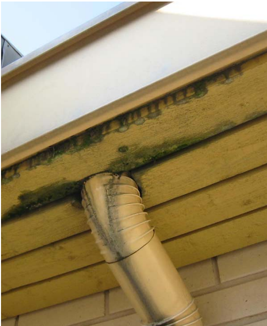
Kuva 13. Vuotavan syöksytorven liitoksen alapuolinen räystäsrakenne kosteusvaurioitunut (vrt. kuva 10), vuotoa ei tapahdu seinärakenteeseen eikä huonetiloihin.
