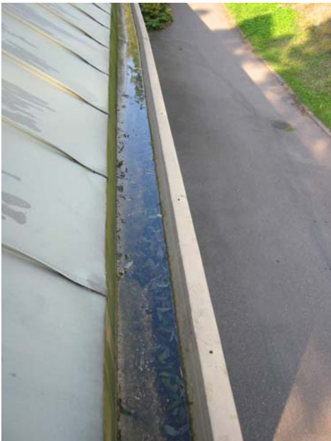
Kuva 15. Räystäskourujen kaadot ovat vähäiset eivätkä aina syöksytorvia kohden, vesi jää kouruihin ja kerää roskia.
