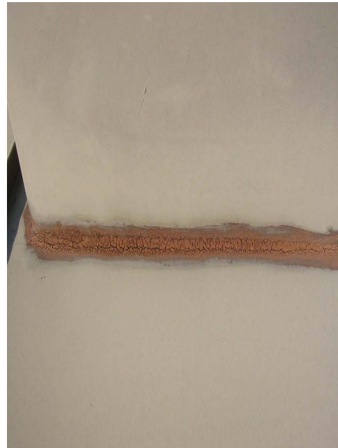
Kuva 16. Vesikatteen läpivientien liitosten tiivistemassat ovat yleisesti pahoin halkeilleet.
