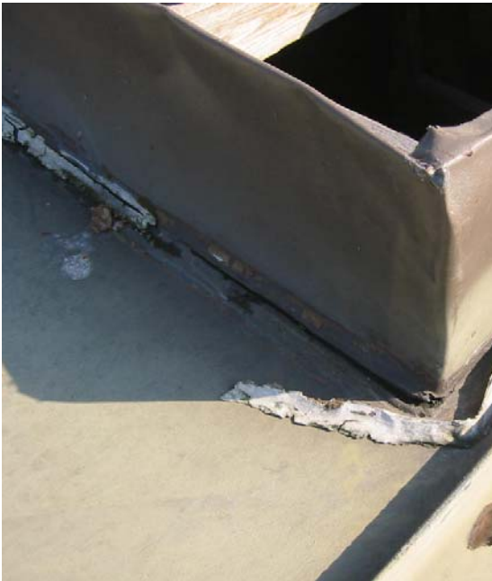
Kuva 17. Kattoluukun pellityksen ja katepellityksen tiivistemassat ovat irtoilleet ja peltien sauma avoinna. Sadevedet pääsevät alusrakenteisiin.
