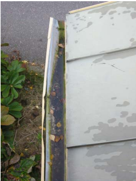
Kuva 7. Räystäskourut ovat yleisesti roskaisia.
