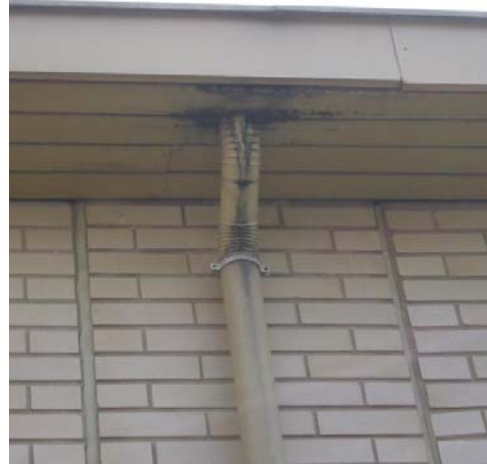
Kuva 22. Syöksytorven vuotovaurion synnyttämiä kosteusjälkiä.
