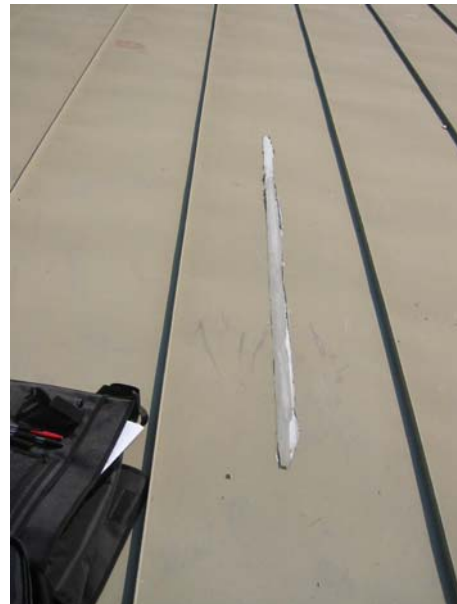
Kuva 8. Konesaumatus peltikatteen pinnoitevaurio (maalipinnoitteen hilseilyvaurio).
