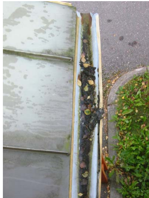
Kuva 6. Sisäänkäyntikatoksen räystäskourut ovat vaurioituneet lumen ja kouruun jäätyvän veden seurauksena. Katoksien räystäskouruja ei ole varustettu syöksytorvilla, vaan sadevedet tippuvat suoraan katoksen edustalle.
