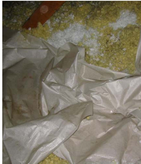
Kuva 18. Yläpohjan ontelossa on vuotokohdan alle laitettu aluskate eristeiden päälle. Aluskatteen päältä löytyi vettä. Vuotokohta on ilmeisesti pellin hakasauma (ks. kuva 19).
