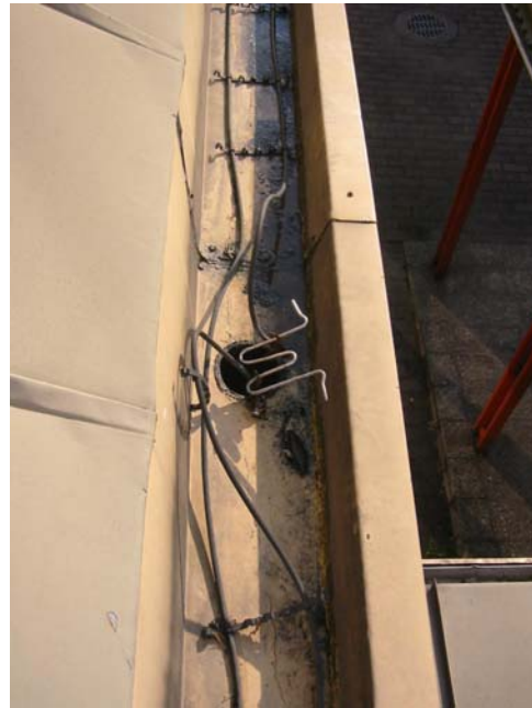
Kuva 14. Lämmityskaapelit ovat irronneet kiinnityksistään syöksytorven ympärillä.
