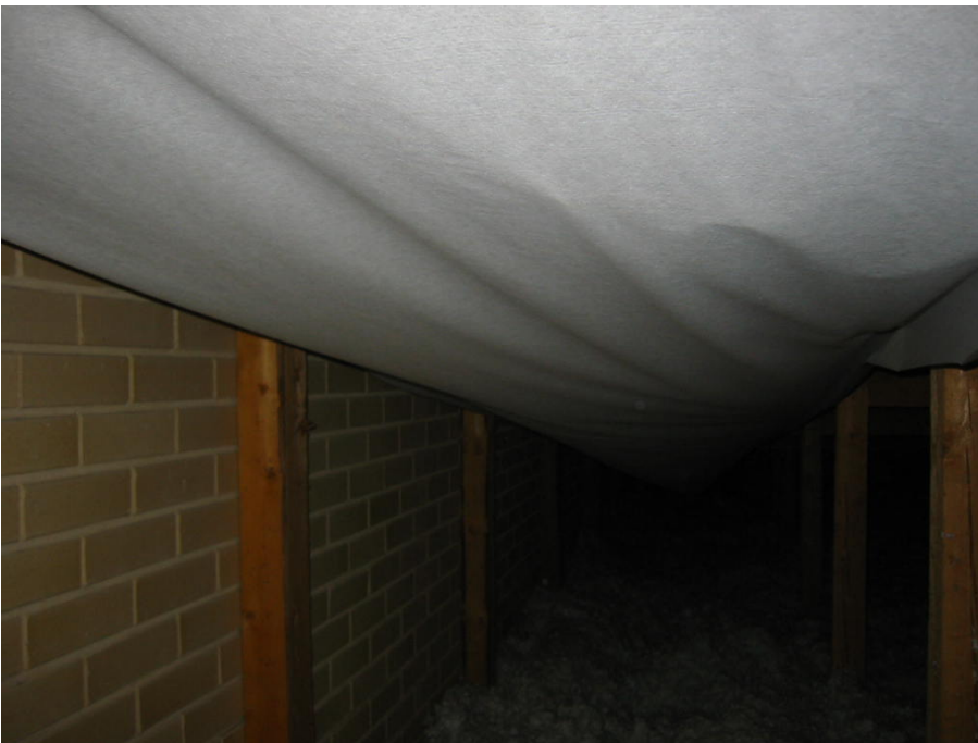
Kuva 2. Vuotokohtaa on paikattu lisäämällä aluskate yläpaarteiden väliin. Tässä kohdassa aluskate on asennettu niin, että vuotovedet valuvat asianmukaisesti ulkoseinän ulkopuolelle.
