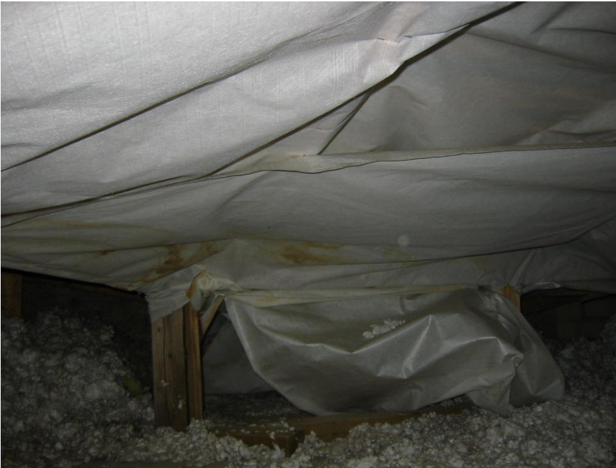
Kuva 1. Jiirin vuotokohtaa on paikattu myöhemmin asennetulla aluskatteella. Vuotokohdasta aluskatteelle valuva vesi ei pääse poistumaan alaräystäään kautta. Lisäksi vuotokohdan alta on poistettu eristeet niin, että ontelolaatan pinta on näkyvissä (vuotokohdassa yläpohjarakenne on eristämätön).
