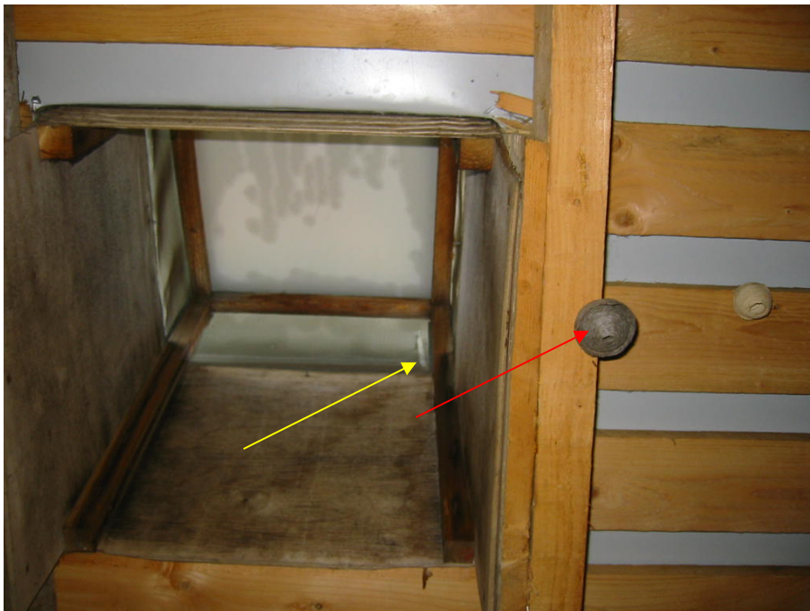
Kuva 3. Yläpohjan tuuletuslaatikon hyönteisverkossa on reikä (keltainen nuoli), josta hyönteiset pääsevät yläpohjan onteloon (punaisella nuolella merkitty ampiaispesä).
