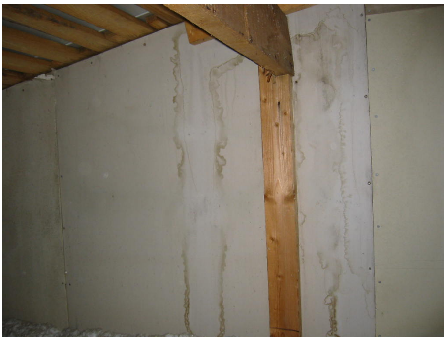
Kuva 4. Yläpohjan ontelossa oli havaittavissa palo-osastoivan seinärakenteen levypinnalla vuotovesien synnyttämiä valumajälkiä.
