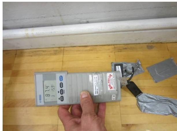
Kuva 36. Salin lattian tb-laatan kosteus koholla rakennelämanäytepaikan kohdalla PR2. Täältä kohdin tarkasteltiin lattian rakennetta.
