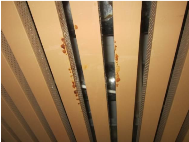
Kuva 23. Vuotojälkiä käytävän 253 alakatossa luokan 262 kohdalla.
