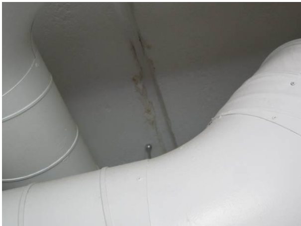
Kuva 25. Vuotojälkiä ontelosaumassa var 257B.
