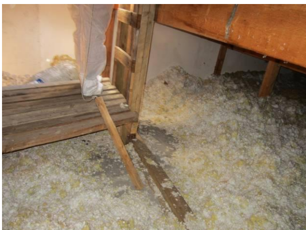
Kuva 13. Eristettä puuttuu kattoluukun alla arviolta tilan 258 yläpuolella.
