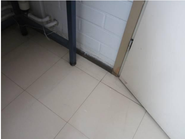
Kuva 29. Maalivaurio tiiliseinän alaosalla kuvaa- mataito 117/ pimiö 120 väliseinä.
