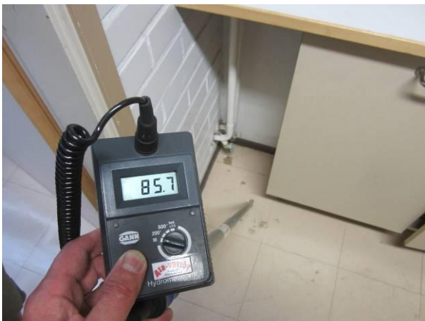
Kuva 35. Lattian pintakosteus hieman koholla pimiö 120, tästä tehtiin porareikämittaus PR1.
