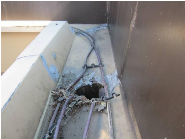
Kuva 5. Epämääräisiä tiivistyksiä, pieni lähtöreikä syöksytorveen.
