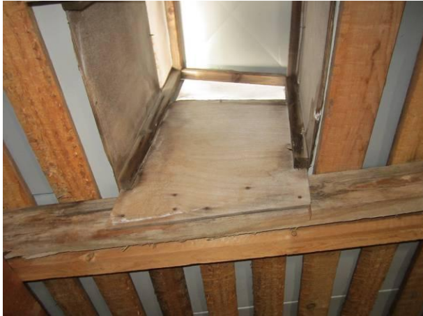
Kuva 9. Salin 017 ullakon tuuletuspiippu, vesijälkiä kotelon puuosissa.
