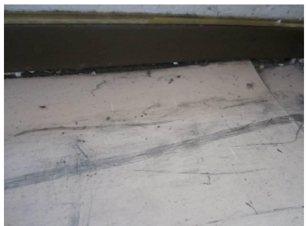
Kuva 28. Ulkoseinävierellä vinyylilaattoja on irti, muurahaisia tilat 227 ja 228, alla on maanvarainen laatta, voi olla ilmayhteys.
