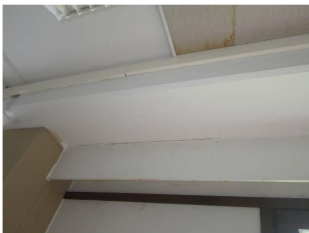
Kuva 27. Vuotojälkiä levyrakenteisella ulkoseinällä ja katossa tila 227. kohdalla, vastaavaa on myös kirjasto 228 kohdalla.
