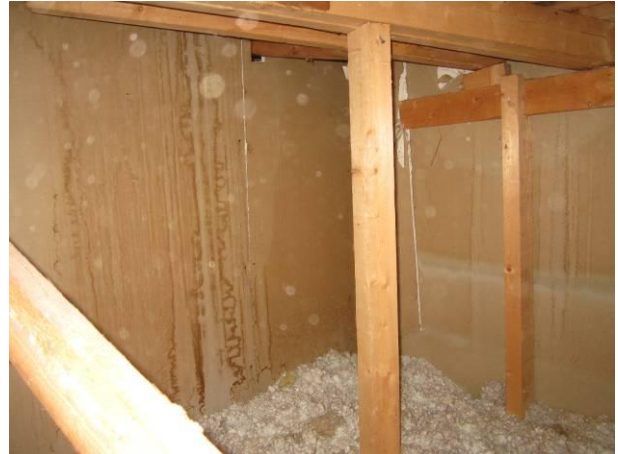
Kuva 10. Vesijälkiä salin 017 sivulla jiirin alla olevissa palokatkoseinissä.
