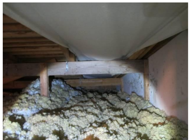
Kuva 14 Aluskatelisäys sisätilojen vuotojäljelinjalla tilan 257 yläpuolella.
