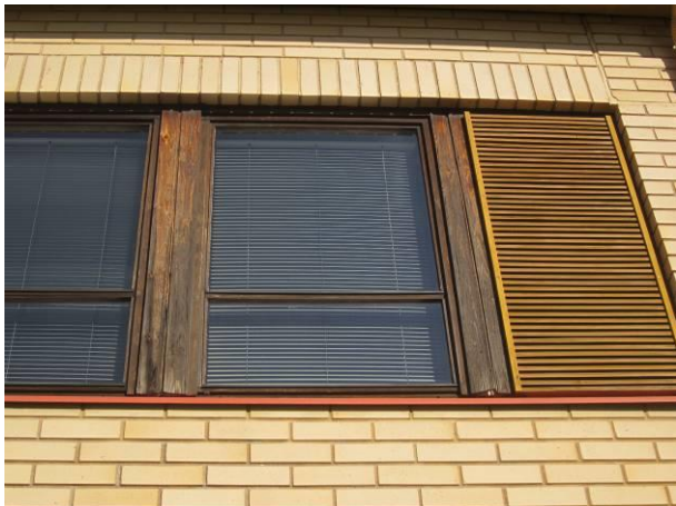
Kuva 19. Kuluneet ikkunan puuosat, ikkunavälien peitelaudat ovat käpertyneet.
