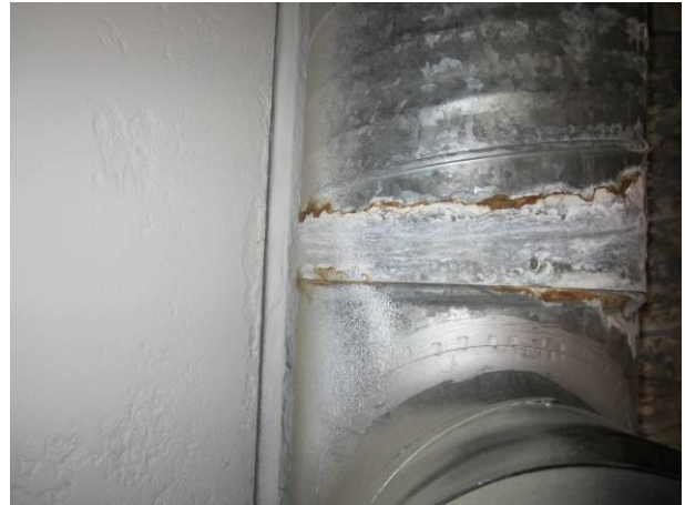
Kuva 24 Käytävän vuotojäljen yläpuolella on vuotojälkiä lv-kanavassa ja ontelosauma.
