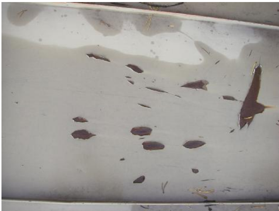
Vesikatolla esiintyy paikoin ruostejälkiä ja pinnoitteen hilseilyä.
