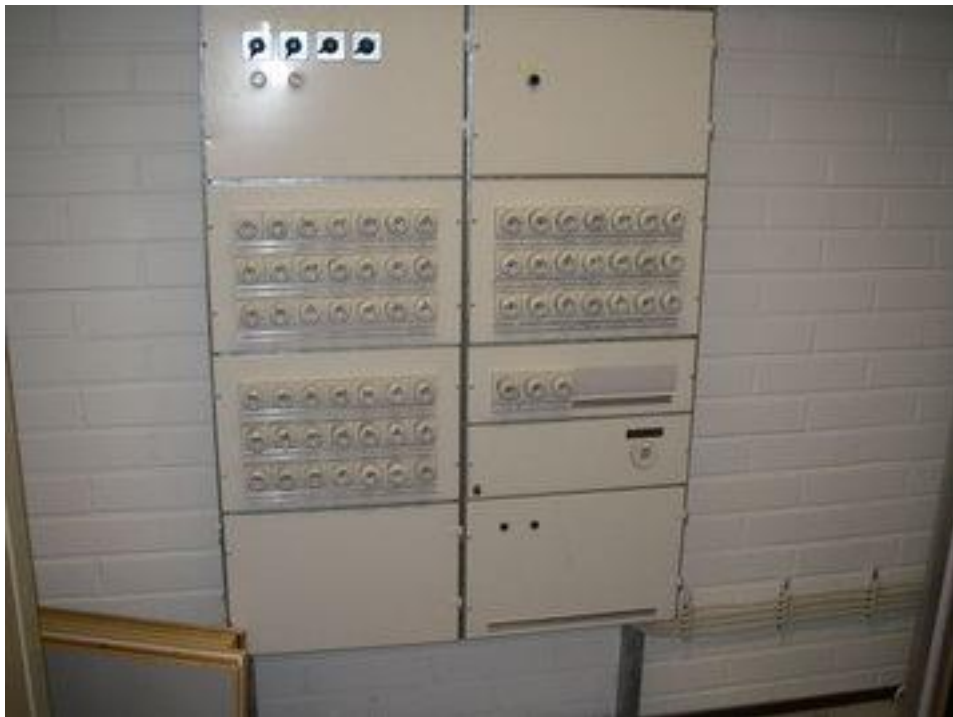
Ryhmäkeskus käytävällä on perinteinen tulppasulakekeskus.
