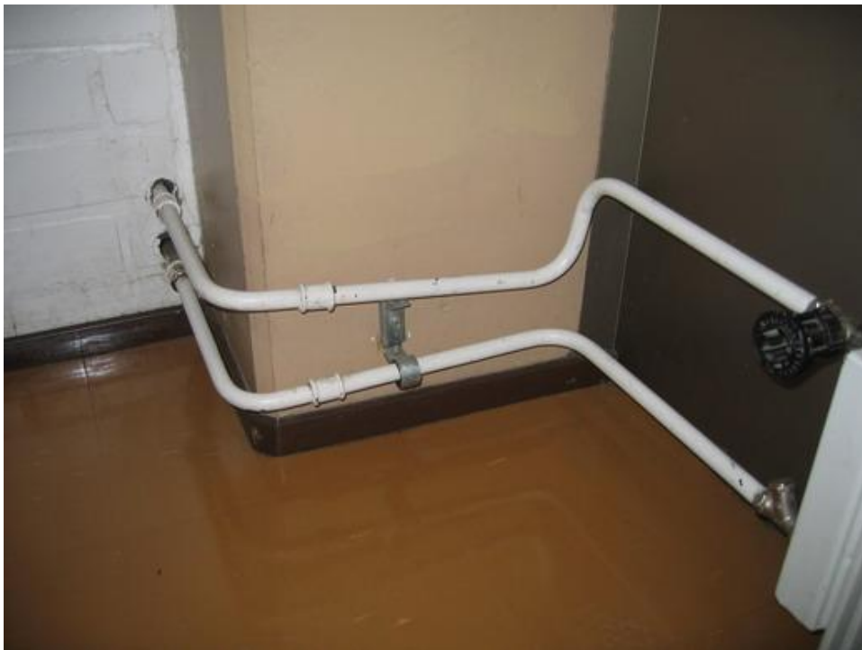
Käytävällä lämpöputken kannakointi on vajavainen.
