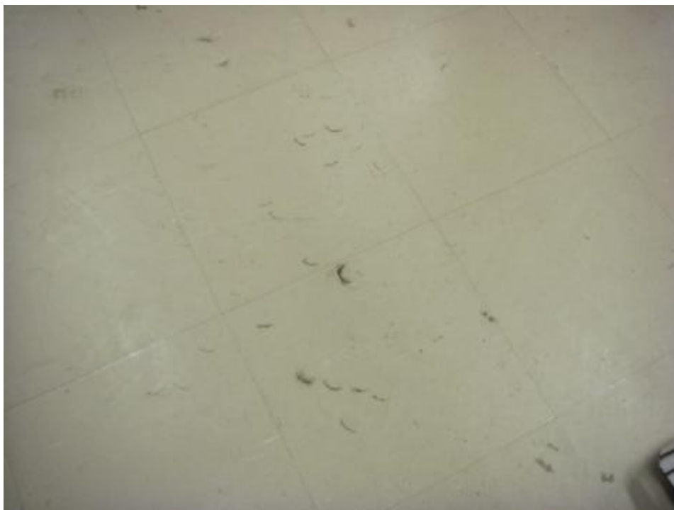
Luokkien lattioiden linoleum-laatoissa on paikoin vaurioita.
