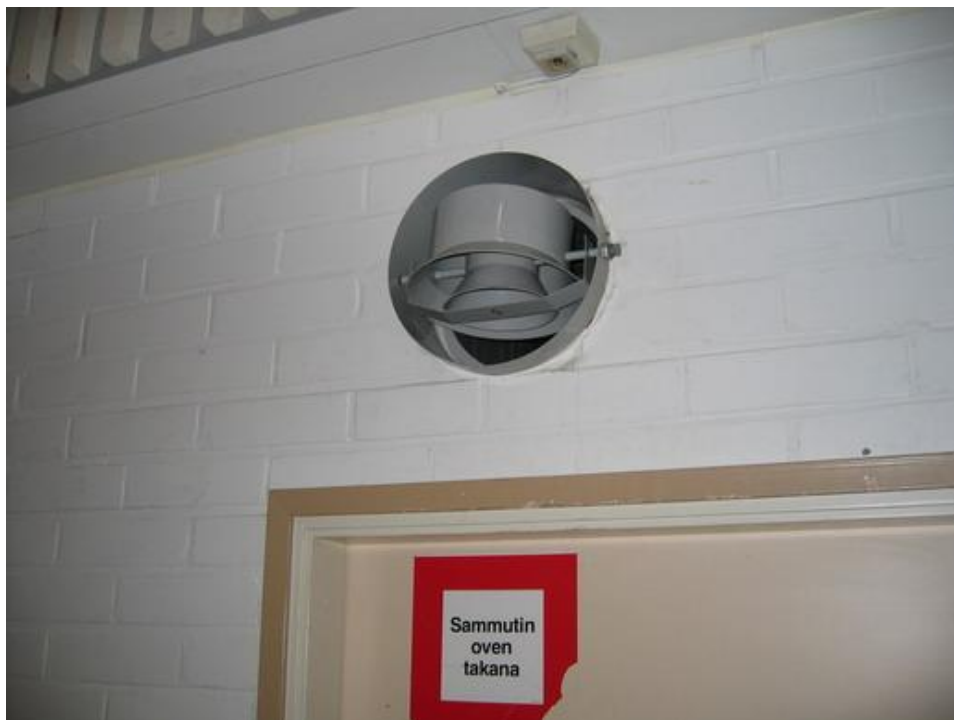
Tuloilmaelimen suuntaus on väärin.
