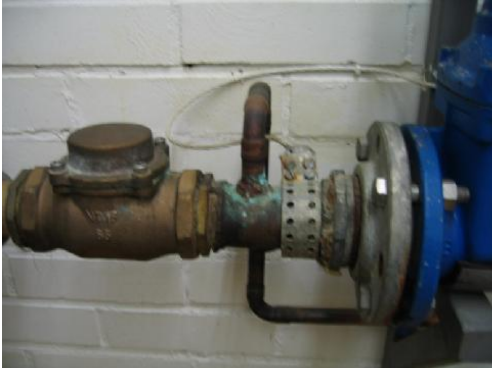
Vesimittarin kohdalla putket ovat hapettuneet.
