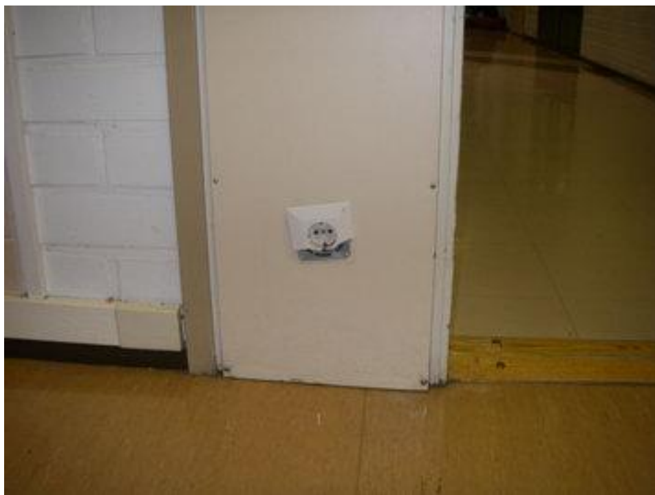
Ovenpielen pistorasian suojalevy on haljennut.
