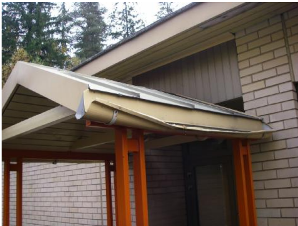
Katosten räystäskourujen painumat tulee korjata.
