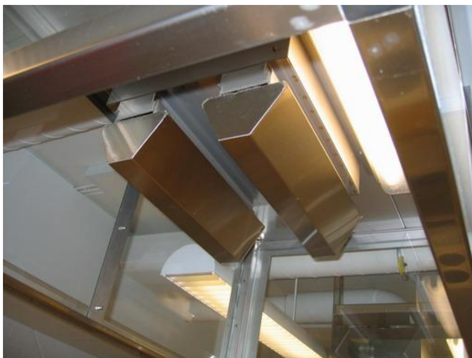
Kotitalousluokan huuvasta välittyy häiritsevää ääntä.
