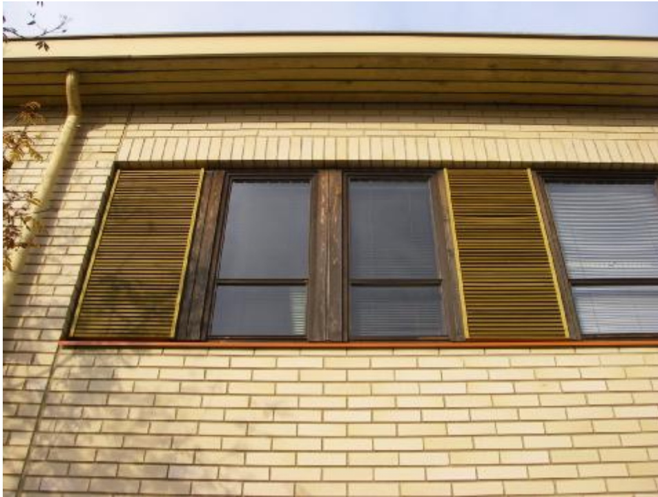
Puuikkunat vaativat kunnostus- ja huoltotoimenpiteitä.
