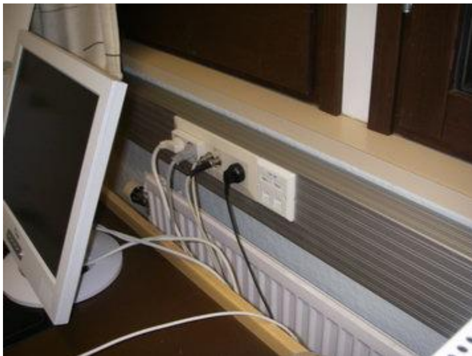
Pistorasiat on asennettu metallikanaviin.
