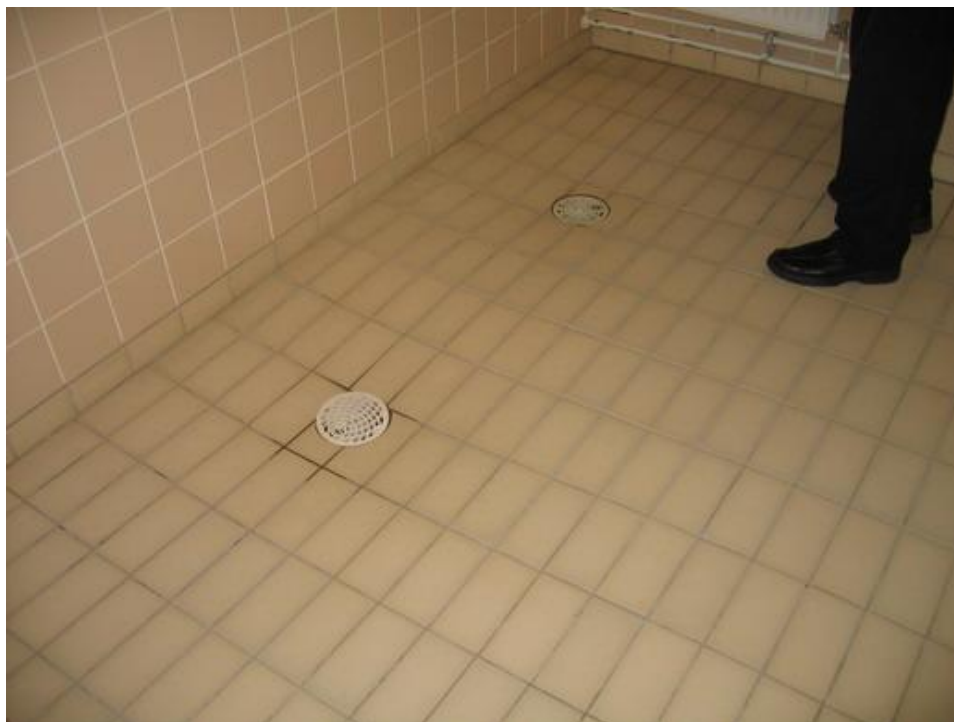
Oppilaiden suihkun viemäreille tulee teettää painehuuhtelu.
