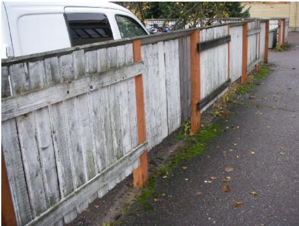
Puuaidat on syytä kunnostaa. Lahovaurioituneet puuosat uusitaan.
