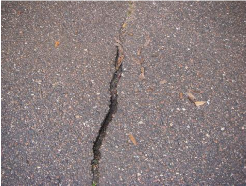
Asfalttipäällysteessä on paikallisia halkeamia.
