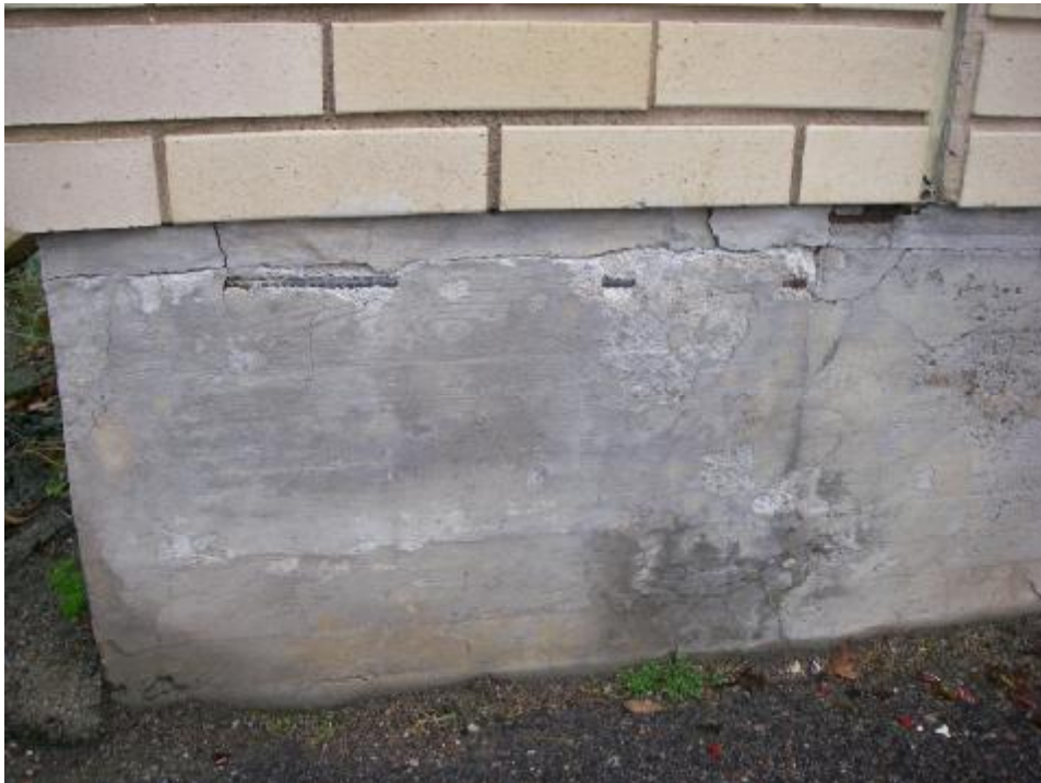
Sokkelipinnoissa olevat vauriokohdat vaativat korjaustoimenpiteitä.
