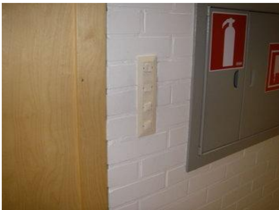
Valaistuksen kytkimet ovat alkuperäisiä.
