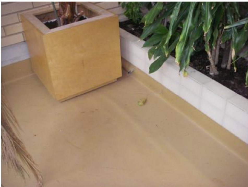
Viherhuoneen lattiassa havaittiin viitteitä kosteusvaurioista.
