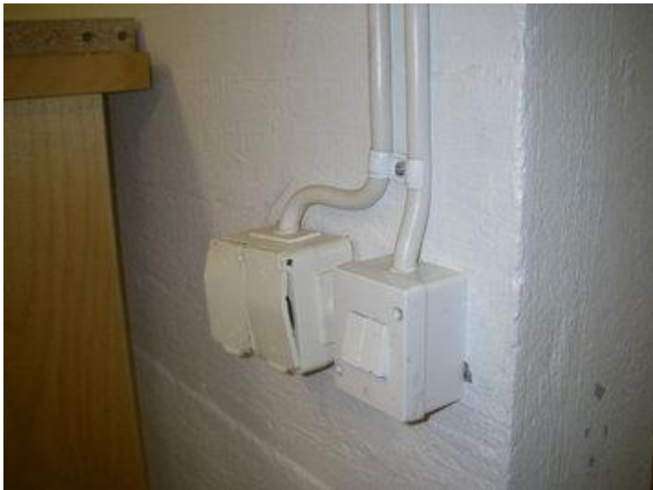
Väestönsuojan pistorasia on irronnut ja kansi on vääntynyt.
