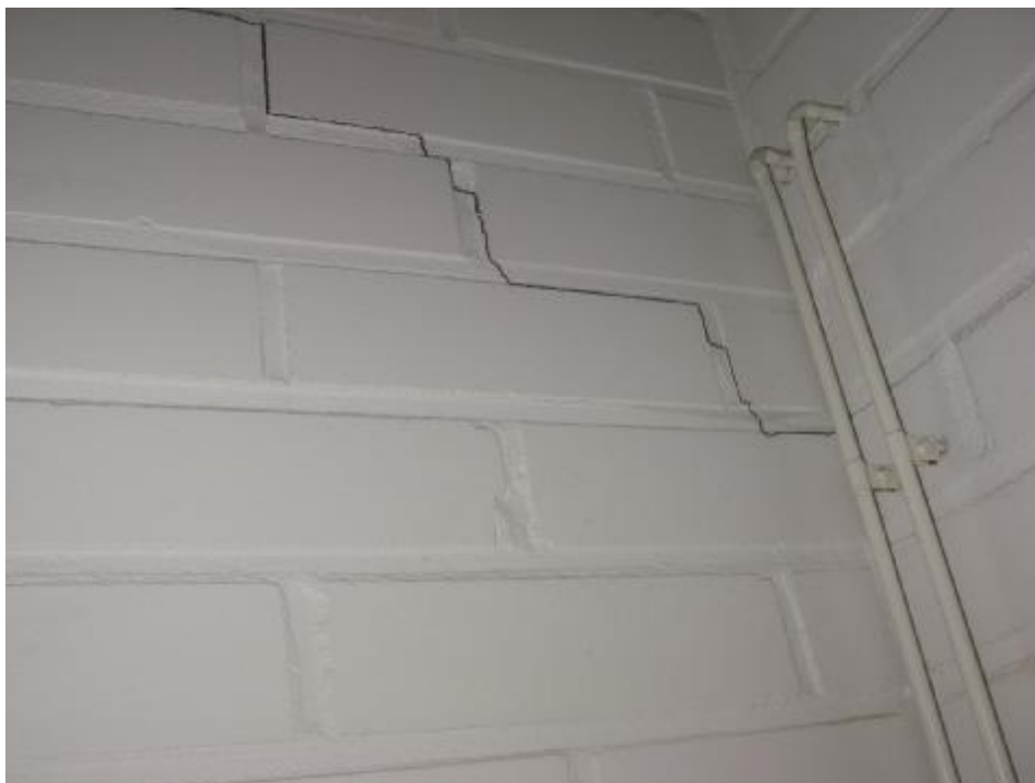
Väliseinissä on muutamia halkeamia.
