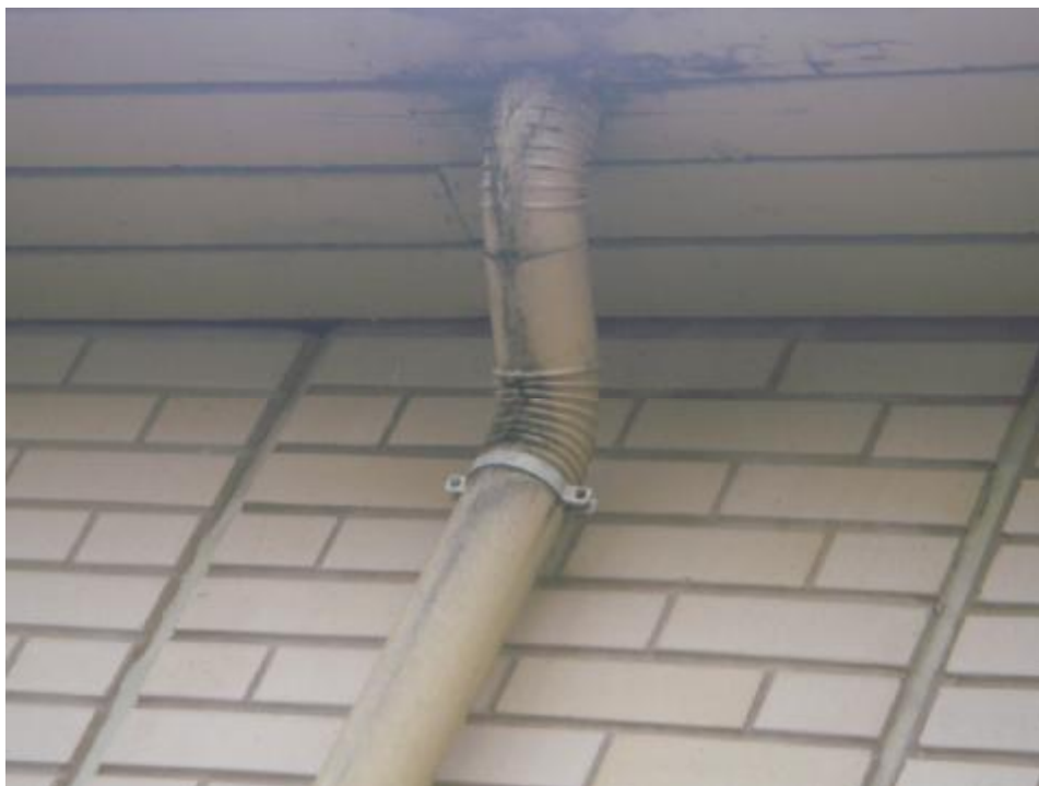
Räystäskouruissa on muutamia vuotokohtia.
