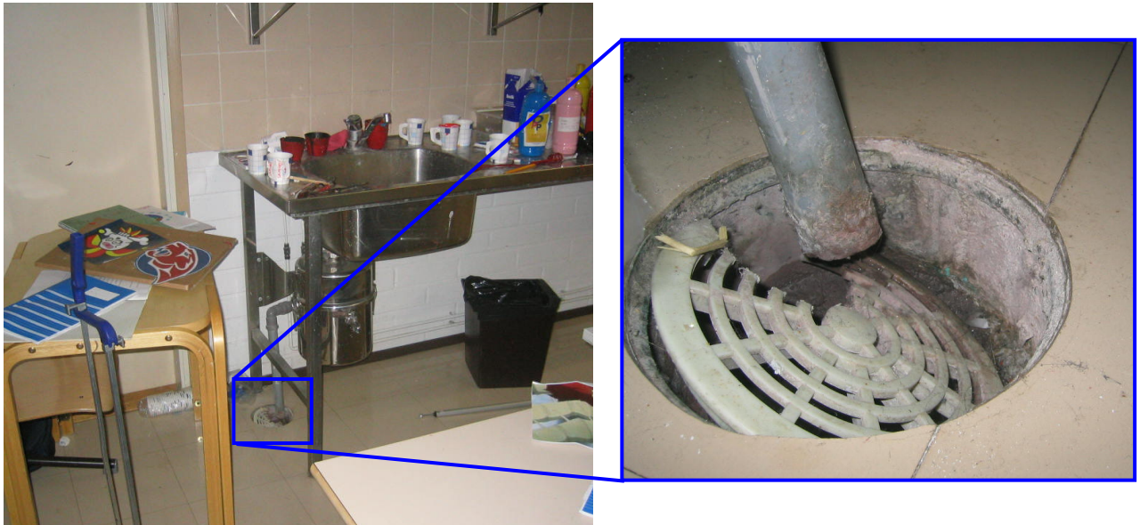
Kuva 17. Kuvaamataidon luokassa 118 lattiakaivossa oli puutteita.
