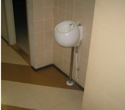
Kuva 5. Käytävällä 005 juomavesipisteen ympärillä havaittiin lattiassa kohonneita pintakosteuslukemia.
