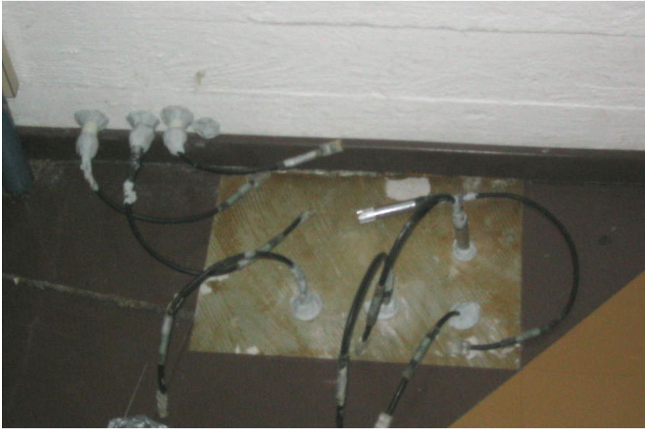
Kuva 8. Aulassa 002 seinän halkeaman kohdalla sijainneet porareikämittapisteet SI (seinä) ja PRI (lattia). Mittapäät ovat asennettuina mittausreikiin.
