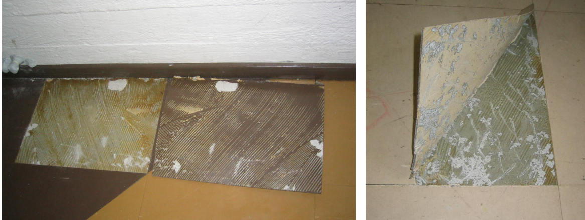
Kuva 13. Vasemmalla porareikämittapiste 1 ja oikealla porareikämittapiste 4. Molemmissa on ainakin laattasauman alueella havaittavissa todennäköisesti kosteuden kellastuttamaa liimaa.
