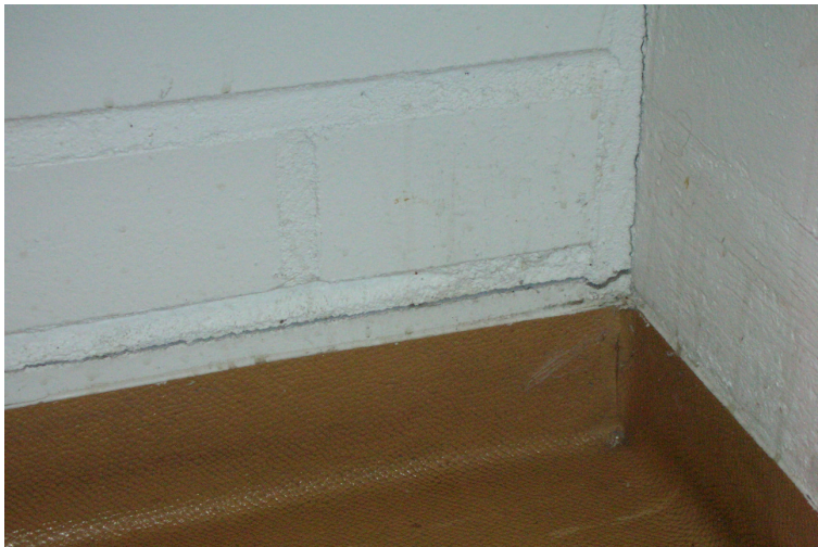
Kuva 12. Siivoojien sosiaalitulassa 050 halkeillutta tiiliväliseinää.
