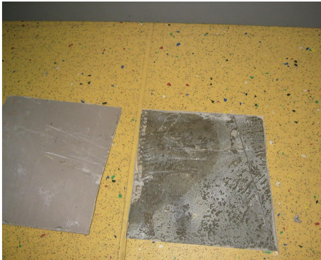
Kuva 14. Porareikämittapisteellä 4 irrotettu muovimattopala ei ollut kovin hyvin kiinni alustassaan ja mattoliima oli nihkeää.
