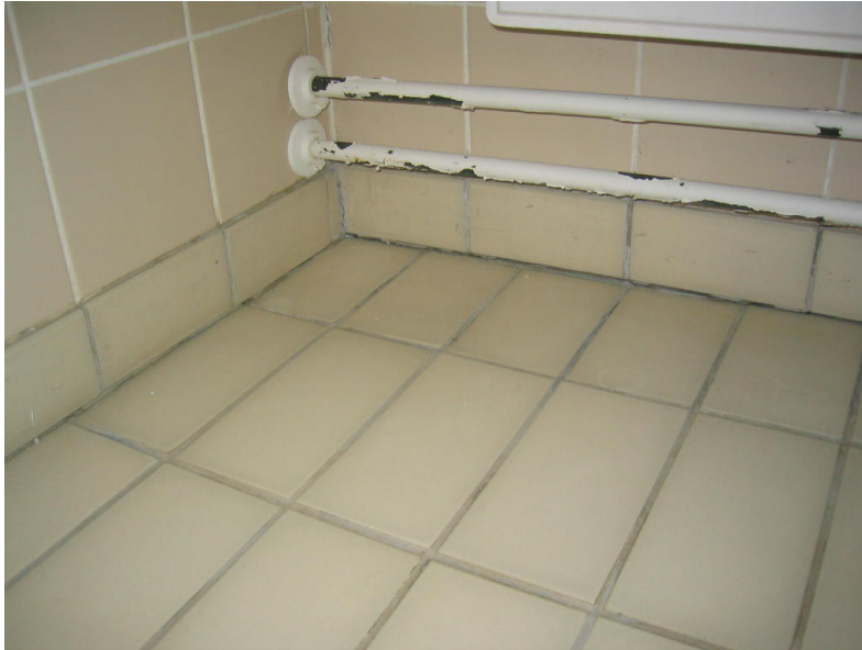
Kuva 19. Liikuntasalin pukuhuoneiden suihkutiloissa ulkoseinään liittyvät nurkkasaumat olivat paikoin halkeilleet ja auenneet.
