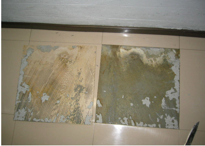
Kuva 11. Käytävän 038 porareikämittapisteen 2 kohdalla vinyylilaatan alapuolella oli nihkeää liimaa.
