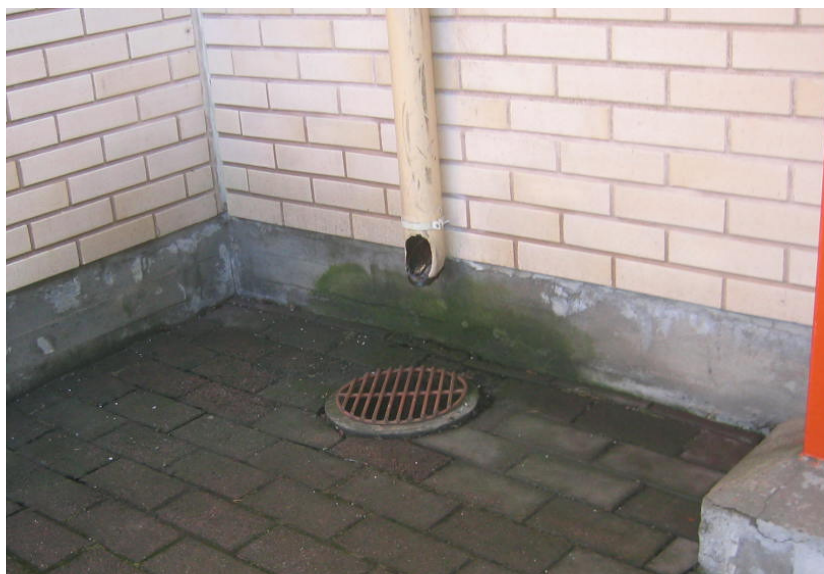
Kuva 6. Ensimmäisen kerroksen aulan 002 ulkoseinän halkeaman kohdalla oli syöksytorvi ja sadevesikaivo.
