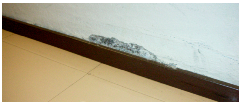
Kuva 10. Käytävän 038 porareikämittapisteen läheisyydessä betoniseinän alaosassa oli todennäköisesti kosteuden aiheuttamaa tasoite- ja maalivauriota.
