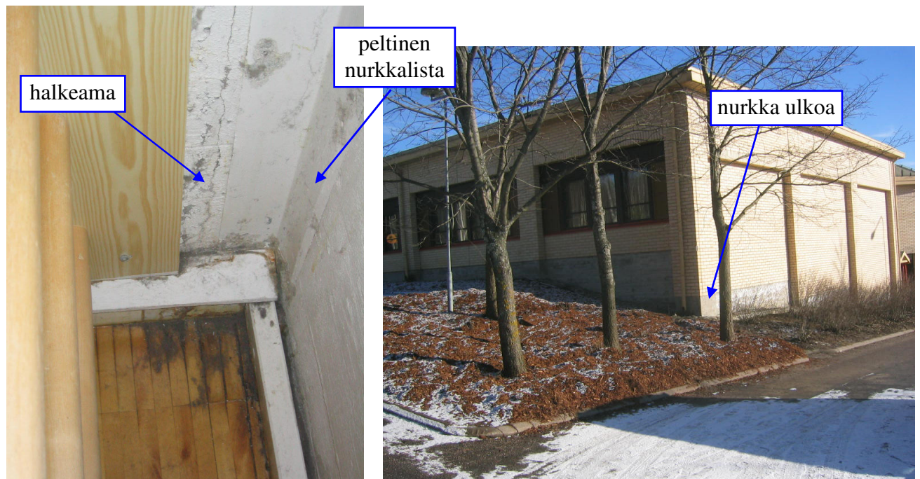
Kuva 16. Liikuntasalin ulkonurkassa mosaiikkiparketti oli haristunut ja tummunut. Seinien nurkassa oli peltinen nurkkalista. Seinässä oli pystyhalkeama ja maalivaurioita listan reunoilla. Oikealla nurkka ulkoapäin, nurkassa syöksytorvi.
