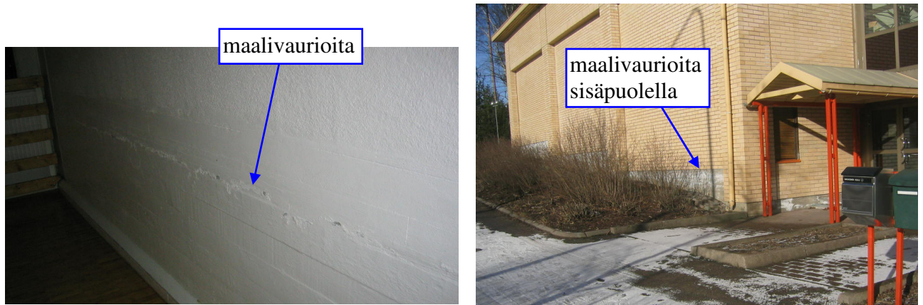
Kuva 15. Liikuntasalin päädyn ulkoseinällä havaittiin maalivaurioita. Oikealla sama kohta ulkopuolelta, maalivauriot olivat sokkelin yläpinnan tasalla.
