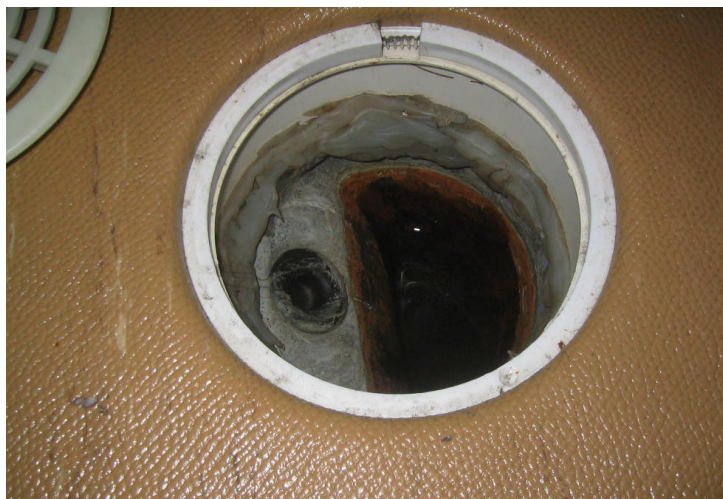
Kuva 4. Liikunnanopettajien suihkuttilan 015 lattiakaivossa oli reunoilla jotain pehmeää ainesta/kertymää. Suihkunurkasta muovimatto oli irti alustastaan ja pintakosteuslukemat koholla.
