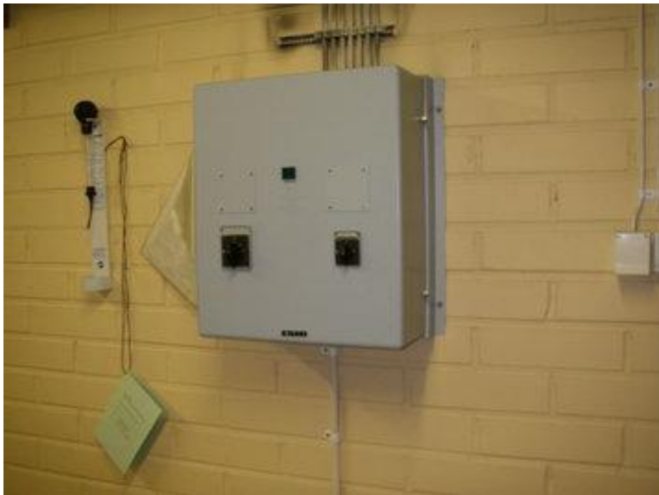
Alkuperäinen turvavalaistuksen keskus. Suositellaan uusittavan jakson aikana.
