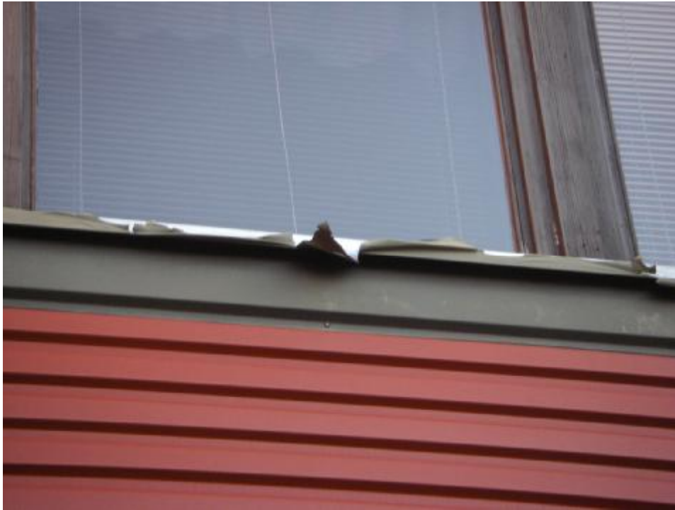
Ikkunapellin pinnoite hilseilee.
