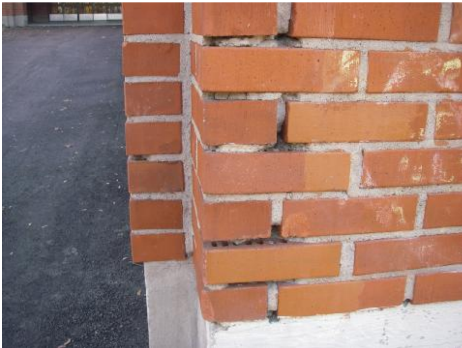
Tiiliseinien laastisaumat ovat auki muutamissa kohdissa.
