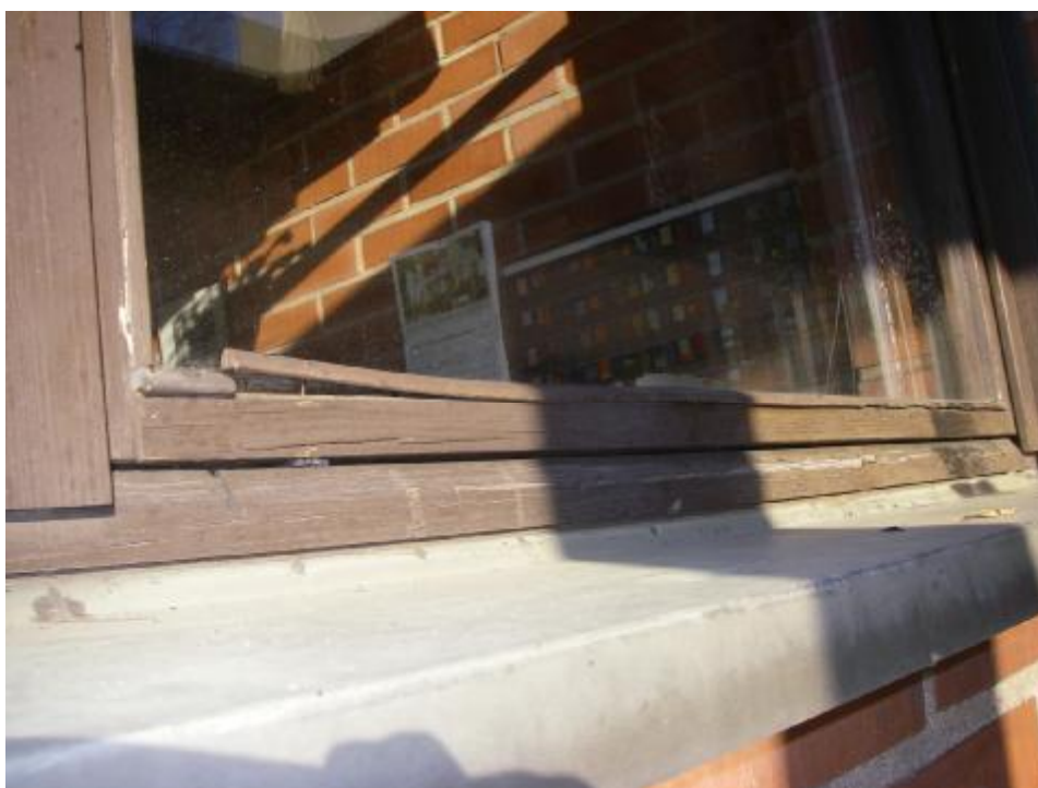
Puuikkunat vaativat kunnostus- ja huoltotoimenpiteitä.
