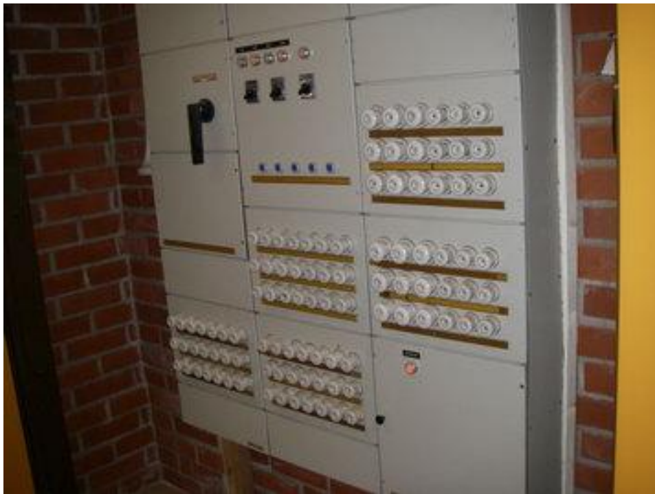
Ryhmäkeskus käytävätilassa. Keskus on perinteinen tulppasulakekeskus.
