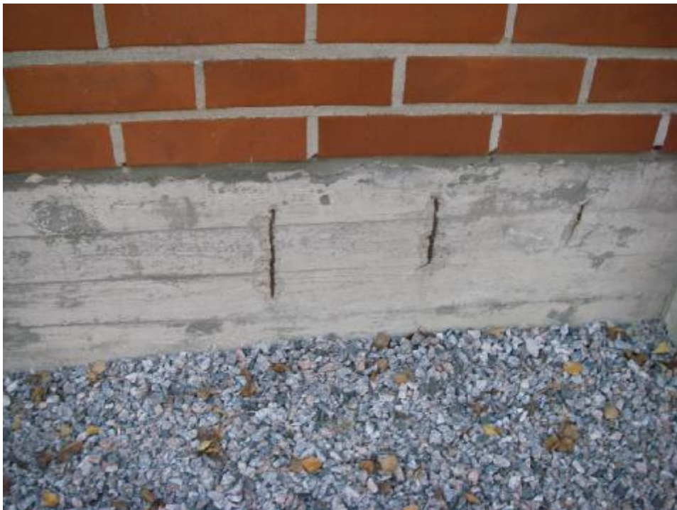
Sokkelipinnoissa olevat ruostuneet teräkset ja muut vauriokohtat vaativat korjaustimenpiteitä.
