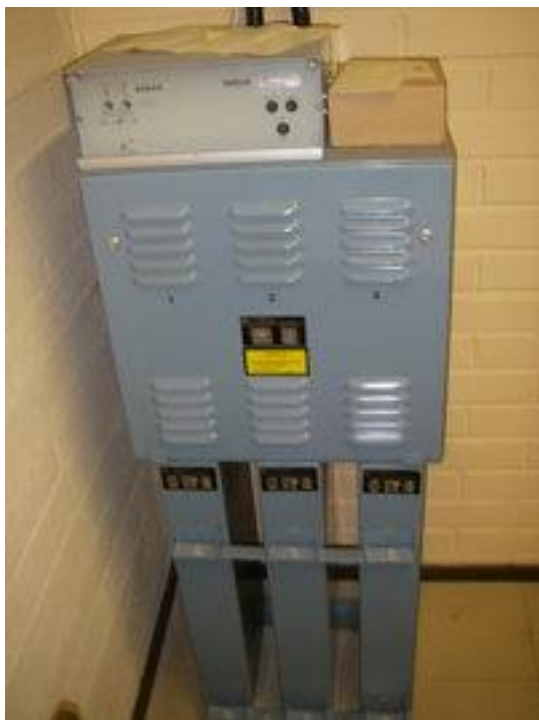
Kompensointilaitteisto on alkuperäinen.
