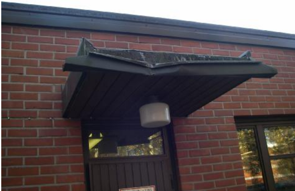
Katoksen räystäskourun painuma tulee korjata.
