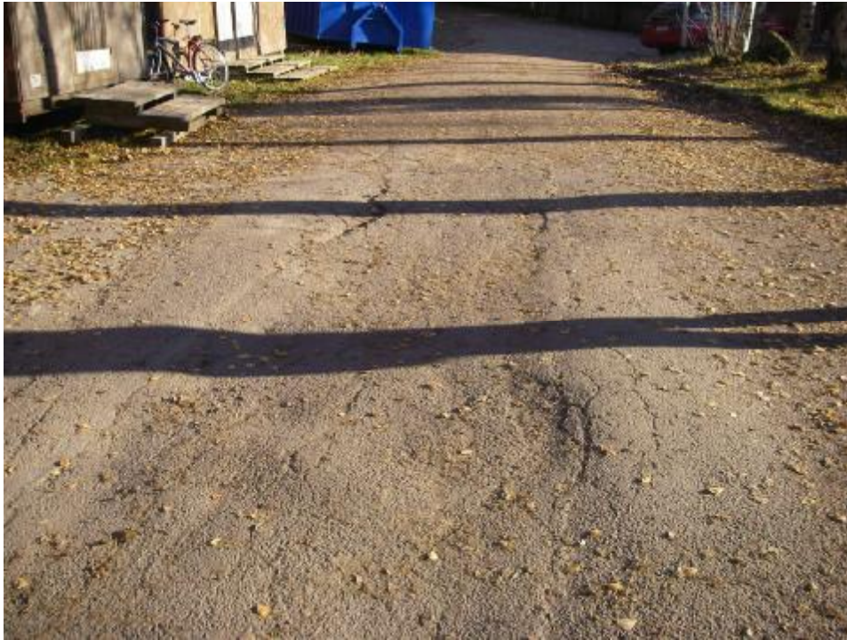
Asfalttipäällysteessä on paikallisia painumia ja halkeamia.
