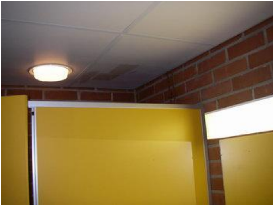
WC-tilojen valaisimet ovat elinkaarensa päässä.
