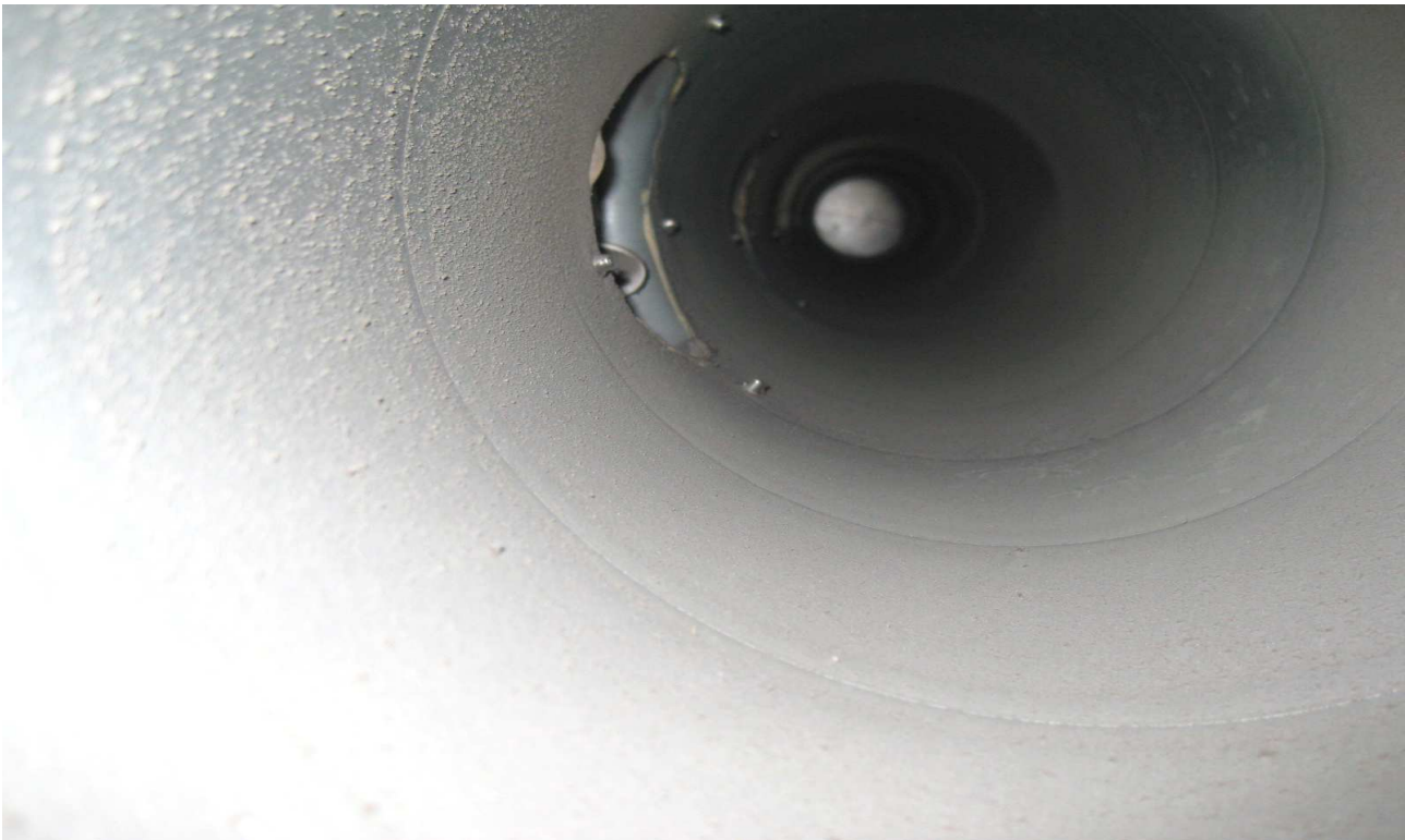
LVI-kuva 14. Yleiskuva poistoilmakanavasta.
