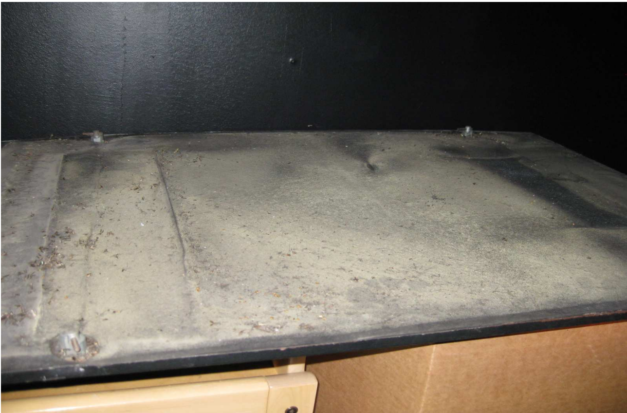
LVI-kuva 12. Yleiskuva tuloilmakoneen kammiosta, joka on eristetty mineraalivillalla.
