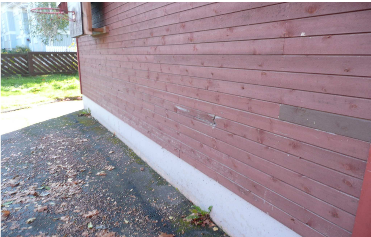
R-kuva 2. Varaston maalipinnassa esiintyvä väri vaihtelu ja pinnan kulumista.
