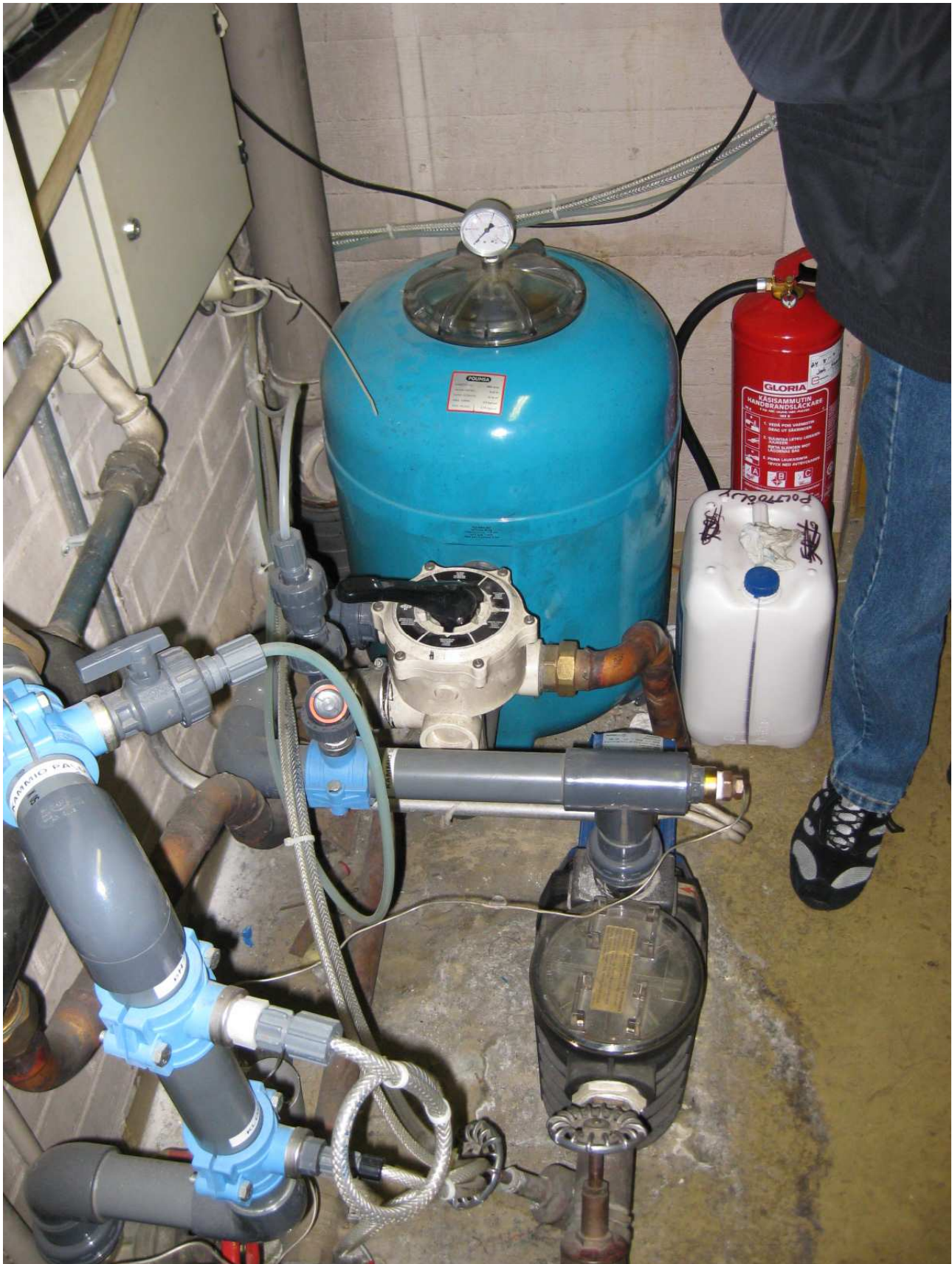
LVI-kuva 16. Yleiskuva uima-allaslaitteista.
