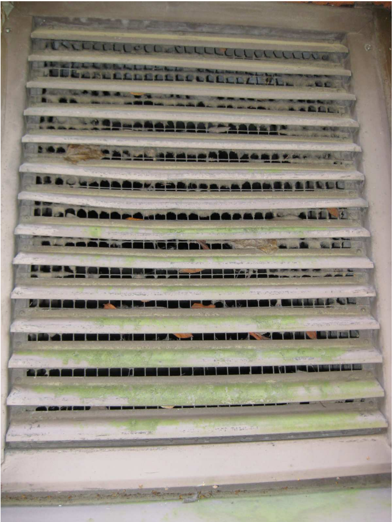
LVI-kuva 9. Yleiskuva tuloilmakoneen raitisilmasäleiköstä.
