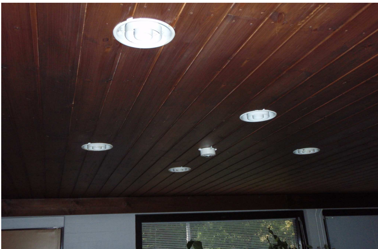
S-KUVA 8. Takka- ja allashuoneen valaistus.
