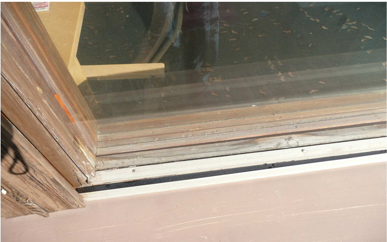
R-kuva 4. Ikkunoiden maalipinnassa esiintyy eriasteisia kulumia ja maalipinnan lohkeiluja.
