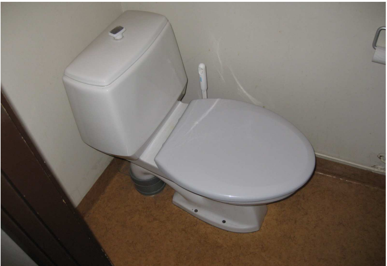
LVI-kuva 7. Yleiskuva vesikalusteista.
