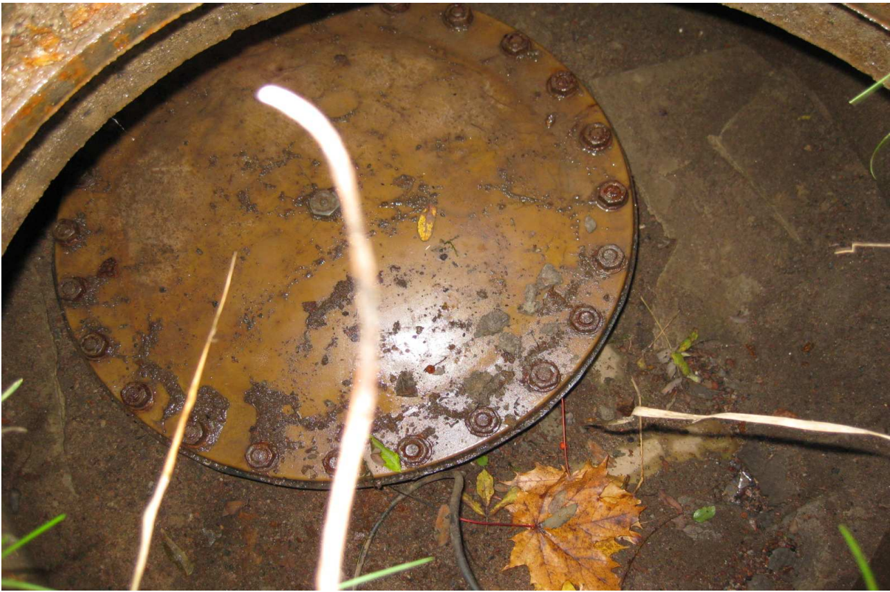
LVI-kuva 2. Yleiskuva öljysäiliöstä.
