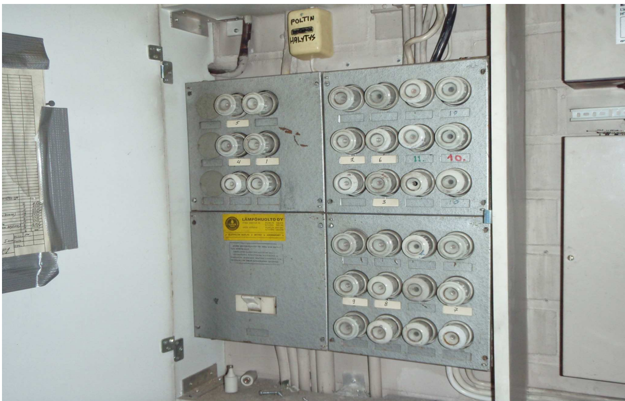
S-KUVA 4. Lämmönjaon keskus.
