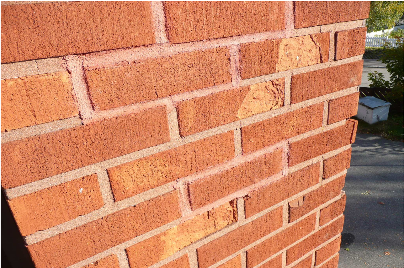
R-kuva 3. Tiilien pinnassa on rapautumisen merkkejä.
