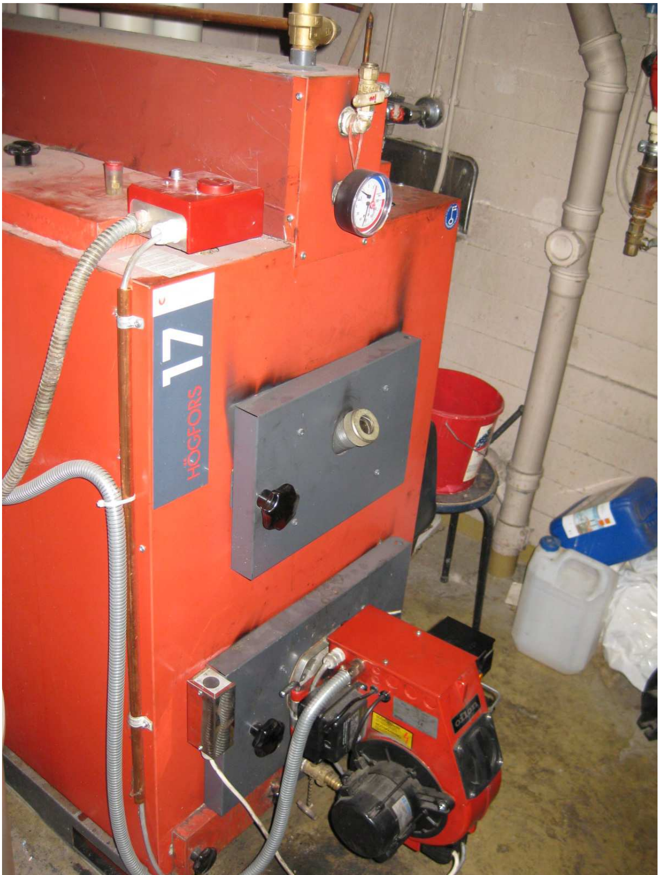
LVI-kuva 1. Yleiskuva pannuhuoneesta.
