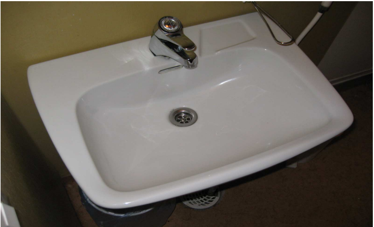
LVI-kuva 6. Yleiskuva vesikalusteista.
