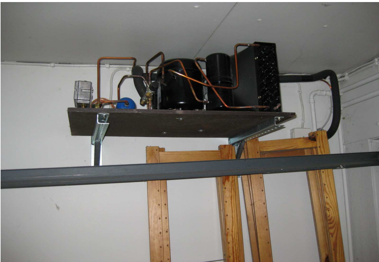
LVI-kuva 15. Yleiskuva autotallissa olevasta kylmiön koneesta.
