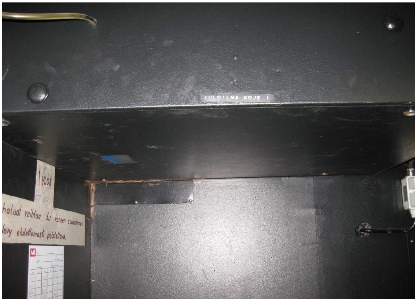
LVI-kuva 8. Yleiskuva IV- koneesta.
