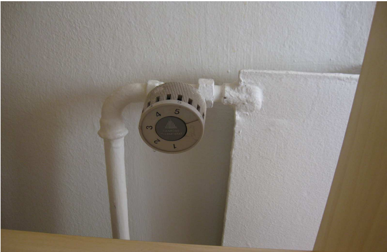
LVI-kuva 4. Yleiskuva patteriventtiilistä.
