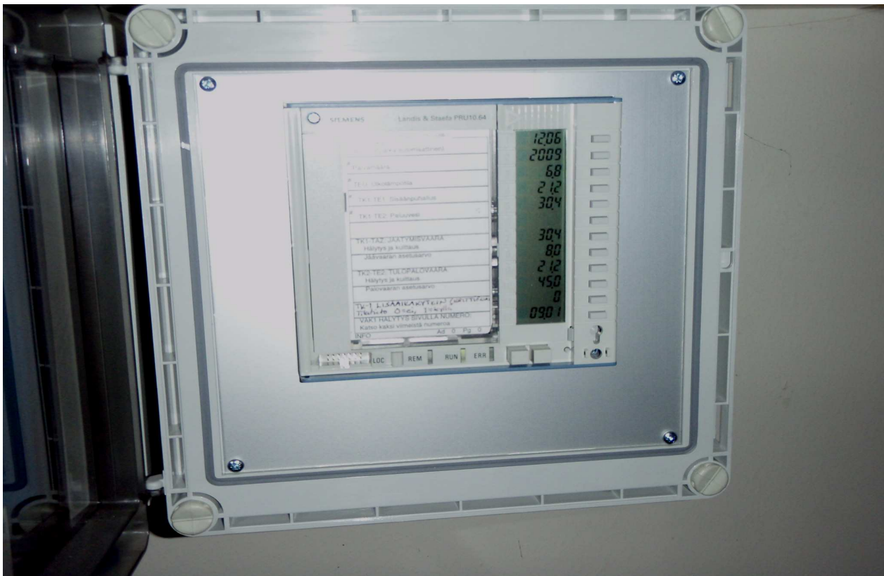
S-KUVA 14. Rakennusautomaatiojärjestelmän yksikkösäädin.
