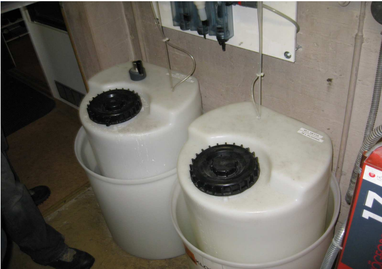
LVI-kuva 17. Yleiskuva annostuslaitteen säiliöistä.
