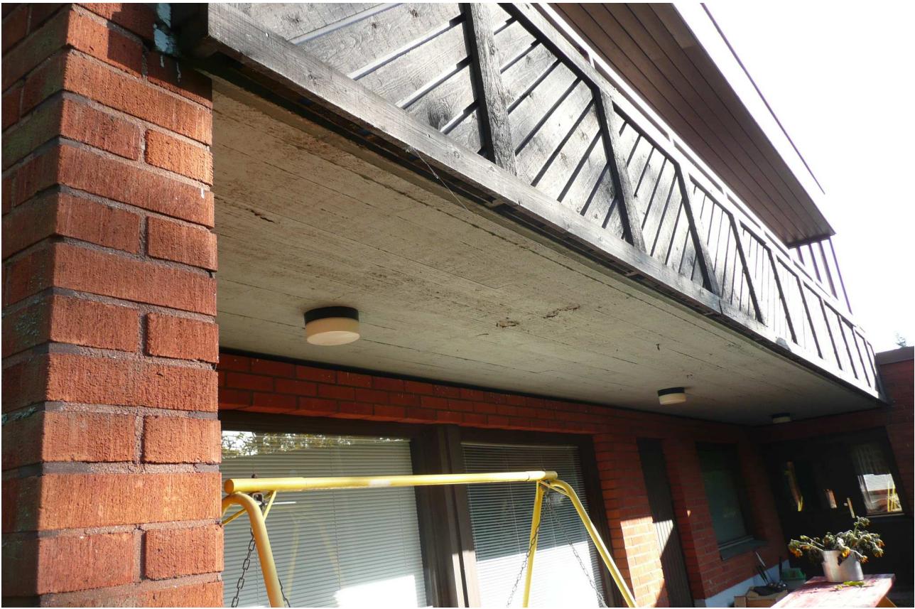
R-kuva 5. Parvekelaatan alapinnassa on maalipinnan hilseilyä.
