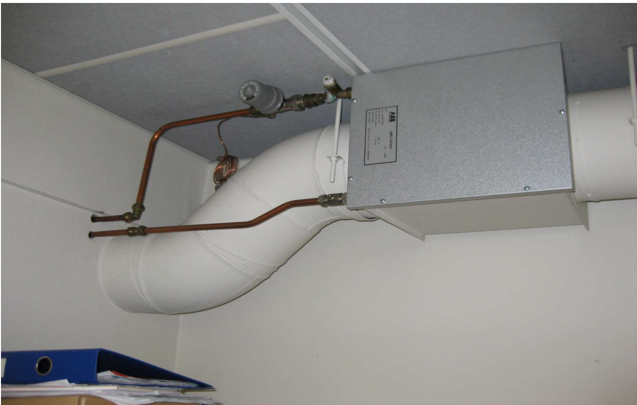
LVI-kuva 13. Yleiskuva jälkilämmityspatterista.
