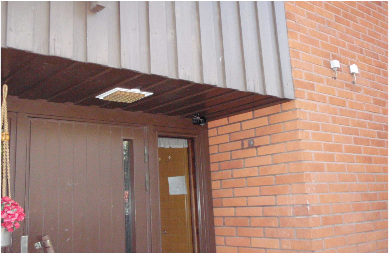
S-KUVA 1. Sisäänkäynnin valaistus.
