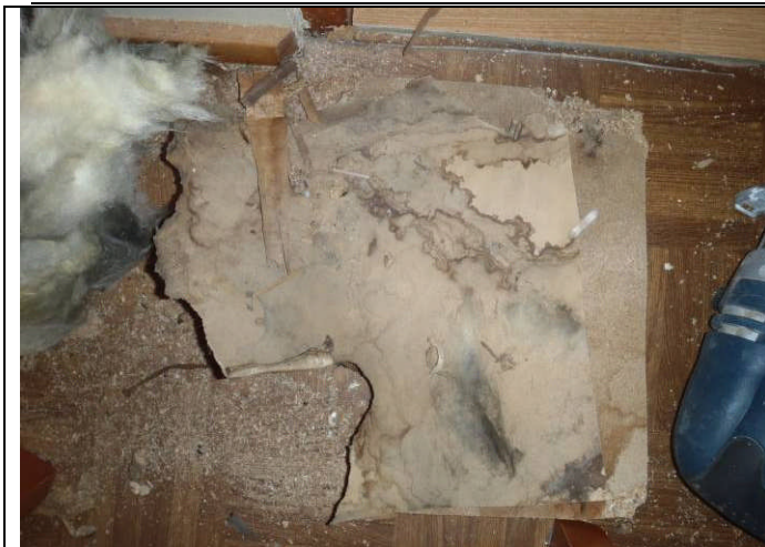
3. Materiaaleja avauksen kohdalta
