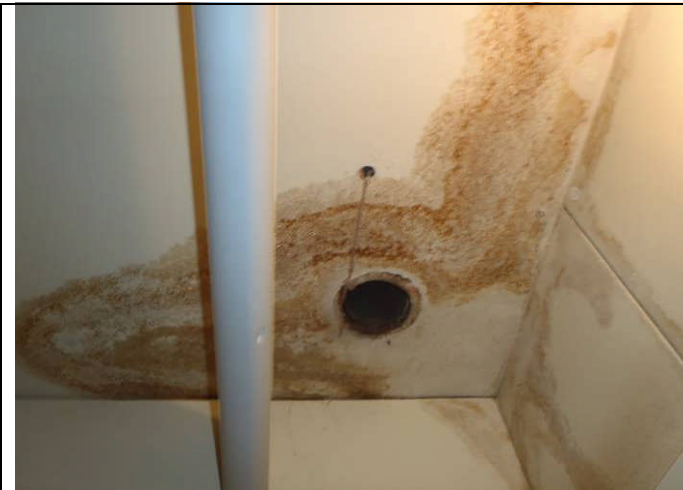
1. Sisäkaton jälkiä vaatehuoneessa
