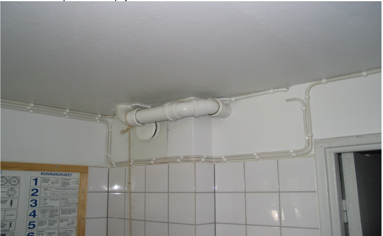
KUVA 21. Viemärissä on väärää kaatoa.
