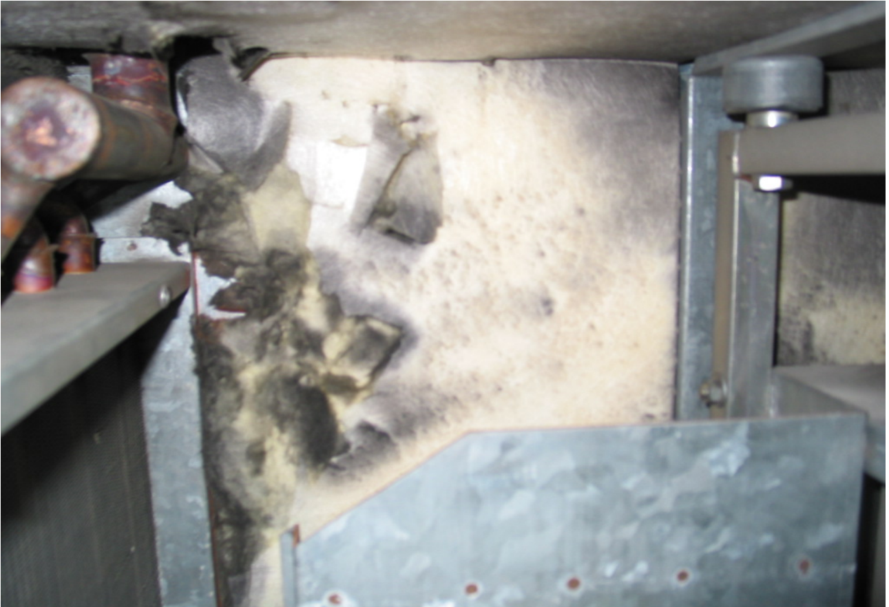
KUVA 24. IV-koneen sisäpuolen villapinta on rikki.
