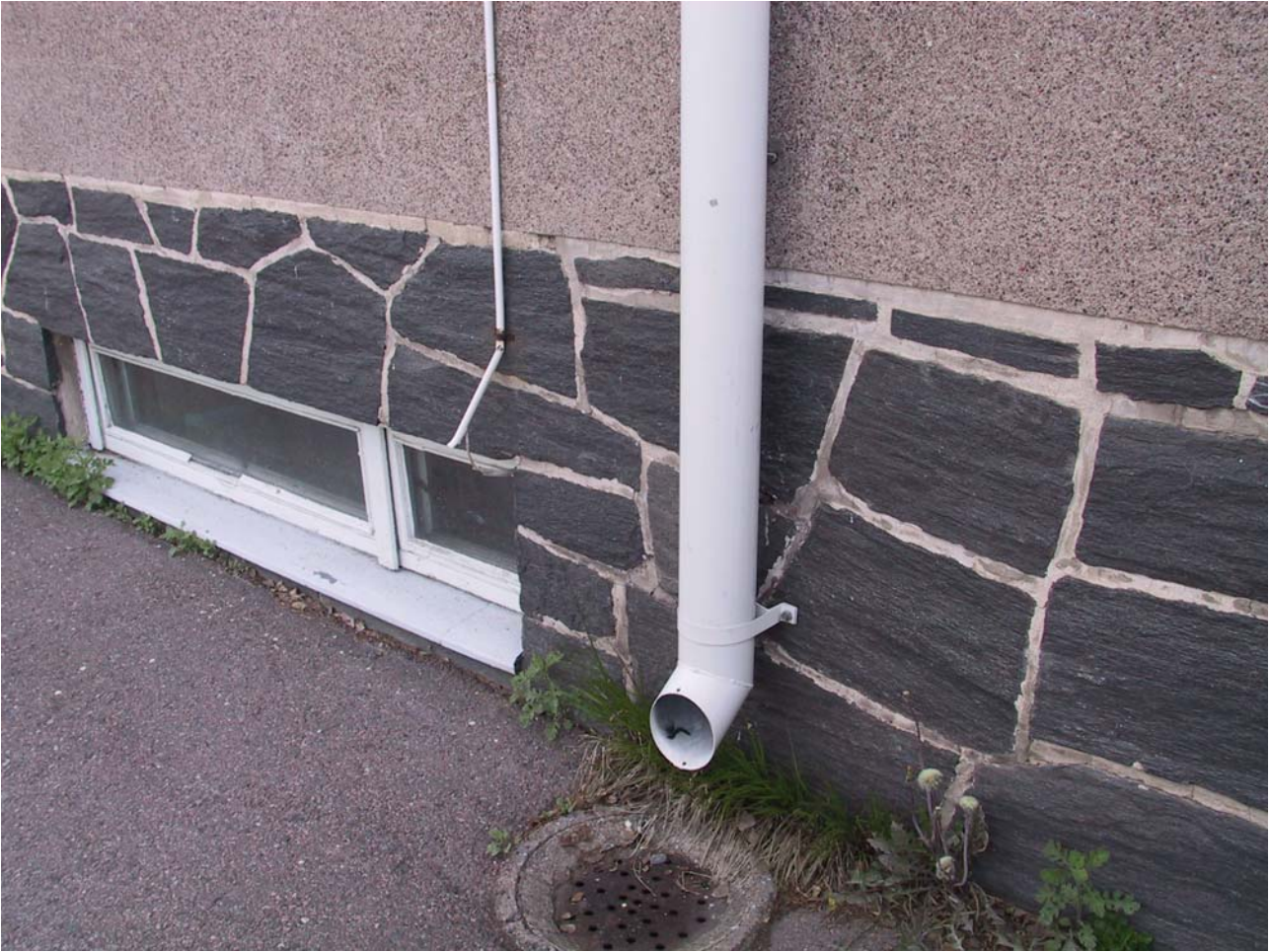
KUVA 28. Ulkoseinällä rikkoutunut kaapelin suoja-putki.
