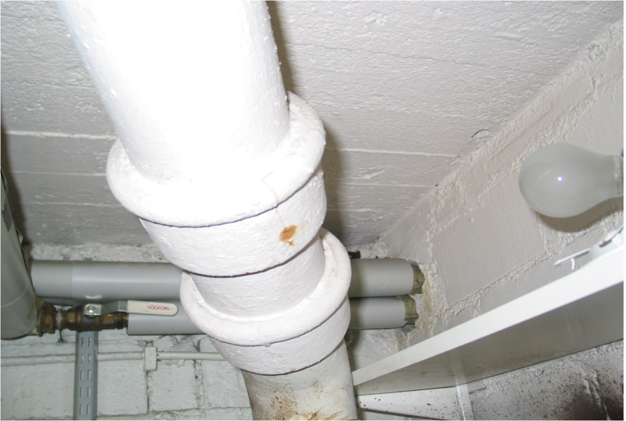
KUVA 22. Viemäri on halki.
