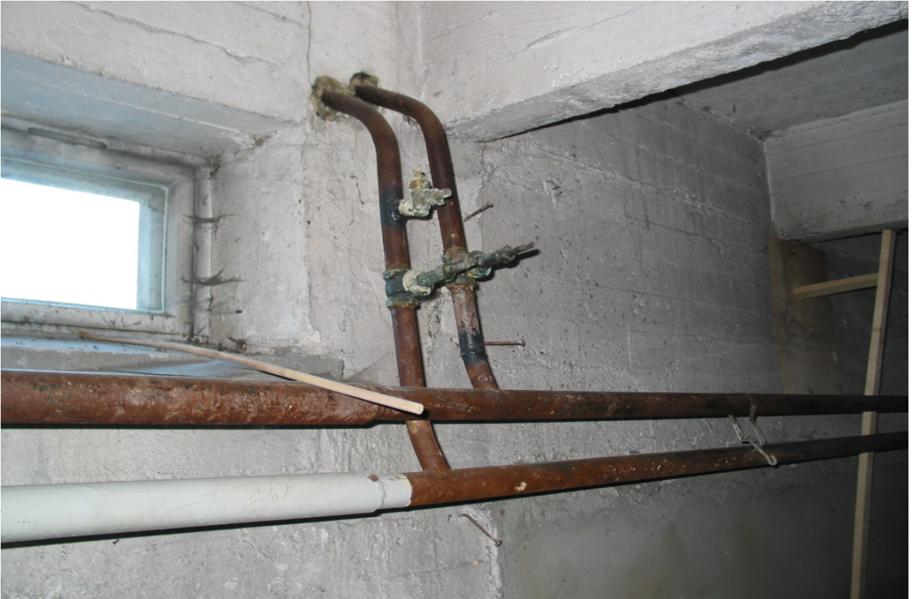
KUVA 20. Alkuperäiset lämpöjohtoverkoston venttiilit.
