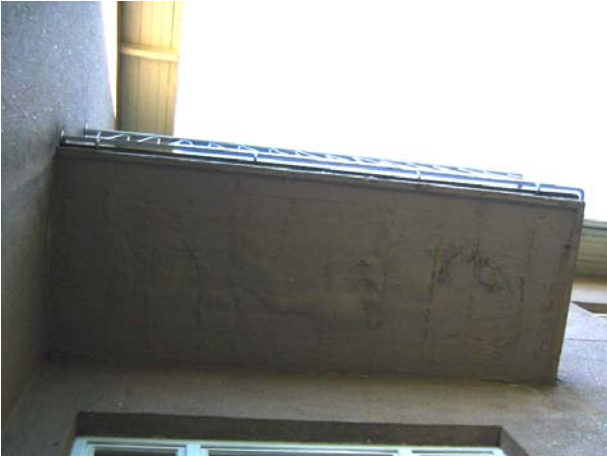
KUVA 13: Rakennuksessa on yksi parveke. Laatan alapinnassa on merkkejä vaurioista.
