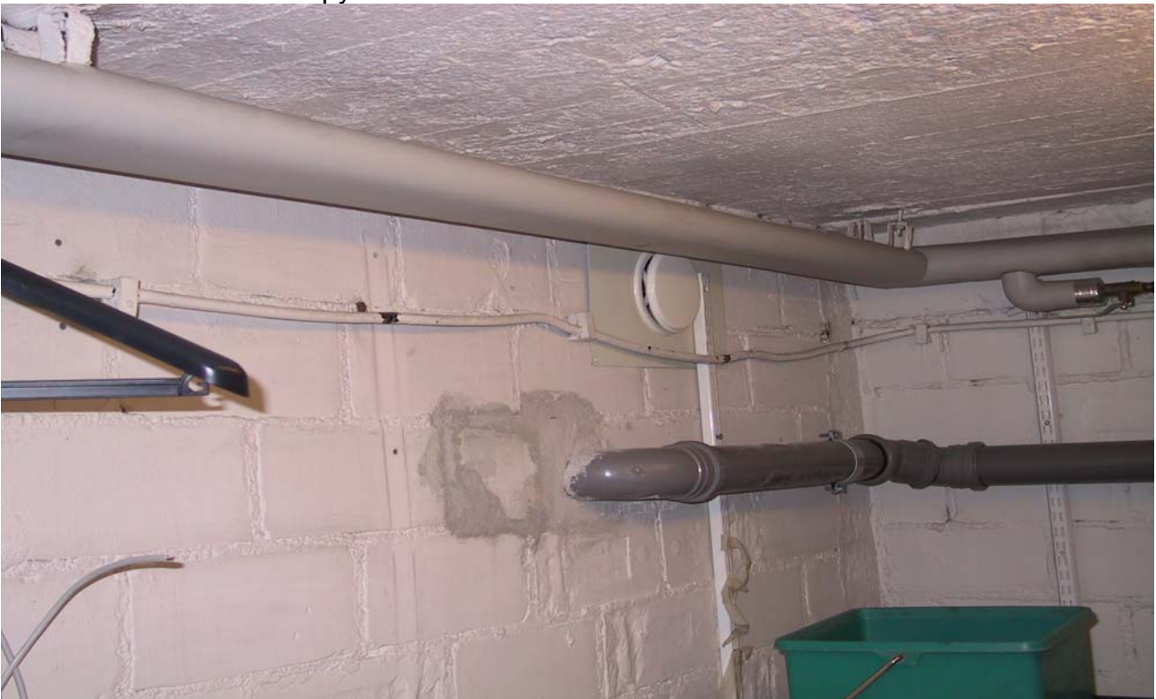
KUVA 27. Kellaritiloihin on lisätty ilmastointiventtiilejä ja niiden asennusvaiheessa on jouduttu irrottamaan ja siirtämään vanhoja kangas/lyijykaapeleita.
