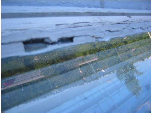
KUVA 14: Ikkunan kittauksissa esiintyi tarvetta rakenteiden kunnostamiselle.
