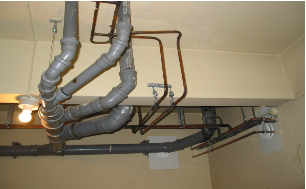
KUVA 23. Putkihajotuksia ei ole eristetty.
