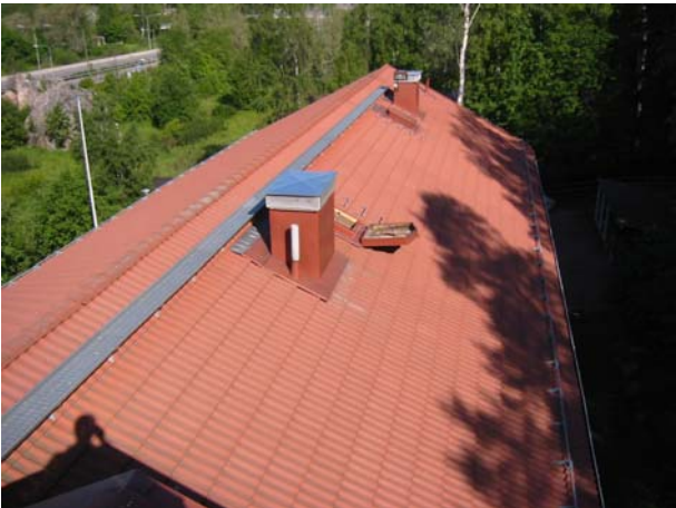
KUVA 15: Vesikatto on kokonaisuudessaan tyydyttävässä kunnossa.
