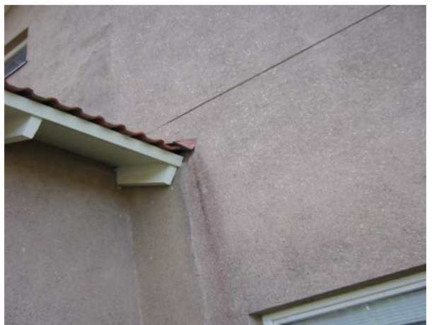
KUVA 12: Pääsisäänkäynnin katoksen liittymästä ulkoseinään kosteusrasitusta.
