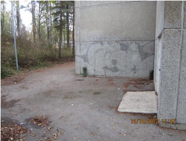
kuva 3 Liikuntasalin sisäänkäynnin edustan pintakallistukset eivät ole riittävät. Vettä on uittanut lattiarakenteeseen, jonka alla on alustatila (ks. kuva 23).
