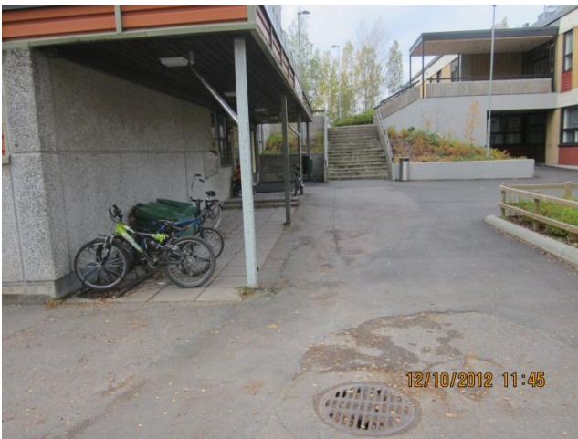
kuva 1 Pääsisäänkäynnin edustan pintakallistukset vaikuttavat riittävältä.
