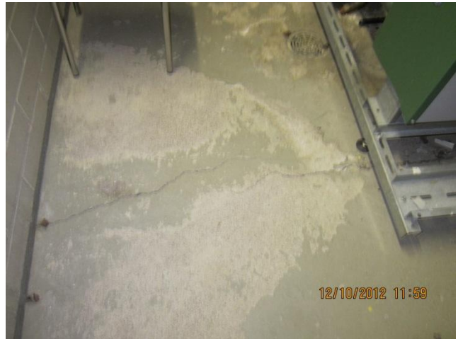
kuva 12 Lämmönjakuhuoneen 029 lattiassa on halkeamia.
