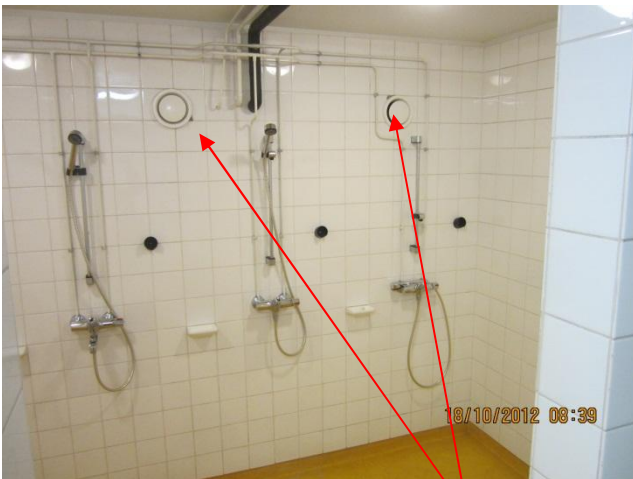
kuva 26 Pesuhuone 008. Laattojen paloja irronnut venttiileiden kohdalta.
