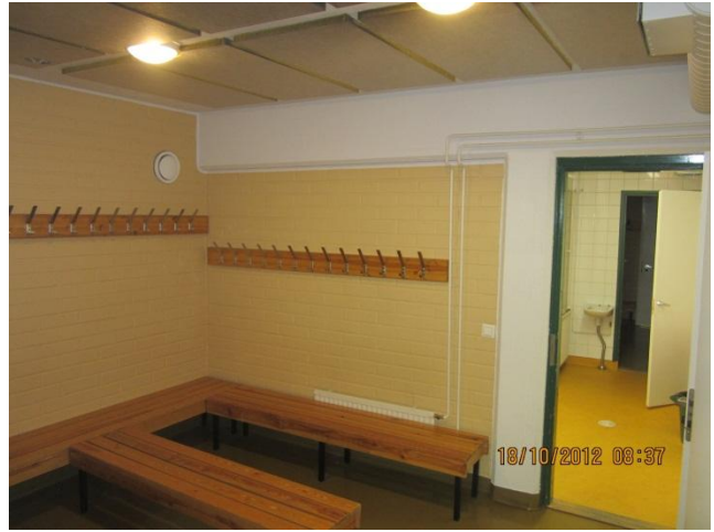
kuva 34 Pukuhuoneessa 015 on eristämättömiä lämpö- putkia.
