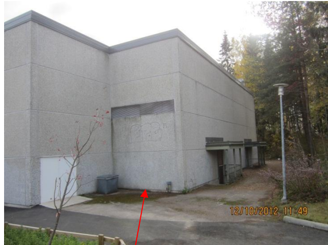
kuva 4 Liikuntasalin toisen sisäänkäynnin edusta on sammaloitunut kohdasta, josta sadevedet poistuvat hitaasti. Lisäksi seinänvierellä on paha painauma .
