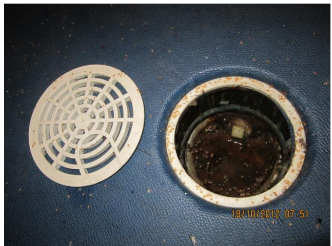
kuva 29 Ravistelutilan 013 lattiakaivo. Kaivon ympärillä on puhallusilman mukana tullutta koivun siementä.
