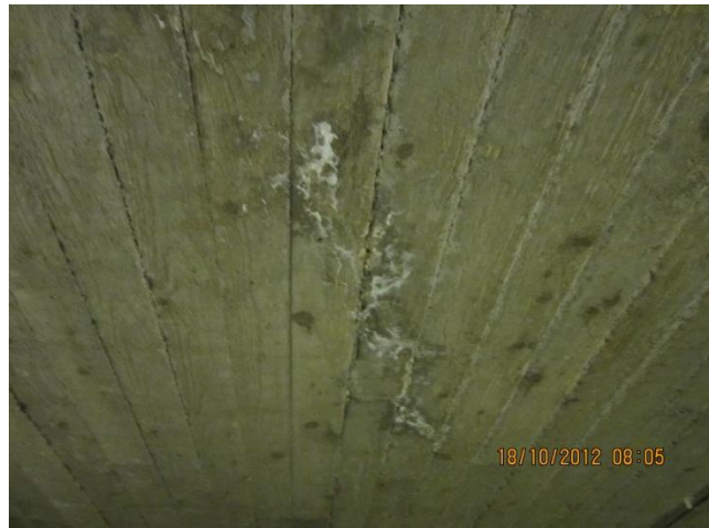
kuva 16 Myös varaston katossa, liikuntasalin alla, on kalkkijälkiä.
