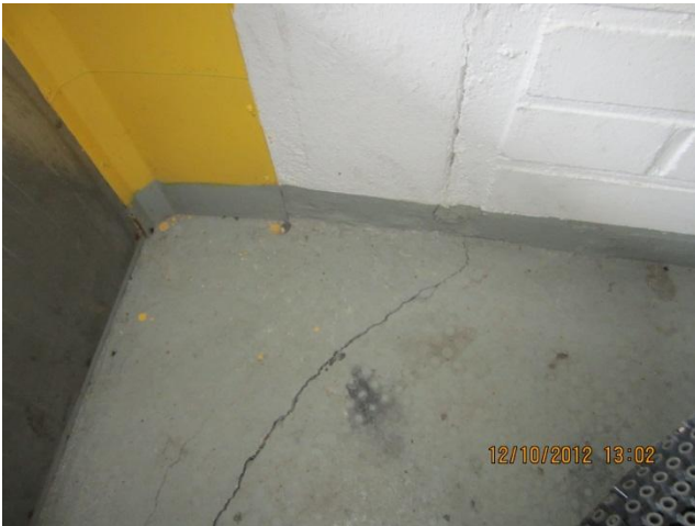
kuva 11 Tuulikaapin 037 lattiassa on halkeama.
