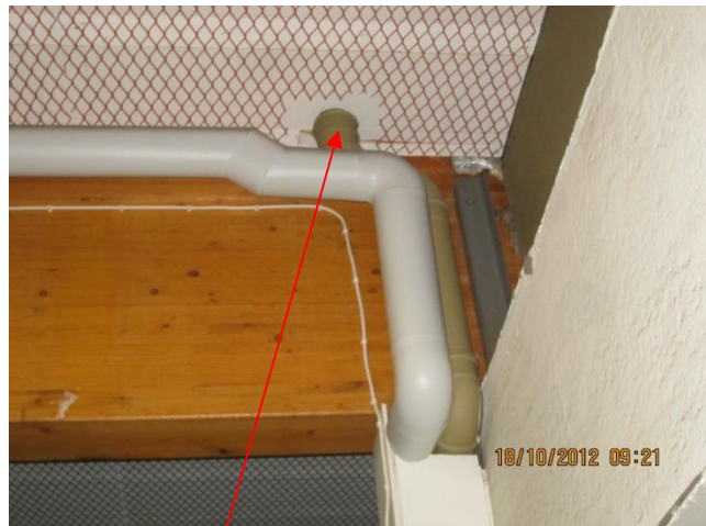
kuva 6 Ylemmältä vesikatolta johdetut sadevesien poistoputket kulkevat sisätilojen kautta.
