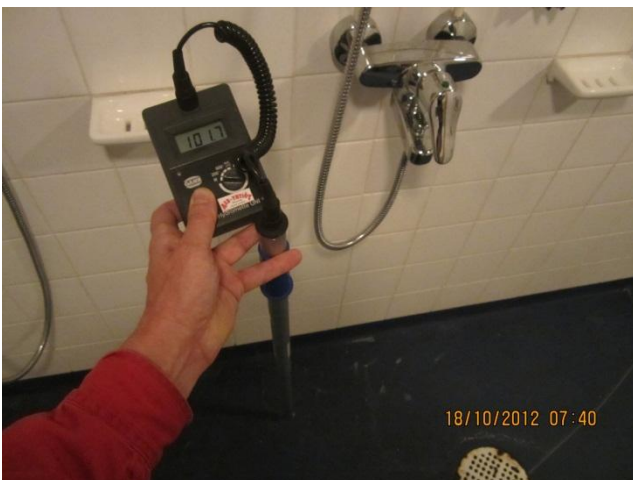
kuva 13 Pesuhuoneen 009 lattiasta saatiin koholla oleva pintakosteuslukema.
