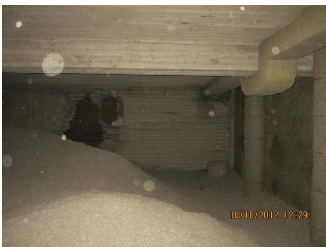
kuva 17 Alustatilan pääsisäänkäynnin puoleisessa seinässä on kosteusjälkiä.
