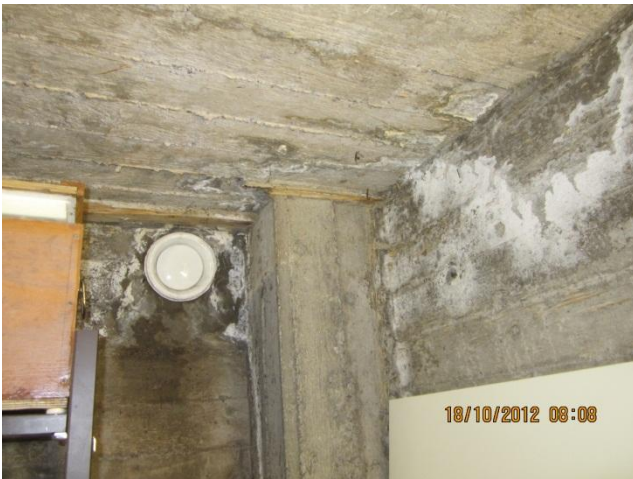
kuva 15 Varastotilan seinissä on runsaasti kosteusvauriojälkiä.
