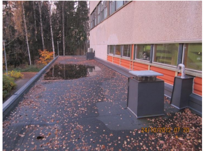
kuva 21 Sadevettä on lammikoitunut sekä alemmalle että ylemmälle vesikattotasolle.
