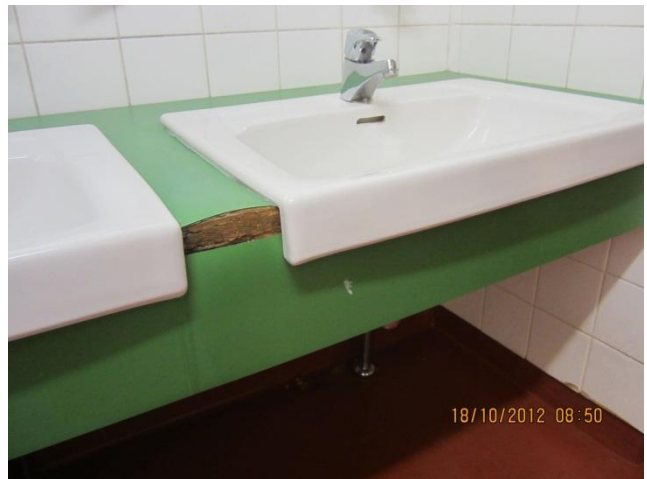
kuva 27 Ravistelutilan 023 lavuaaritasoissa on kosteusvaurioita.
