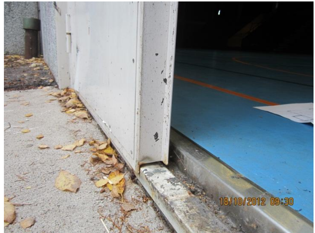
kuva 23 Sadevesiä voi päästä liikuntasalin joustavan puulattian alle.
