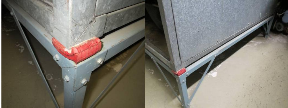
Kuvat 37-38. Tuloilmakoneen kumityynynt ovat heikossa kunnossa.
