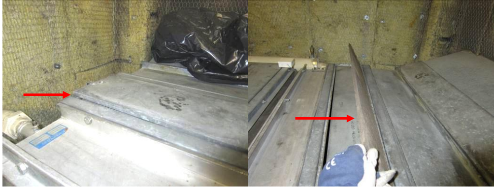
Kuvat 15-16. Luukkujen lukitukset ja tiivisteet ovat osittain epäkunnossa.
