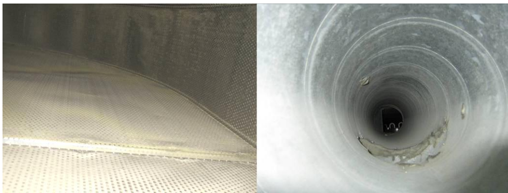
Kuvat 42-43. Yleiskuvat tuloilmakanavasta... poistoilmakanavasta.
