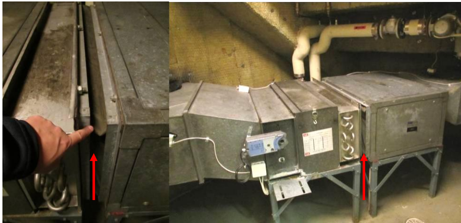
Kuvat 9-10. Tuloilmakammion liittokset eivät ole tiiviitä.
