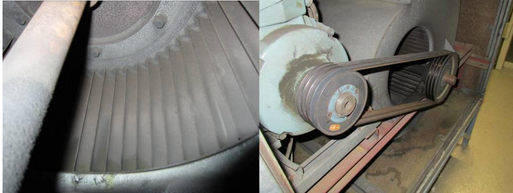
Kuvat 31-32. Yleiskuvat puhaltimesta
