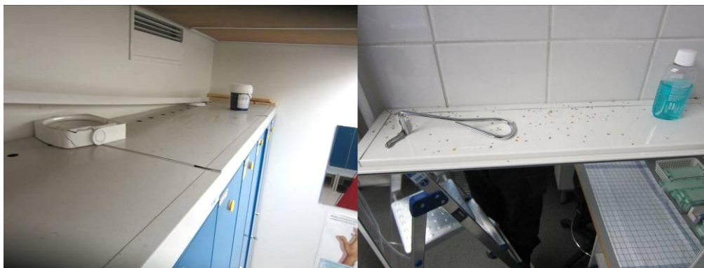
Kuvat 49-50. Kaappien päällä on pölykertymää ja roskaa.
