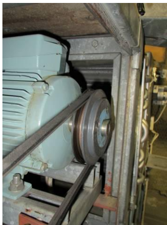
Kuva 22. Tuloilmakoneen hihnat ovat hieman kuluneet.
