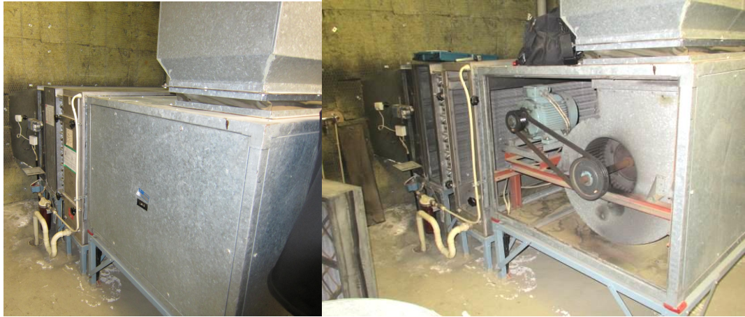
Kuvat 23-24. Yleiskuvat tuloilmakoneesta LIK 3.
