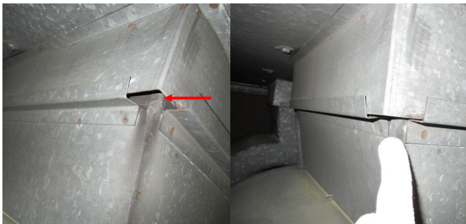
Kuvat 33-34. Puhallinta ei ole tiivistetty puhallinkammioon nähden.
