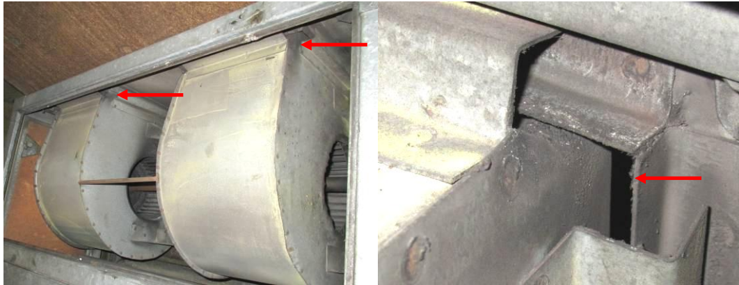
Kuvat 7-8. Yleiskuva puhaltimista, puhallinta ei ole tiivistetty puhallinkammioon nähden.
