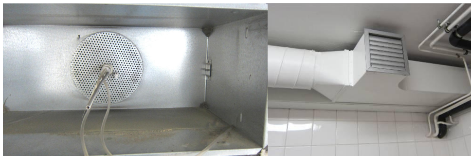
Kuva 44-45. Yleiskuvat toimistohuoneen ja sosiaalitalan tuloilman pääte-elimistä.
