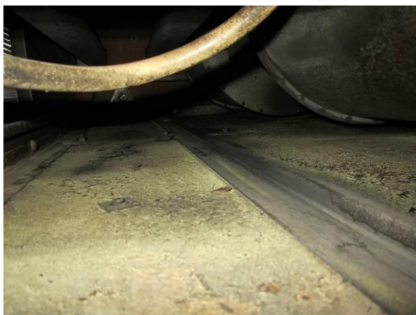
Kuva 5. Ilmanvaihtokoneen kammioissa on havaittavissa pölyä.
