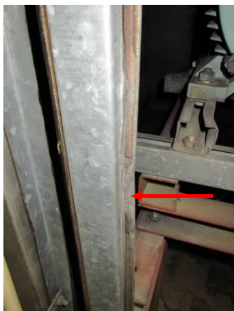
Kuva 26. Luukkujen tiivistykset ovat heikossa kunnossa.
