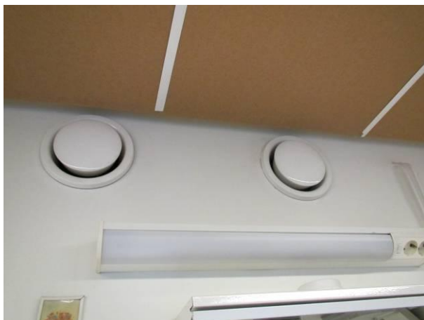
Kuva 48. Yleiskuva uusituista kartioventtiileistä.
