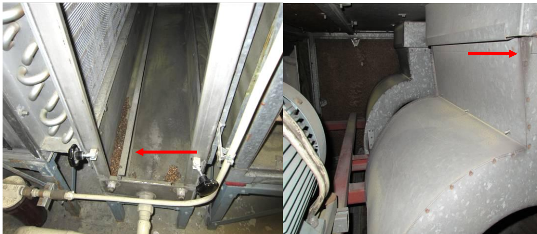
Kuvat 29-30. Ilmanvaihtokoneen kammioissa on havaittavissa roskia ja pölyä.
