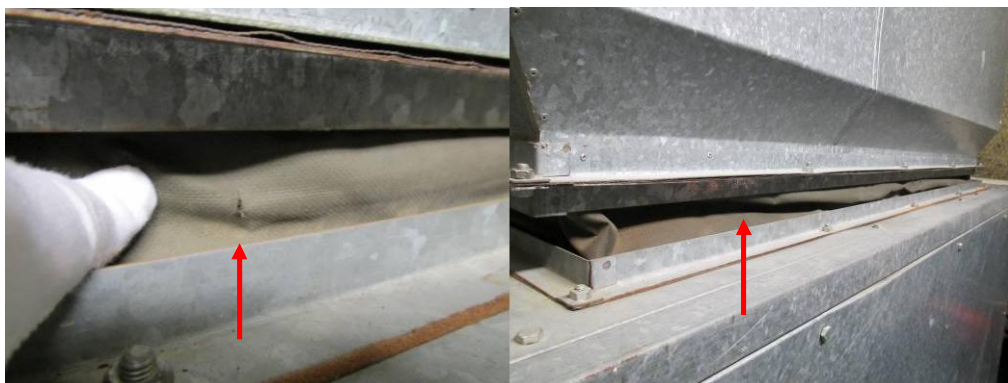
Kuvat 35-36. Tuloilmakammioiden liitokset eivät ole tiiviitä.
