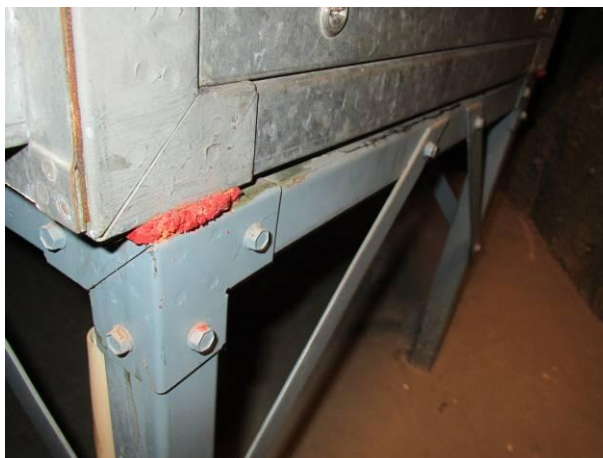
Kuva 11. Puhaltimen kumityynyt ovat heikossa kunnossa.
