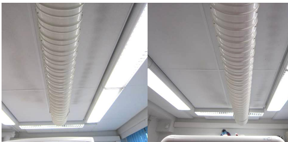
Kuva 46-47. Yleiskuva hammashoitolan tuloilman pääte-elimistä..
