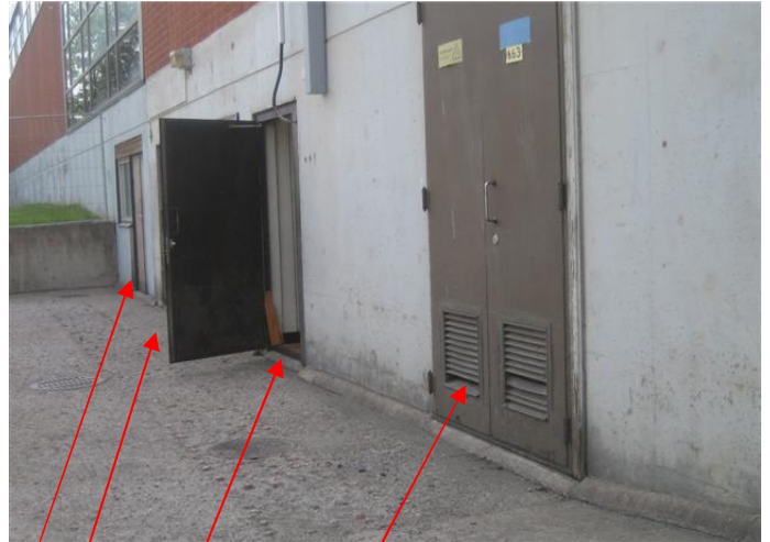
Neljän oven kautta vesi päässyt sisään.
