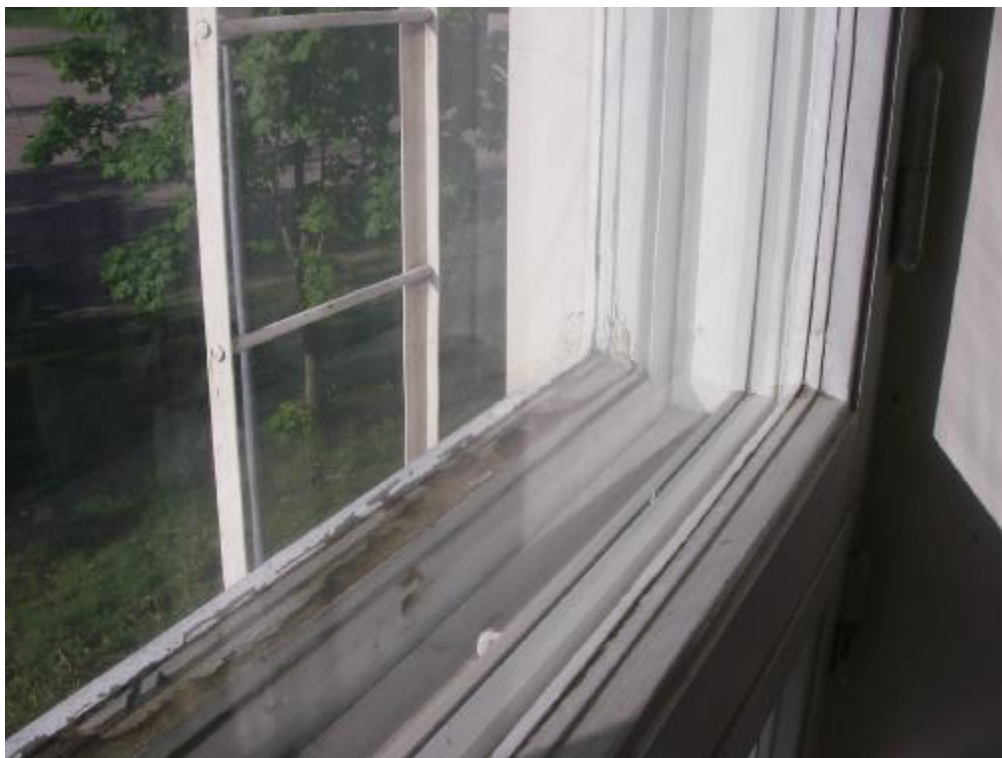
Ikkunoissa esiintyy yleisesti maalipinnan hilseilyä.
