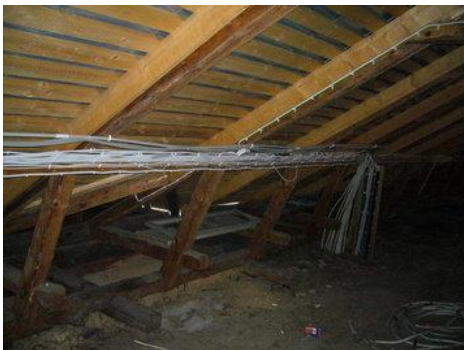
Puukoulun kaapelointi kulkee ullakkotilassa.
