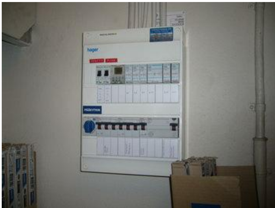
Ulkovalaistuksen ohjauskeskus on asennettu jälkikäteen.
