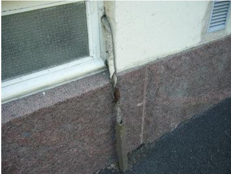
Kivikoulun puhelinkaapeli on elinkaarensa päässä.
