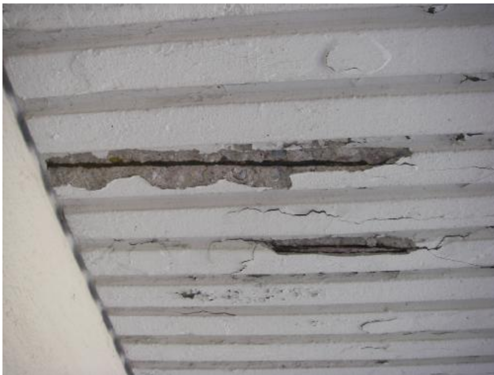
Kivikoulun sisääntulokatoksen betonirakenteissa esiintyy runsaasti rapautumaa.
