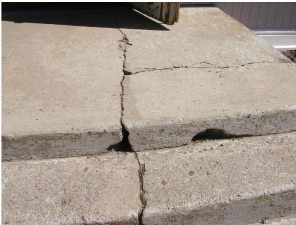
Puukoulun siipiosan ulkoportaissa on vaurioita.
