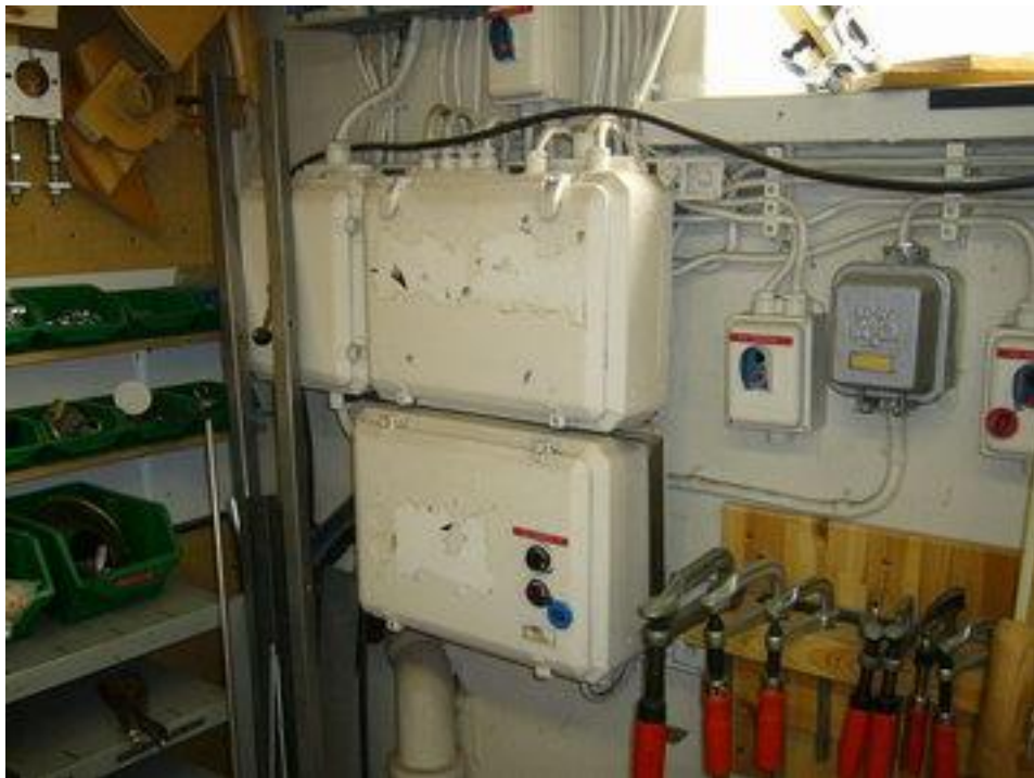
Lämmönjakuhuoneen keskus on elinkaarensa päässä.
