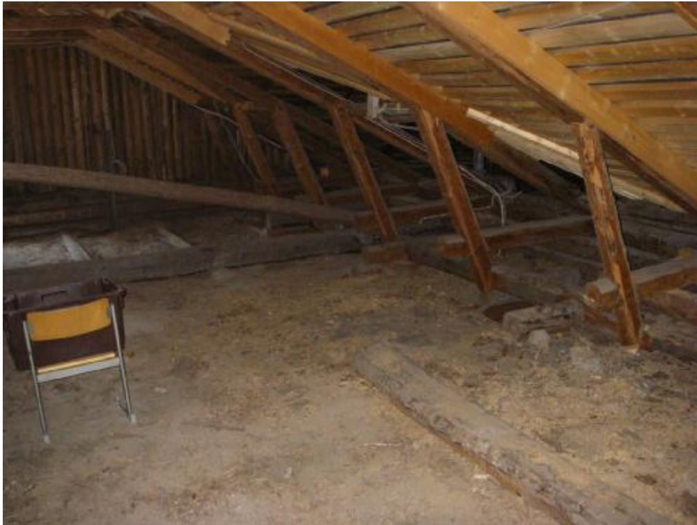
Puukoulun yläpohjan lämmöneristys on puutteellinen. Suositellaan vanhan eristeen poistamista ja puhallusvillan asentamista.
