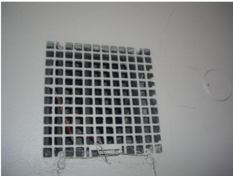
Rakennearineiset ilmanvaihtohormit veto on paikoin olematonta. Hormien kunto tulisi selvittää esim. tv-kuvauksin.
