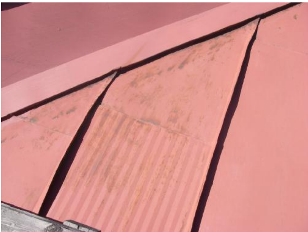
Puukoulun siipiosan vesikatteessa on ruostevaurioita. Suositellaan katteen huoltomaalausta.
