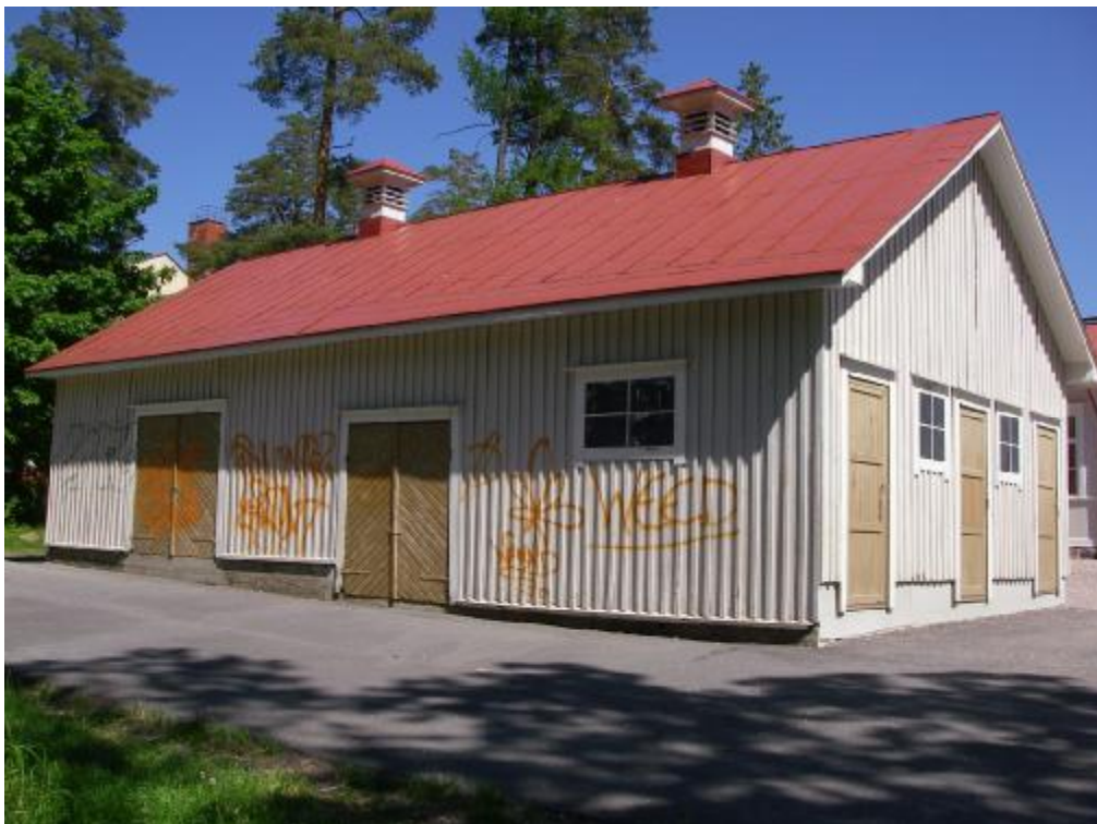
Varastorakennuksen vesikate on kunnossa, mutta puuosat kaipaavat puhdistusta ja huoltomaalausta.
