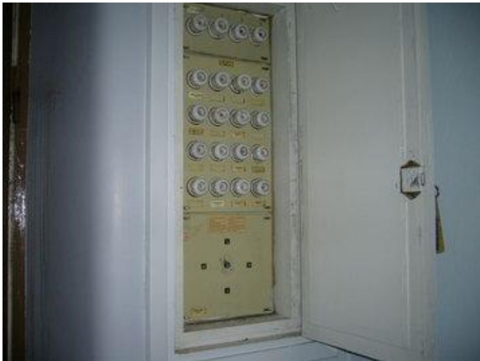
Toisen kerroksen ryhmäkeskuksesta puuttuu pääkytkin.
