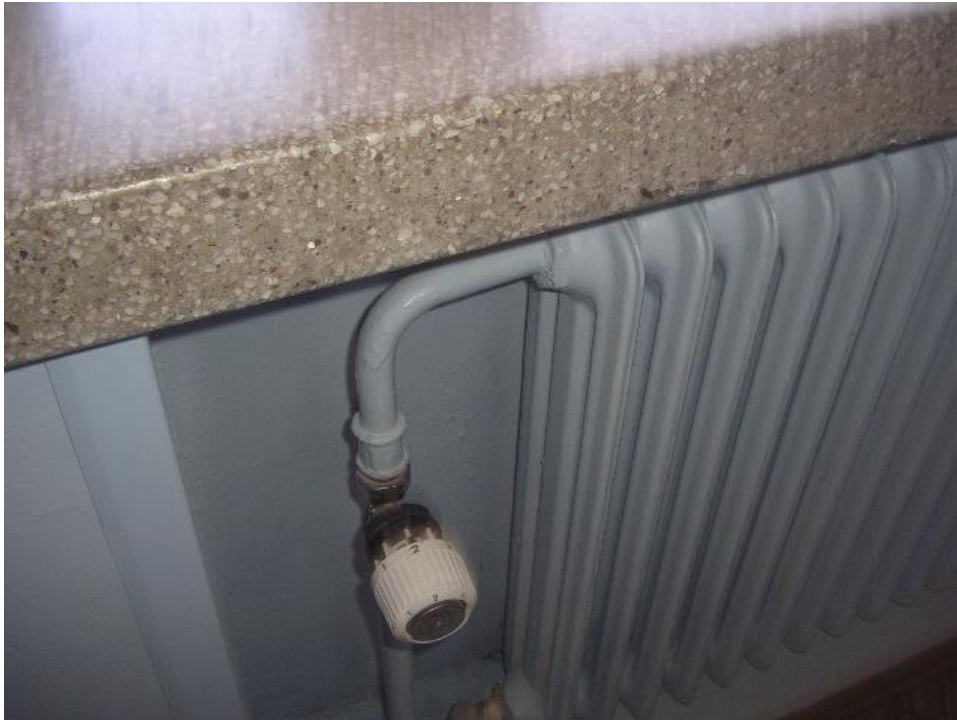
Päärakennuksen patteriventtiilit tulevat uusittaviksi tällä jaksolla.
