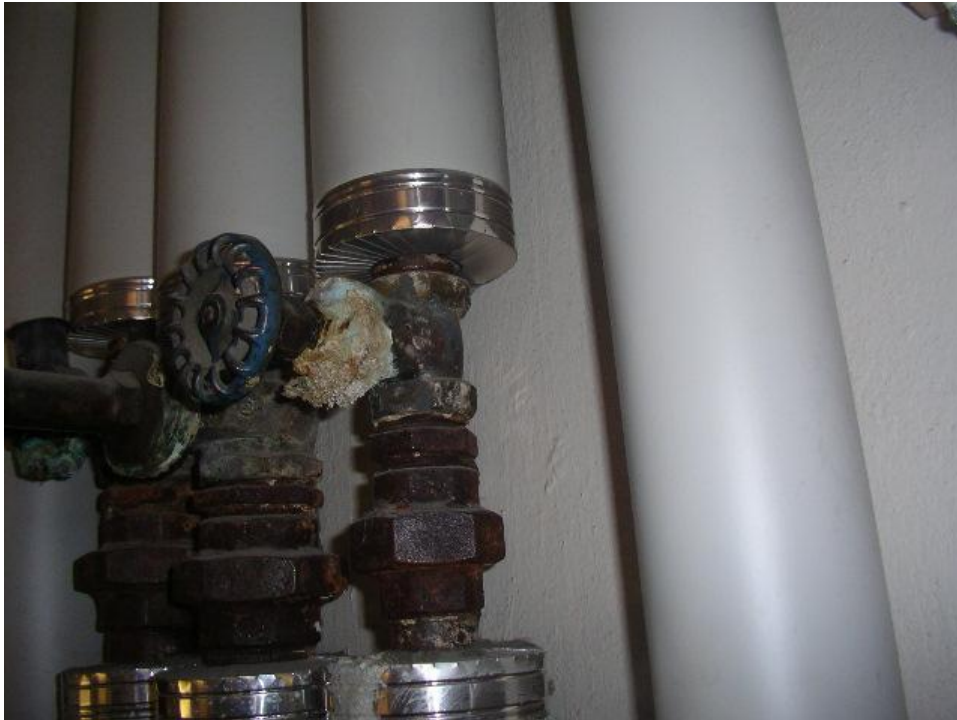
Päärakennuksen vesijohtoventtiileissä esiintyi paikoin runsasta sinkin katoa.
