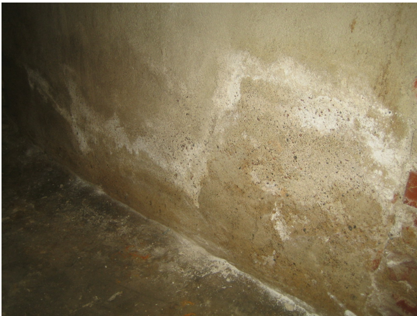
Kuva 11. Putkikanaalin rakenteiden pinnoissa on nähtävissä kosteuden kulkeutumisen mukana rakenteen pintaan kulkeutuvaa suolokerrostumaa.
