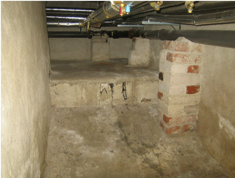
Kuva 11. Putkikanaalin rakenteiden pinnoissa on nähtävissä kosteuden kulkeutumisen mukana rakenteen pintaan kulkeutuvaa suolokerrostumaa.
