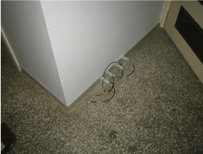
Kuva 7. Esimerkkinä väliseinän suhteellisen kosteuden mittauksesta mittapiste VS2, jossa Vaisala Oy:n valmistamat HMP44 kosteus- ja lämpötilamittapäät ovat tiivistettyinä putkitetuihin mittausreikiin..
