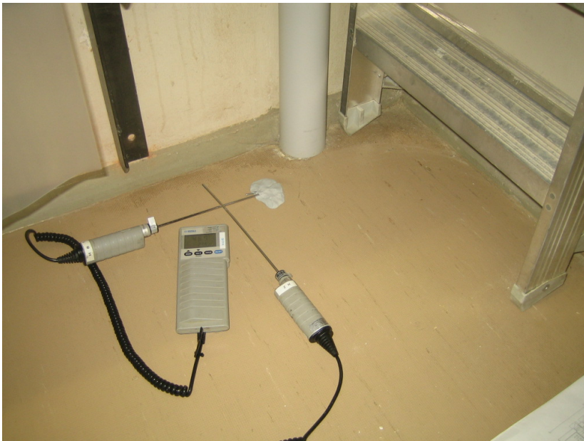
Kuva 2. Esimerkkinä viiltomittauspiste V9, jossa Vaisala Oy:n valmistama HMP42-mittapää on tiivistetty lattianpäällysteenä olleen muovimaton alle. Vaisala Oy:n valmistamalla HMP42 kosteus- ja lämpötilamittapäällä mitattiin myös vallitsevat sisäilman olosuhteet viiltomittauksen aikana.
