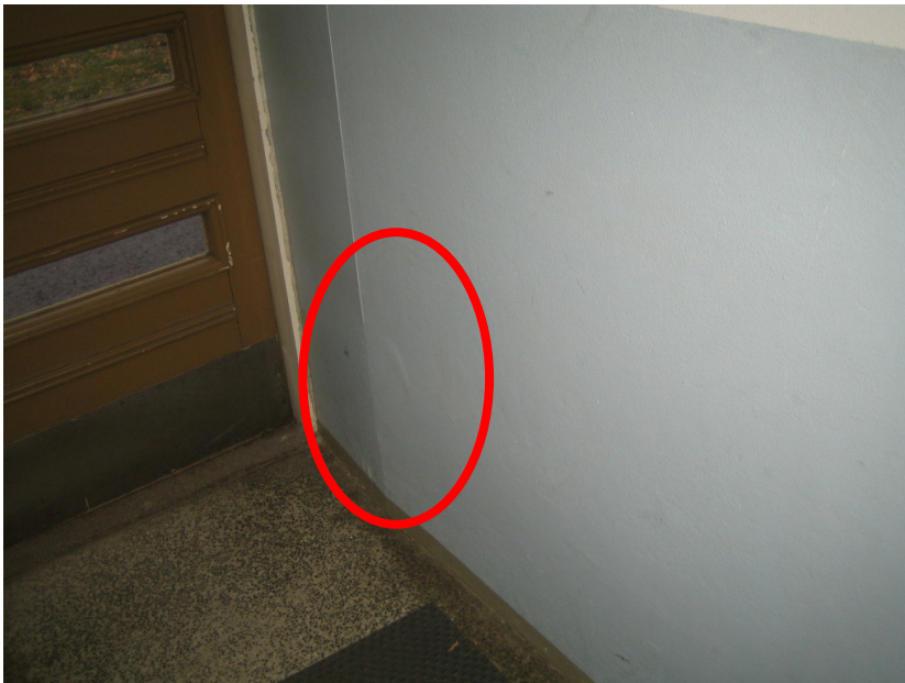
Kuva 10. Käytävän 028 ulko-oven vieressä, poikien pukuhuoneen suihkutilan kohdalla, seinän maalipinnassa on kupruilua.
