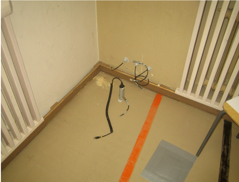
Kuva 3. Esimerkkinä liikuntasalin lattiarakenteen lämmöneristeen suhteellisen kosteuden mittapiste a, jossa Vaisala Oy:n valmistama HMP42 kosteus- ja lämpötilamittapää on tiivistetty lattian pintaan. Kuvassa on nähtävissä myös ulkoseinän suhteellisen kosteuden mittapiste US1 ja alapohjarakenteen tarkastelukohta L1 (ilmastointiteipillä tiivistetty).
