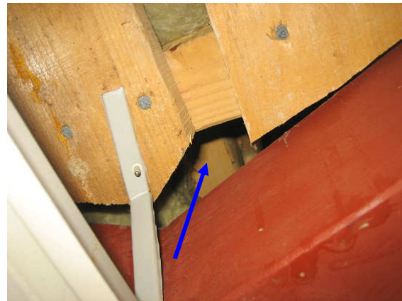
Kuva 6 Lämmöneristettä puuttuu katosta ulkoseinän vierustalta. Höyrnsulkumuovia ei ole.
