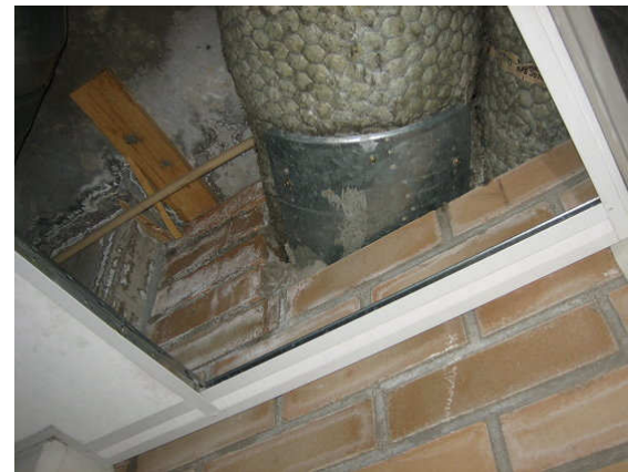
Kuva 14 TK 101:ssä on valumaveden aiheuttamia jälkiä alakattovillalevyssä ja rakenteissa.
