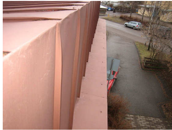
Kuva 16 Ruokasalin kohdan vesikaton rakenne ei ole räystäään osalta rakennelikkauksen mukainen. Ontelotilan tuulettumisesta ei saatu selvyyttä.
