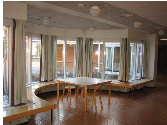
Kuva 2 Erkkerissä havaittiin mikrobivaurioon viittaavaa hajua.
