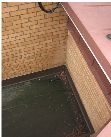
Kuva 13 Sisääntulokatos TK 101:n kohdalla. Katos kastelee ulkoseinärakenteita.
