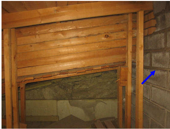
Kuva 15 Ruokasalin kohdan ontelotilaan ei ollut pääsyä. Vesikatteen ylösnoston epätiivyydestä johtuen sadevettä on päässyt tiliharkkoseinää myöten ontelotilaan.
