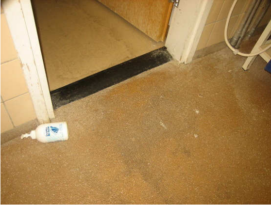
Kuva 9 Keittiön ja emännän huoneen muovikynnyksen ja hartsipinnoitteen alle voi päästä pesuvettä.
