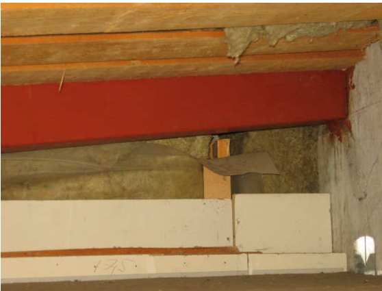
Kuva 5 Erkkerin kohdalla ei katossa ole höyrnsulkua ja seinässä em. on puutteellisesti asennettu.
