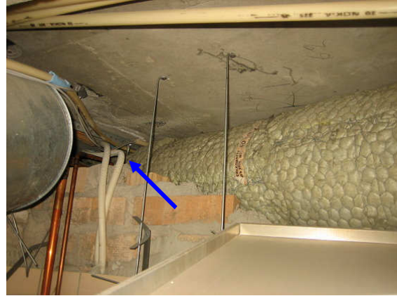
Kuva 10 Keittiö alakaton yläpuolella on ilmayhteys Aulan 106 puolelle läpivientien ja seinän yläosan kautta.
