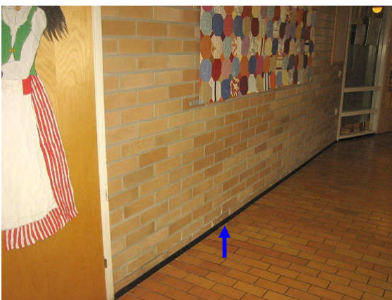
Kuva 7 Aulan ja keittiön välisen seinän alimmaisessa tiilirivissä on kosteuden aiheuttamaa härmettä.
