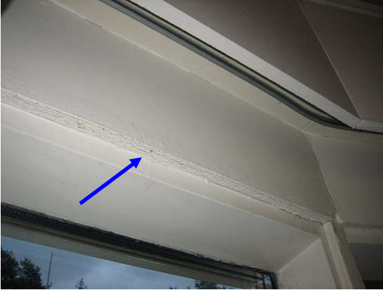
Kuva 3 Erkkerin kohdalla lastulevyssä on turpoamisjälkiä.
