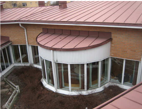
Kuva 1 Erkkeri ulkoa päin. Syksytorven vieressä on laudan alaosassa mikrobivaurio. Vesikaton alusta ei tuuletu.
