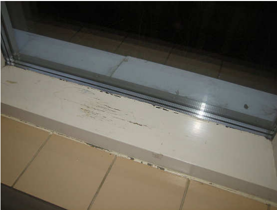
Kuva 11 Ruokalasalini ikkunarakenteen alakarmien pinoissa on vanhoja kosteuden aiheuttamia jälkiä.
