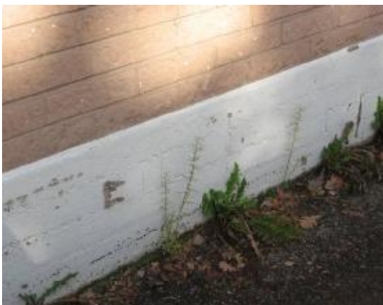
Sokkeleiden maalipinnat olivat kuluneita.
