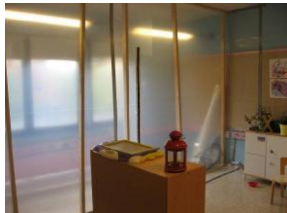
Osa päiväkodin käytössä olevista tiloista on ali-paineistettu vaurioiden vuoksi.
