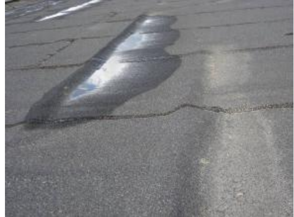
Katolla oli runsaasti mm. poimuuntumista ja muita epäkohtia.
