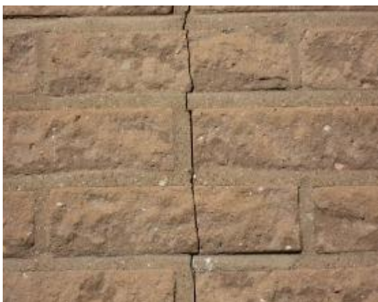
Tiilipinnoissa havaittiin kuluneisuutta ja halkeilua melko paljon.
