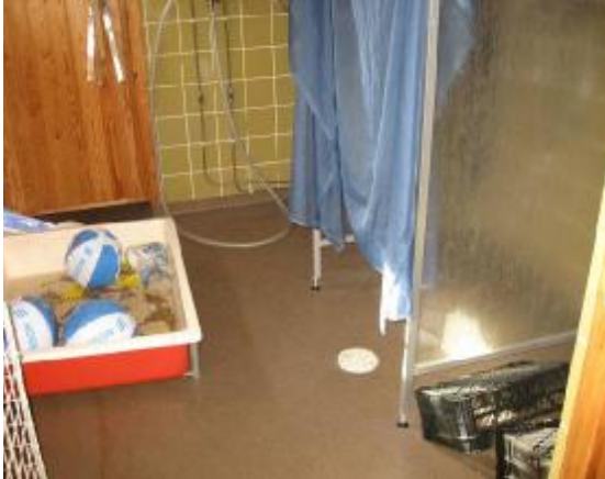
Toisen kerroksen suihku- ja saunatilat olivat välttävässä kunnossa.
