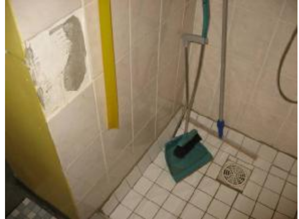
WC- ja muut märkätilat olivat yleisesti kuluneita ja välttäväkuntoisia.
