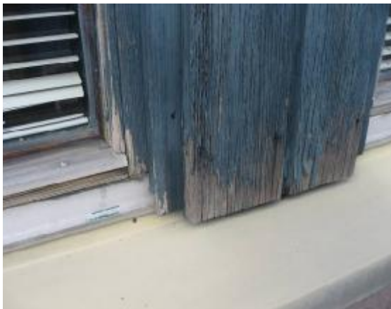
Ikkunoiden ulkopuolelta maalipintoineen olivat yleisesti kuluneita.
