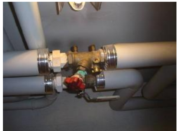
Linjasäätöventtiileissä näkyi sinkinkatota.
