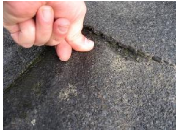
Kermien saumoissa havaittiin paikoin akuuttia tiivistystarvetta.
