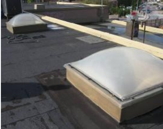
Paikkauksia on tehty. Talon kattopinnat ovat kolmessa eri tasossa.
