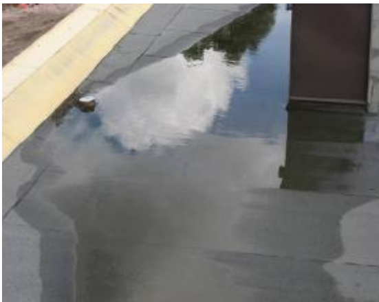
Kattokaivo oli tukkeessa. Sihdit tulee käydä puhdistamassa säännöllisesti.
