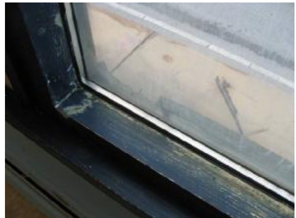
Asematien puoleisella sivulla 2. kerroksen ikkunoiden ulkopuolisissa osissa oli pahoja lahovaurioita.
