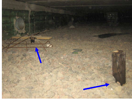
Kuva 8 Mikrobivaurioitunutta putavaraa A-osalla.
