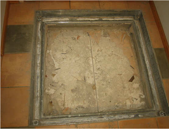
Kuva 1 B-osan lattialuukku on puuha-/ vers- tastilassa. Luukussa oli vielä jäljellä polystyreenilevyeristeet.
