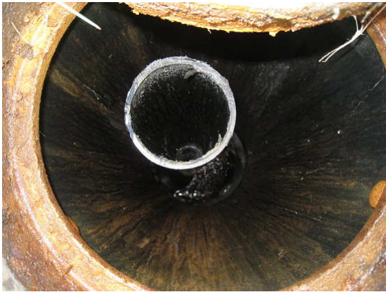
Kuva 21 Tarkastuskaivo B-osan eteläkulmassa. Vettä virtaa Metsotien suunnasta.
