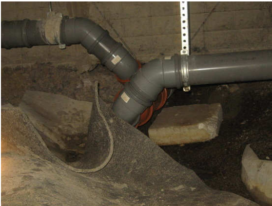
Kuva 9 A-osalla olevassa viemärikaivannossa on palkin alituskohdalla vapaata vettä.
