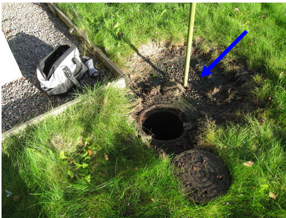
Kuva 17 Vesikattovedet ohjataan kivipesiin, joiden toimivuudesta ei saatu varmuutta.
