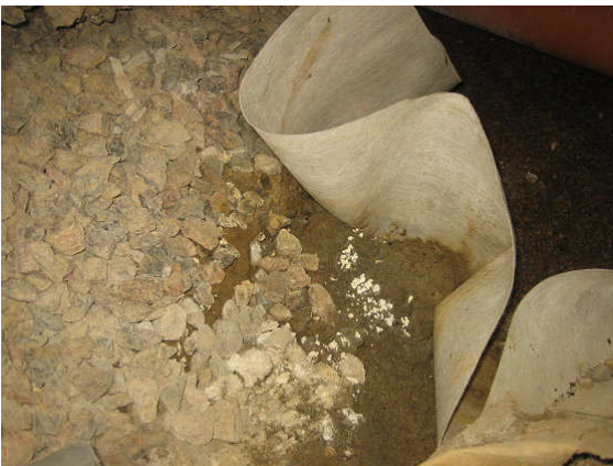
Kuva 11 Viemärikaivannon kohdalla paljaana olevan saveen pinnalla on kasvustoa.
