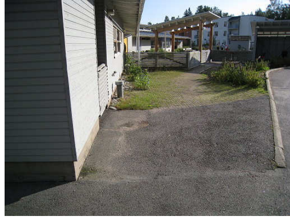
Kuva 20 Maanpinta viettää rakennukseen päin luoteiskulmassa.
