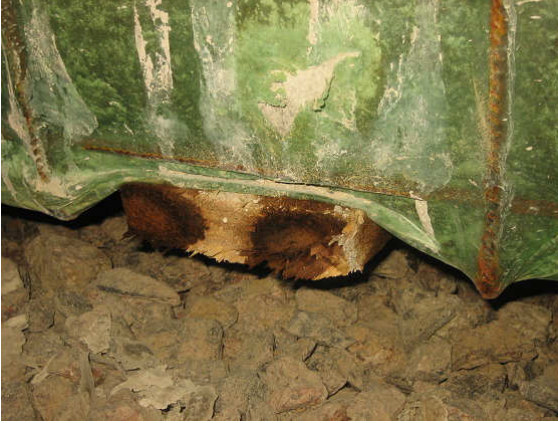
Kuva 7 Valumuottien alasidepuut on jätetty paikoilleen ja päät ovat mikrobivaurioituneet.
