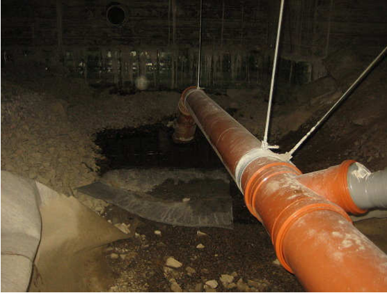
Kuva 13 A-osalla lähellä B-osan taitekohtaa on viemärikaivannon pohjalla vapaata vettä noin anturalinjan korkeudella.
