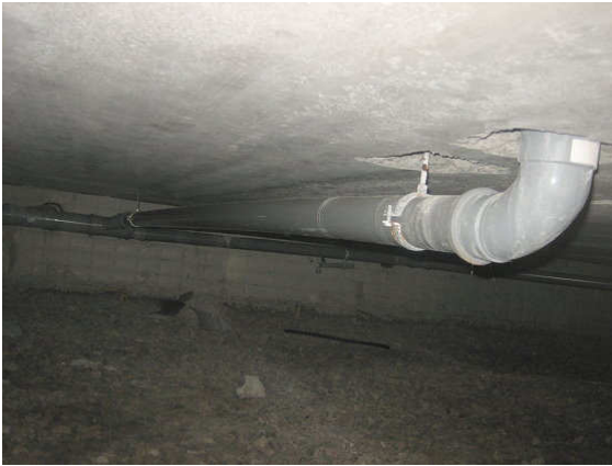
Kuva 15 Viemäri kaataa väärään suuntaan.
