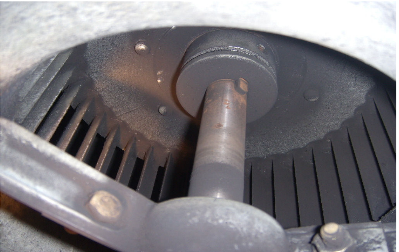
KUVA 12. Yleiskuva poistoilmapuhaltimesta PF 2.
