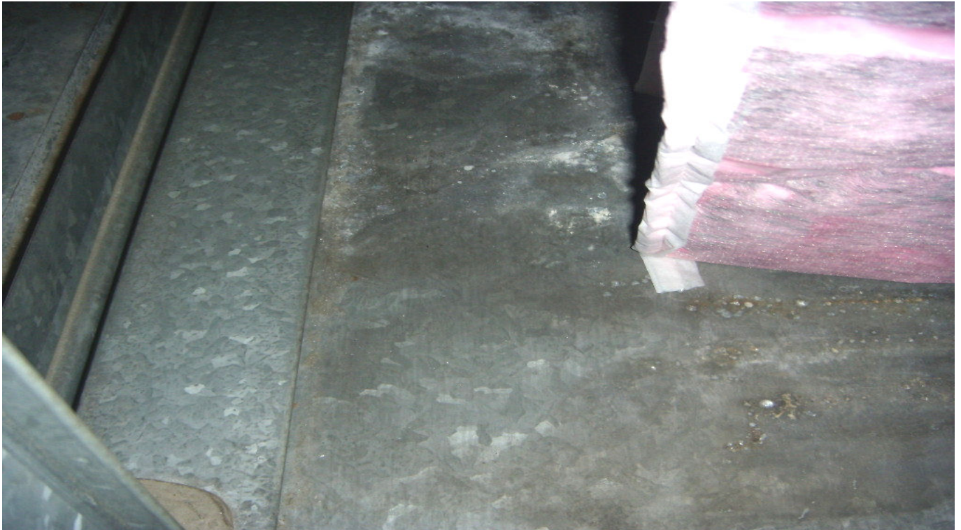
KUVA 3. Yleiskuva TF 1:n tuloilmakoneen kammiosta.
