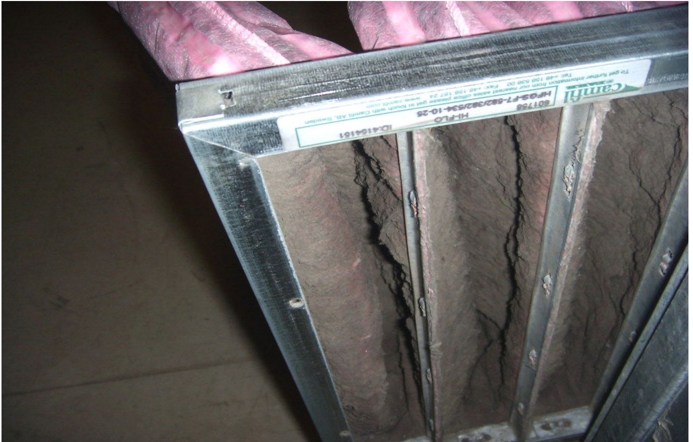
KUVA 13. Yleiskuva tuloilmakoneen suodattimista TF 3.
