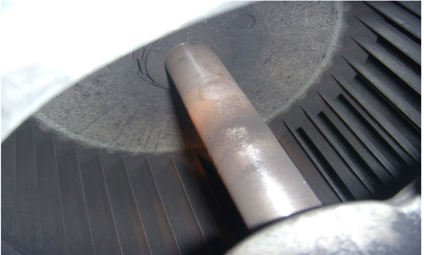
KUVA 17. Yleiskuva poistoilmapuhaltimesta PF 3.
