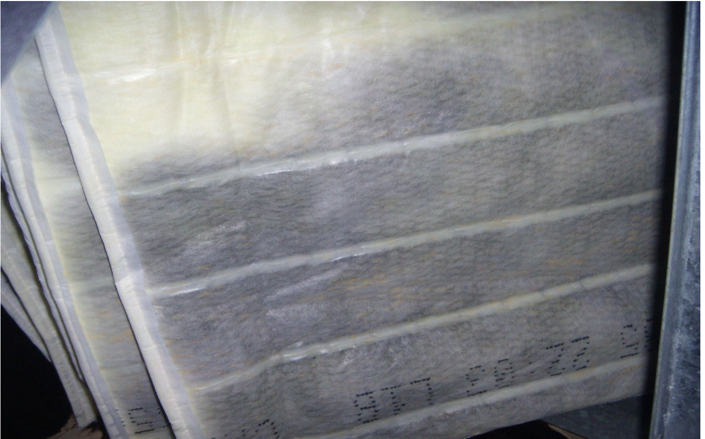
KUVA 11. Yleiskuva poistoilmakoneen suodattimista PF 2.
