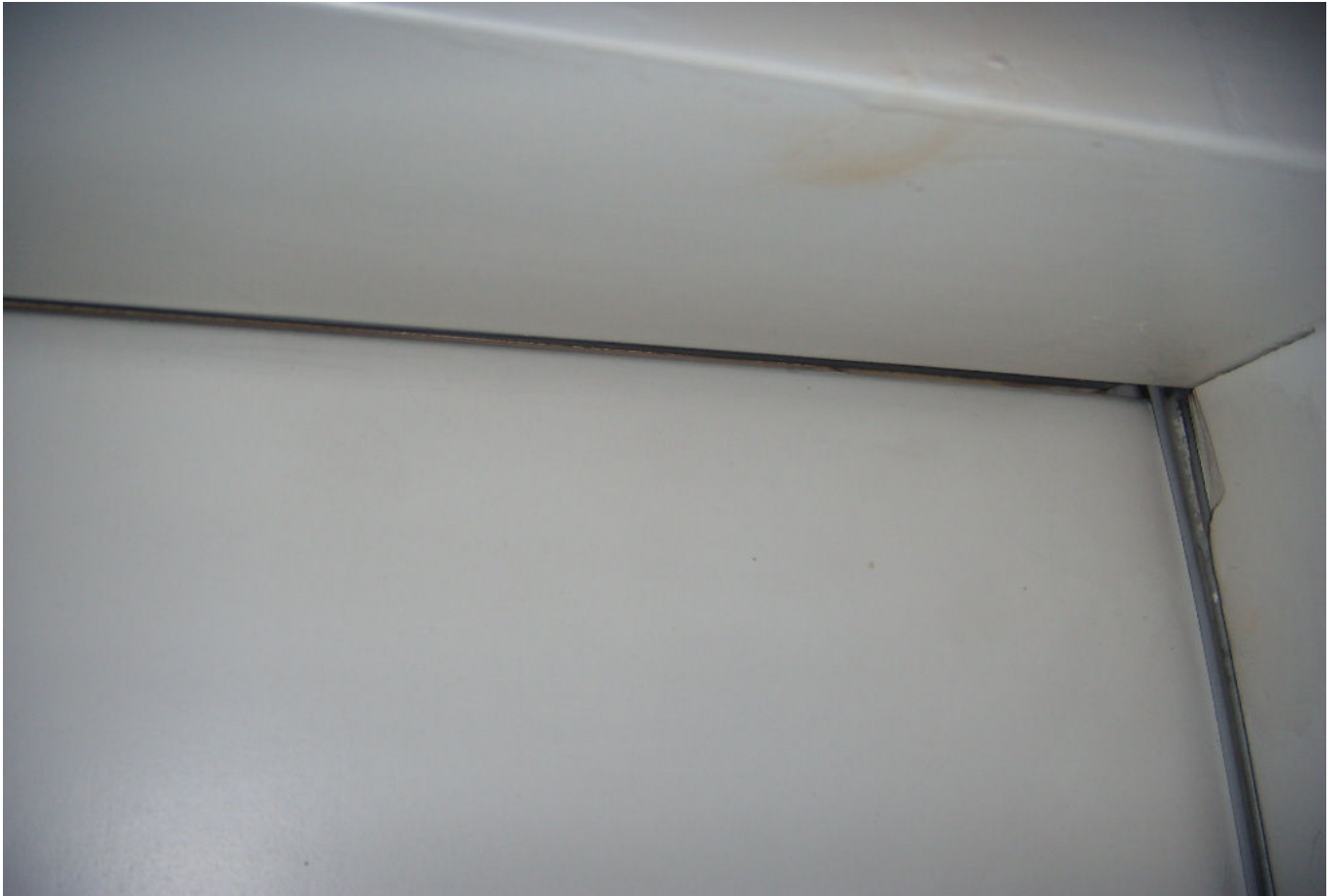
KUVA 21. Yleiskuva asiakashuoneen n: o 103 parvekkeen ovesta, joka ei ole tiivis.
