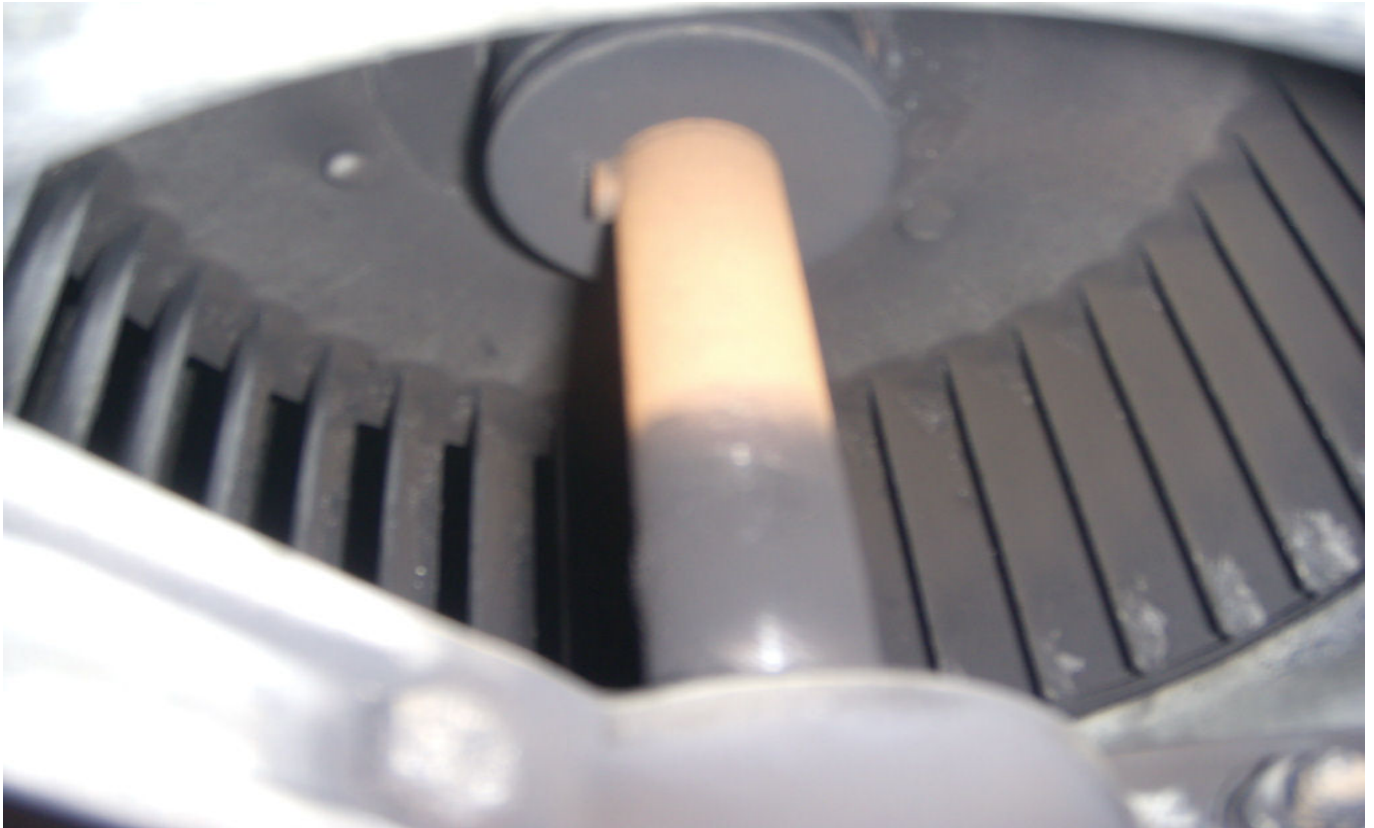
KUVA 15. Yleiskuva tuloilmapuhaltimesta TF 3.
