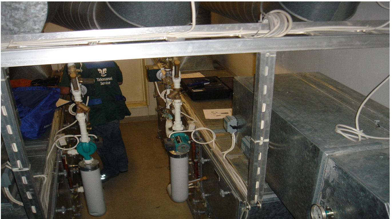
KUVA 2. Yleiskuva IV- konehuoneesta.
