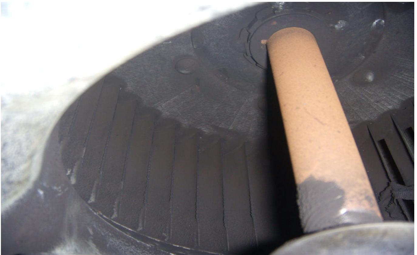
KUVA 8. Yleiskuva tuloilmapuhaltimesta TF 2.
