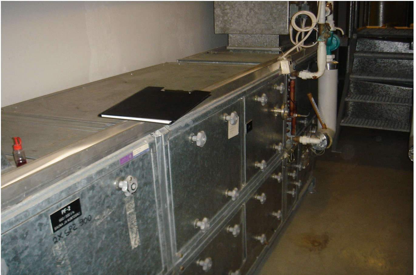
KUVA 1. Yleiskuva IV- konehuoneesta.
