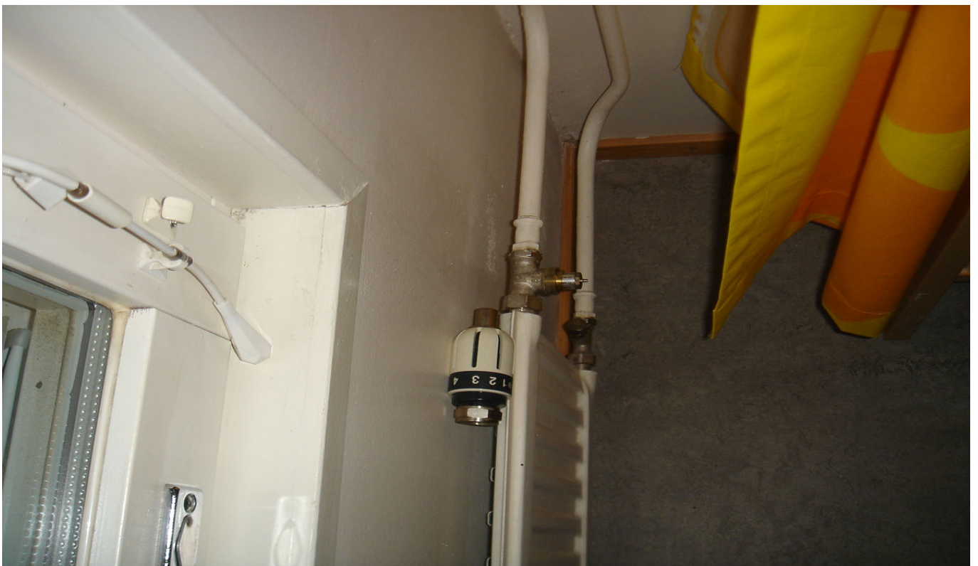
KUVA 22. Yleiskuva asiakashuoneen lämpöpatterista.
