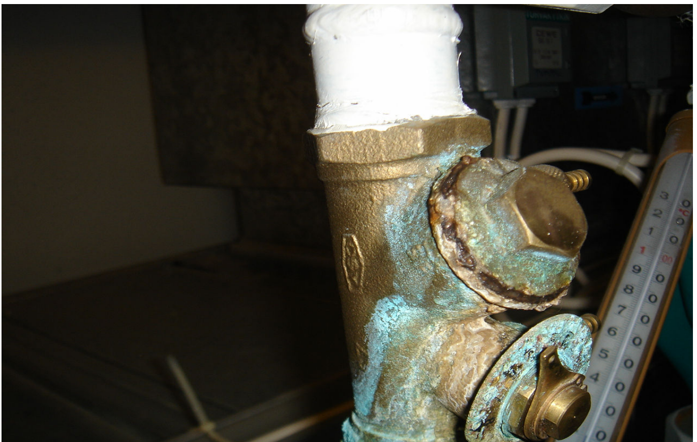
KUVA 10. Tuloilmakoneen TF 2 lämpöpatterin linjasäätöventtiilin laippaliitos vuotaa.
