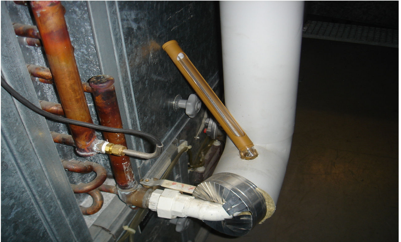
KUVA 9. Tuloilmakoneen TF 2 lämpöjohtoverkoston lämpömittari on rikki.
