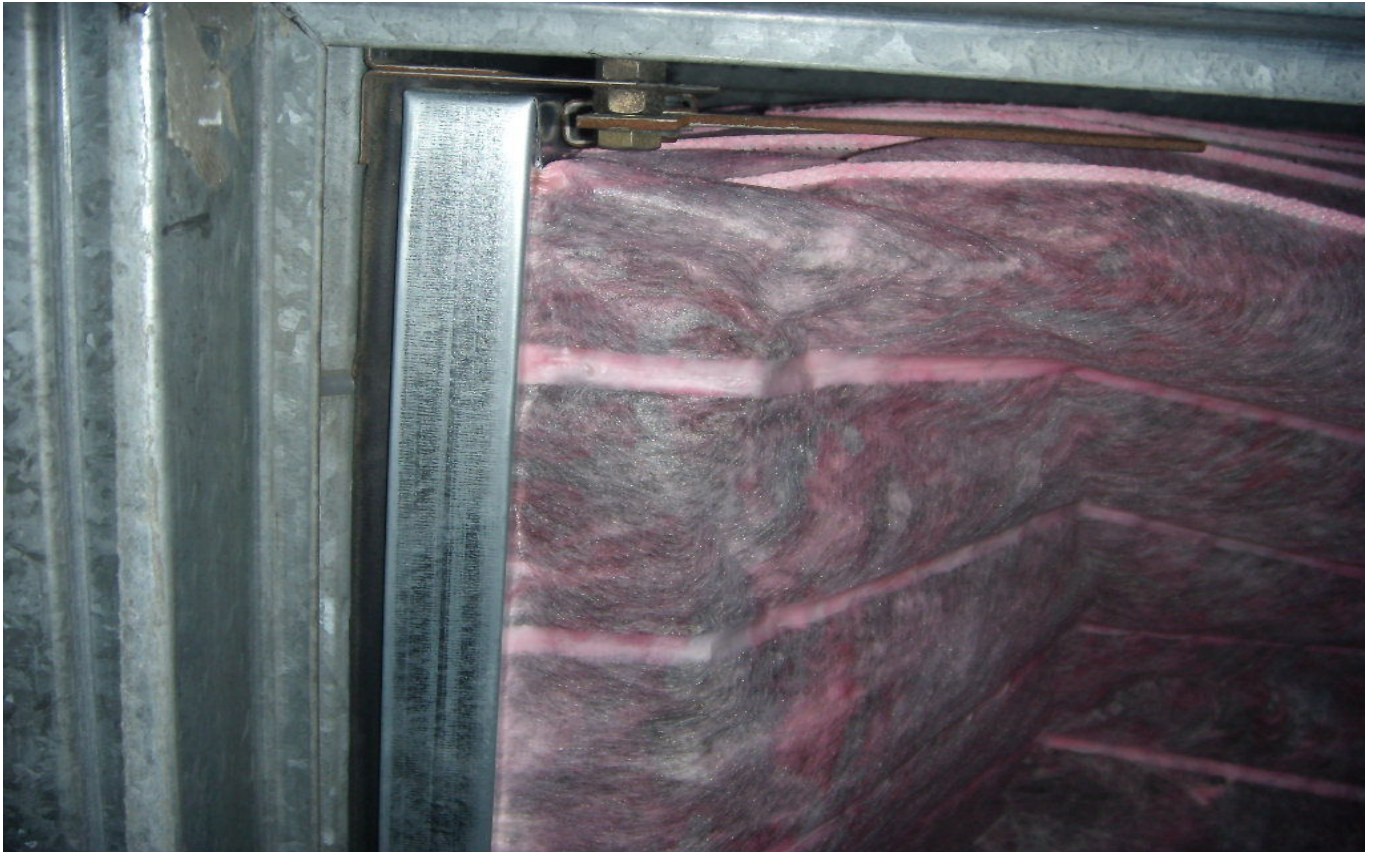
KUVA 7. Yleiskuva tuloilmasuodattimesta ja suodatinkehikosta TF 2.
